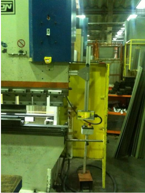
Figura 11. Vista da proteção lateral da prensa + AKAS em funcionamento. Fonte: O autor
