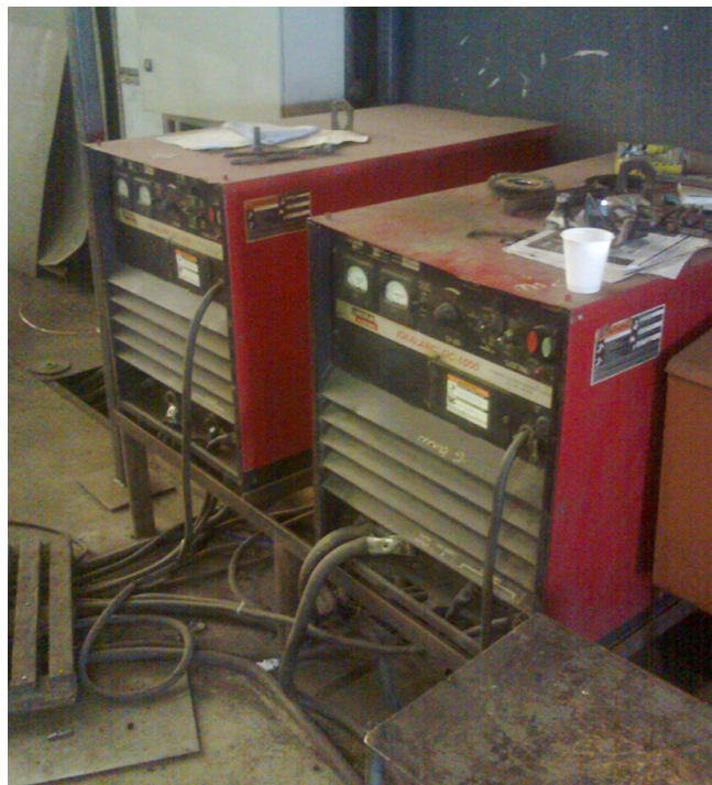
Figura 9 – Equipamentos elétricos (fontes de soldagem).
