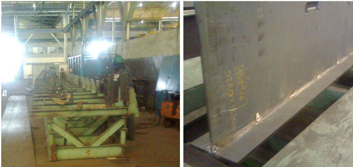
Figura 6 – Gabarito de pré-montagem no local de soldagem com Eletrodo Revestido. Ausência de exaustor local para captação de fumos metálicos.
