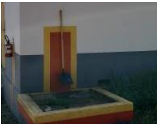
Figura 7: Caixa de areia para combate à pequenos incêndios no depósito 1. Fonte: Autoria própria (2019).
