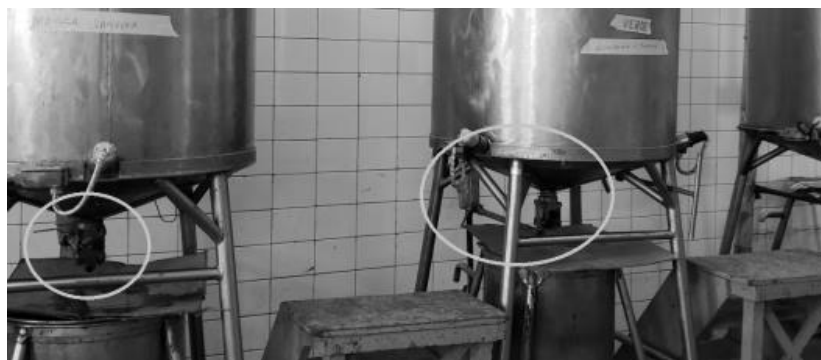
Figura 14: Alimentação de vapor de segurança nas válvulas dos tanques de armazenamento. Fonte: Autoria própria (2019).
