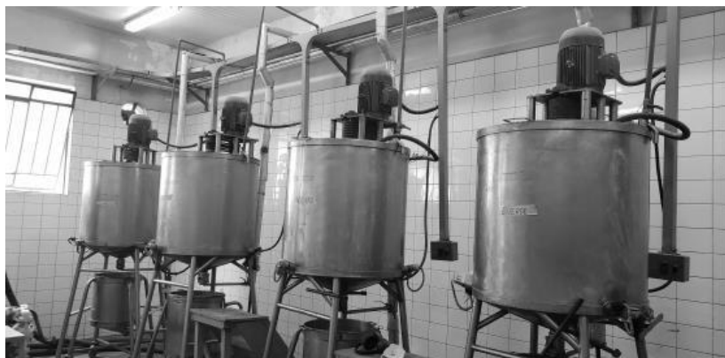
Figura 13: Tanques de armazenamento de massa de encabeçamento. Fonte: Autoria própria (2019).
