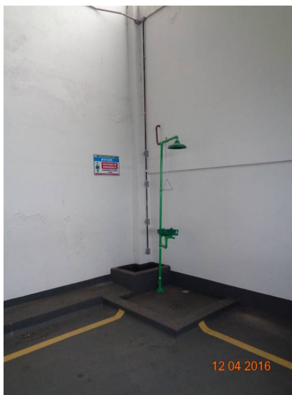
Figura 12 - Lava-olhos e chuveiro de emergência Fonte: O Autor.
