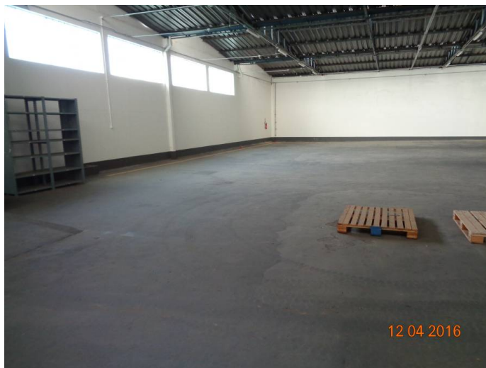
Figura 14 - Piso sem marcações de rota de fuga
