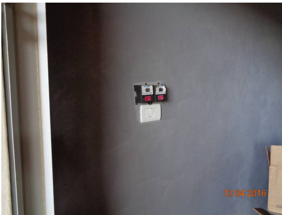
Figura 19 - Interruptor dentro do depósito Fonte: O Autor.
