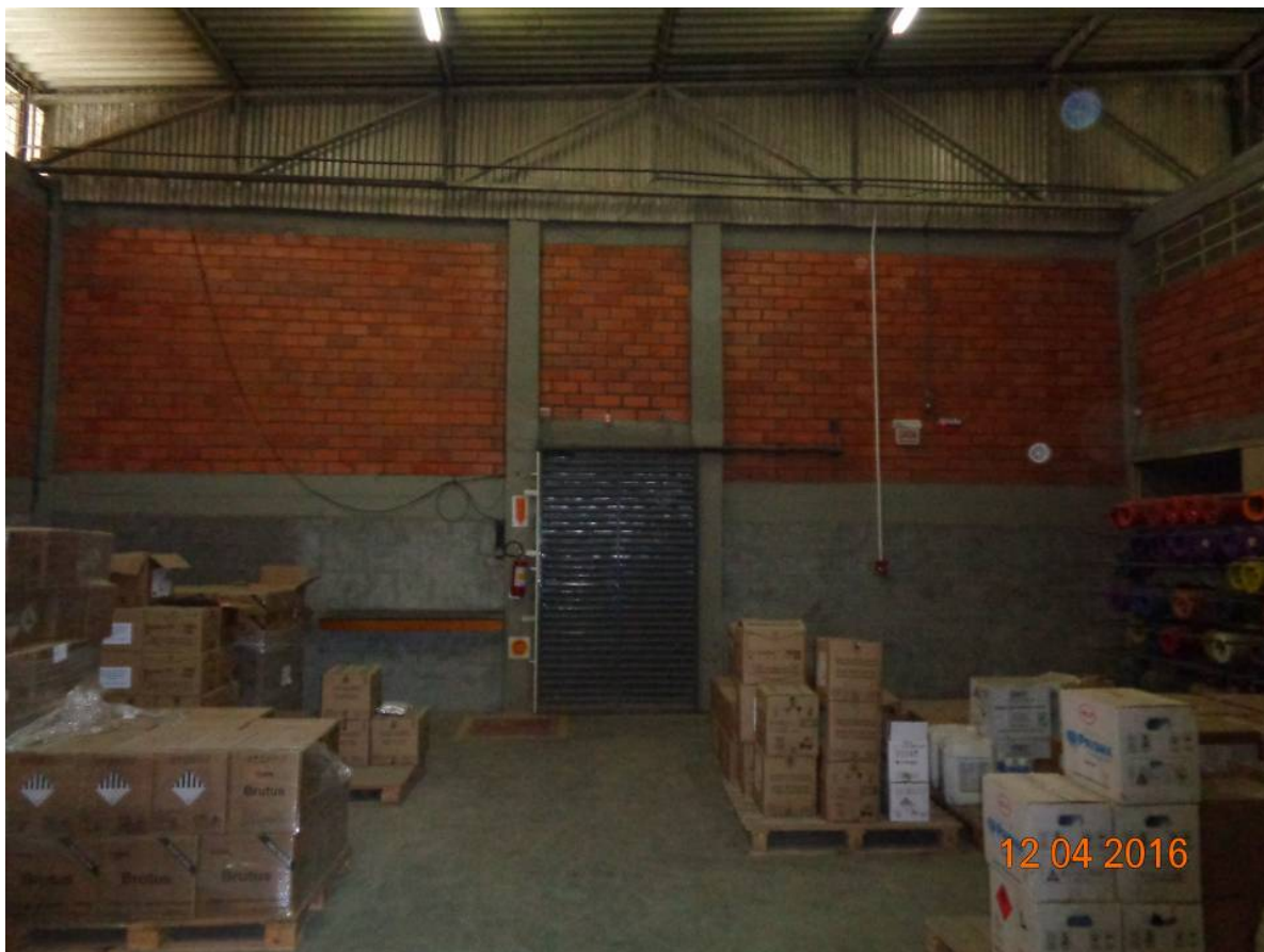
Figura 9 - Fiação elétrica improvisada Fonte: O Autor.
