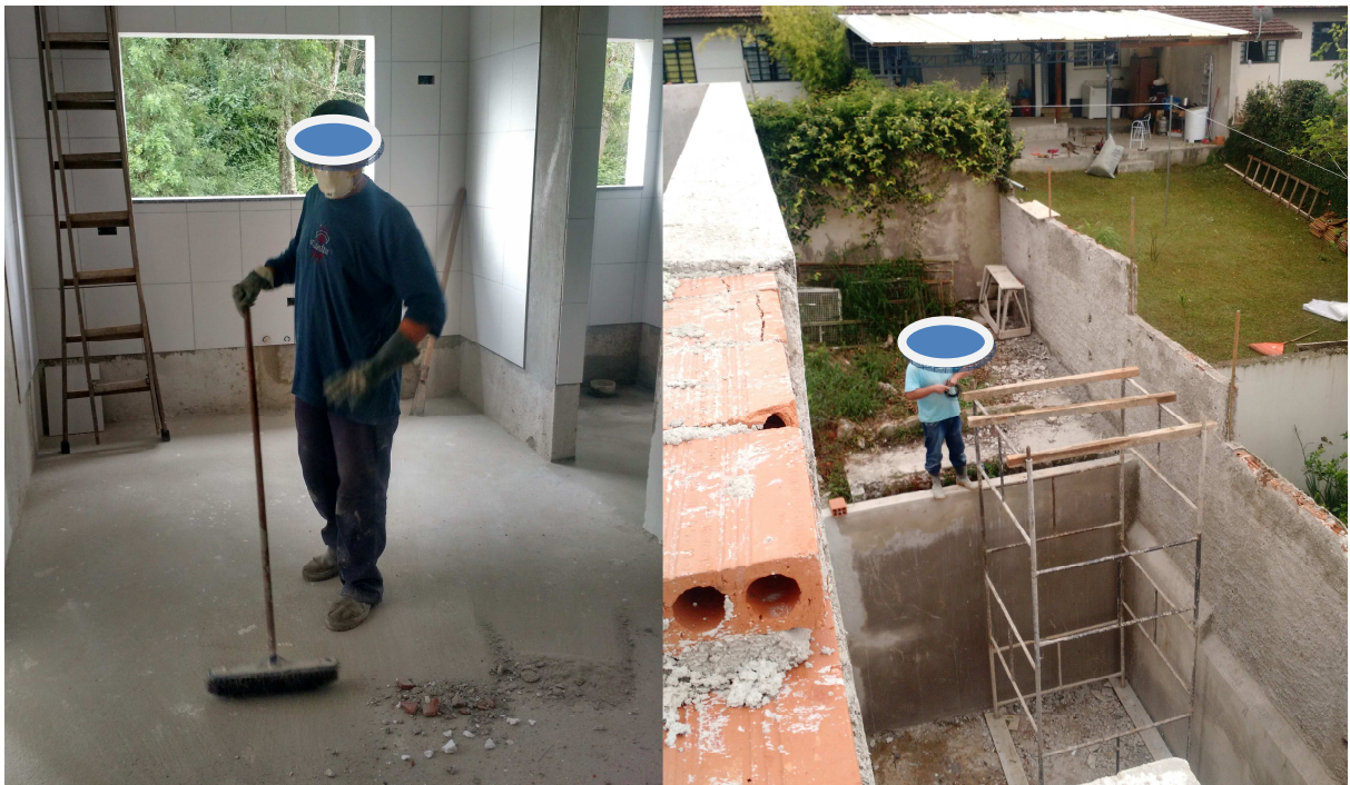
Figura 9- Falta de EPI / Andaimés irregulares.
