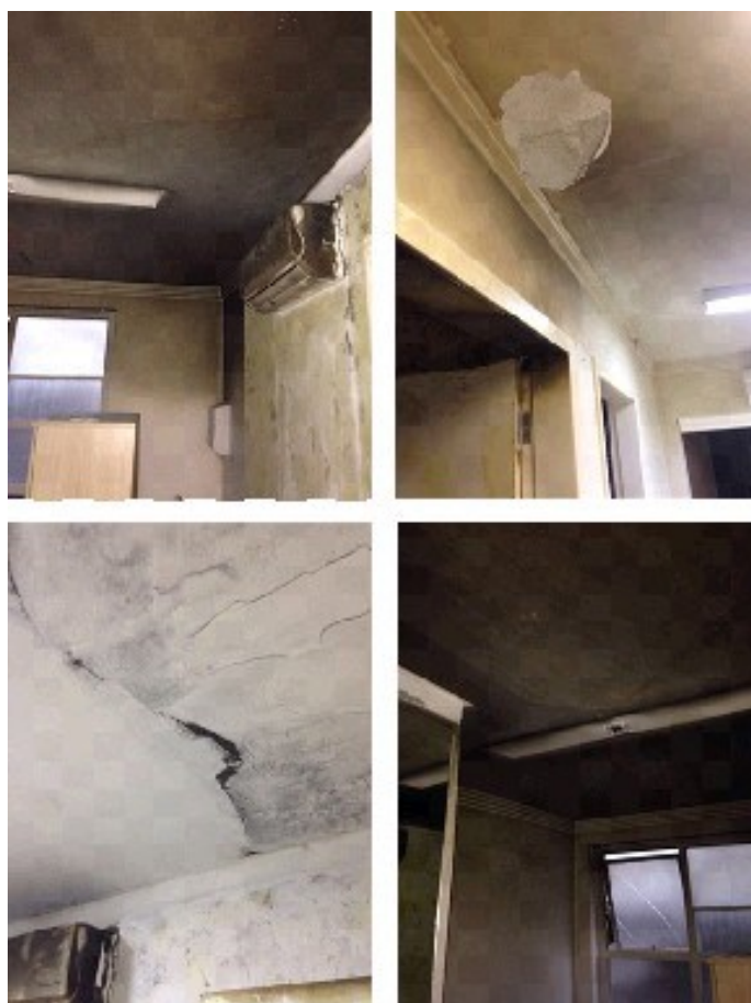
Figura 11 – Situação pós princípio de incêndio.
