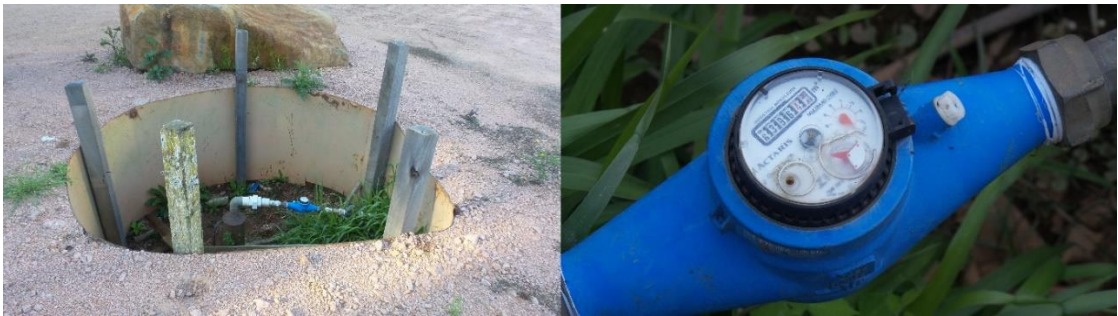
Figura 10 – Poço Artesiano – Local de captação da água e hidrômetro
