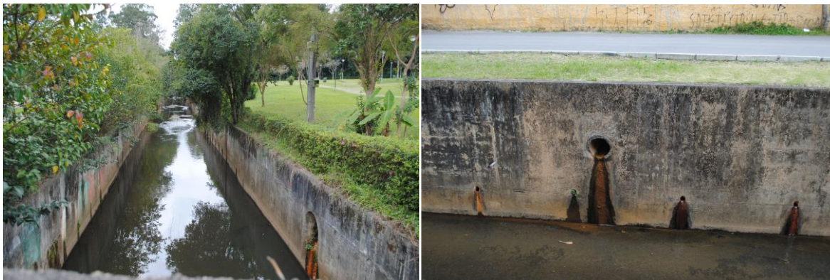
Figura 10 - TUBULAÇÃO DE ESCOAMENTO DE ÁGUAS PLUVIAIS Fonte: Autoria própria (2015)
