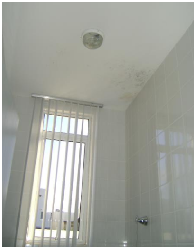
Fotografia 10 - Teto banheiro dos funcionários Fonte: Autoria própria
