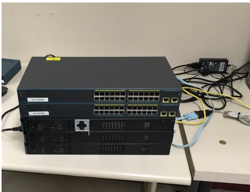
Figura 11 - Switch e Roteador Cisco na bancada do Laboratório
