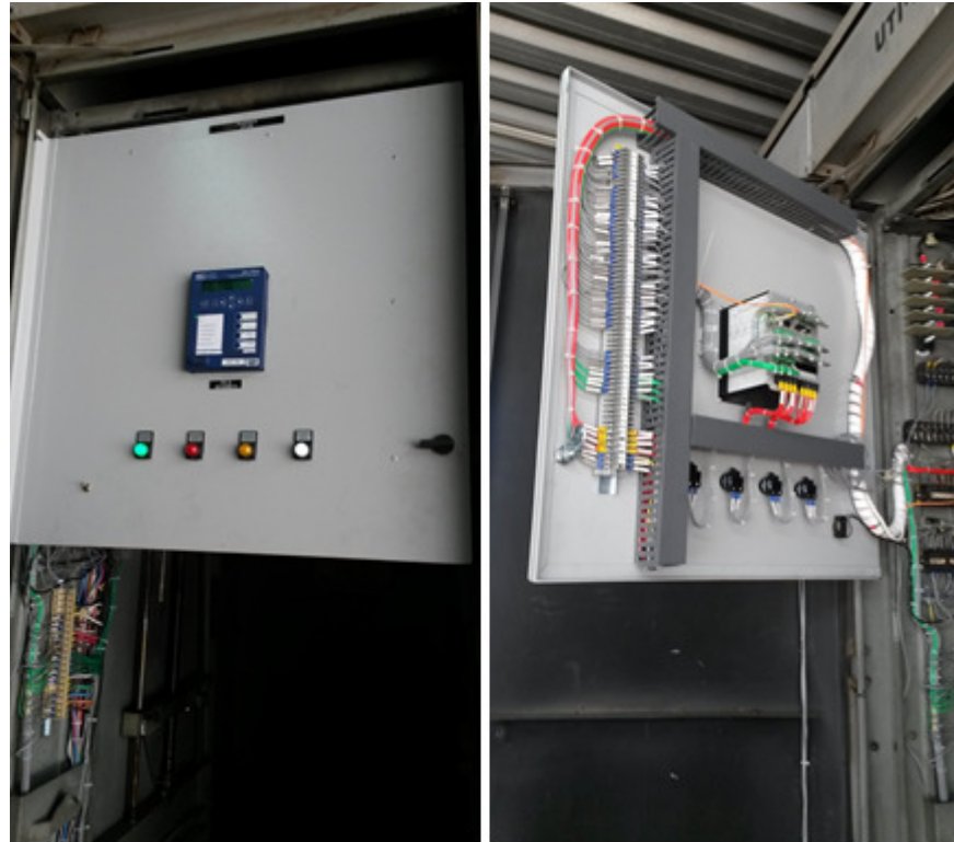
Figura 6 – Cubículo com relé de proteção digital. Fonte: AES Eletropaulo.
