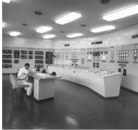
Figura 1 – Sala de Controle de uma Subestação de Energia Convencional. Fonte: AES Eletropaulo.
