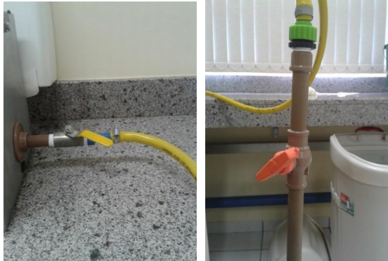
Figura 24 - Válvulas de controle de altura da água. Fonte: Autoria própria.
