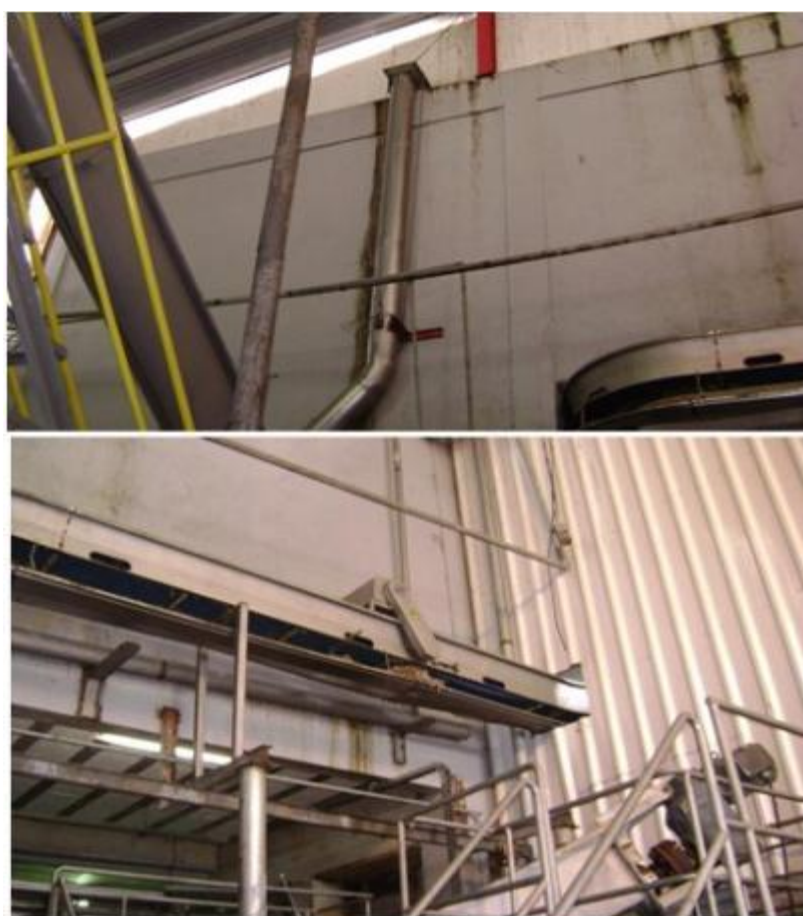
Figura 6: Esteira e tubulação aérea Fonte: Autoria própria
