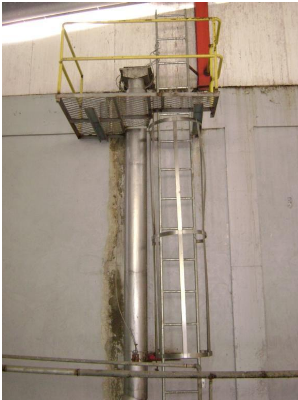
Figura 28: Escada marinheiro de acesso à plataforma menor Fonte: Autoria própria
