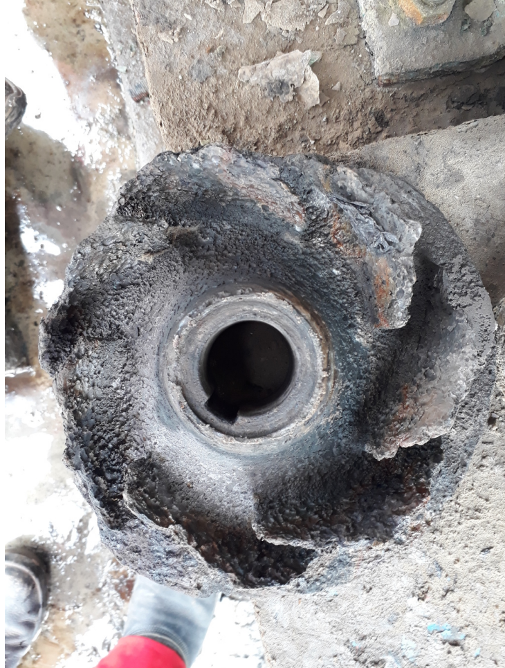
Fotografia 1 – Rotor da bomba centrífuga
