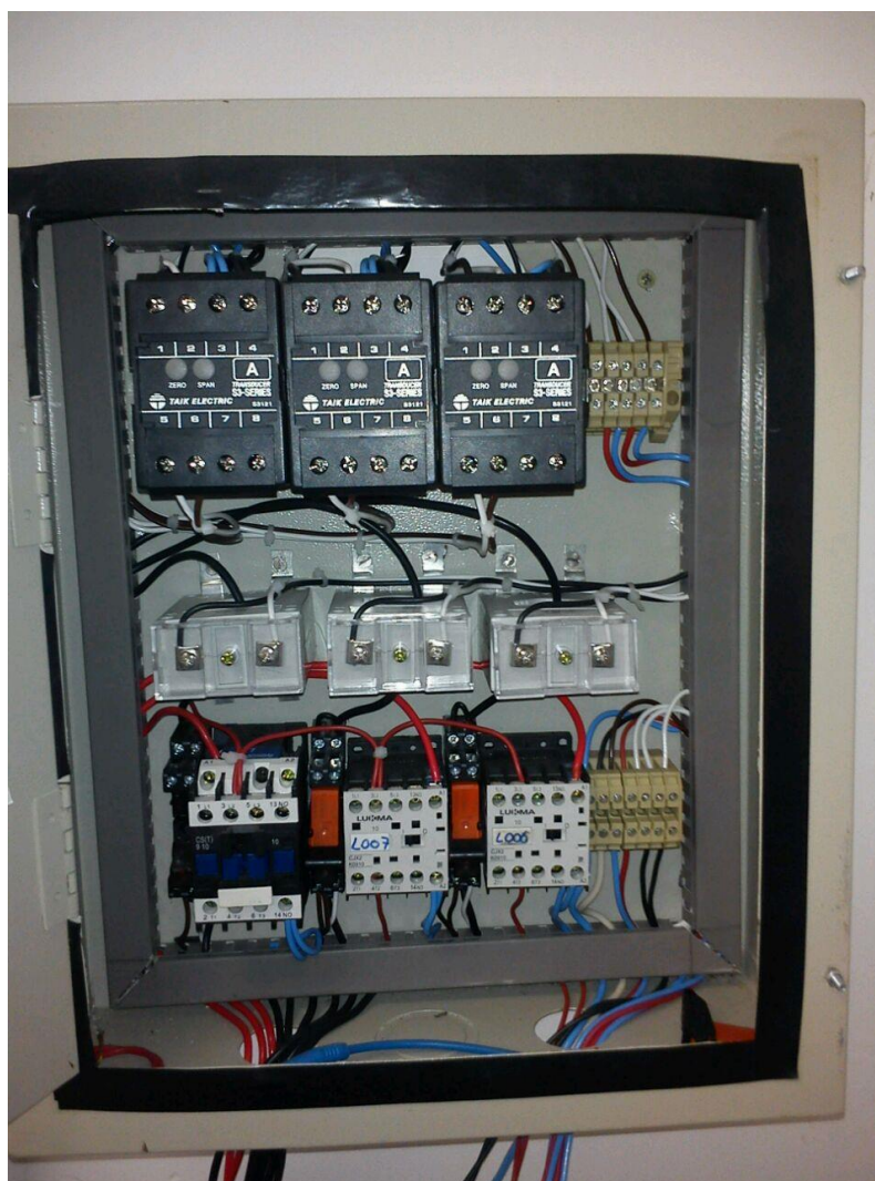
Figura 26: Quadro de aquisição de dados. Fonte: Autoria própria
