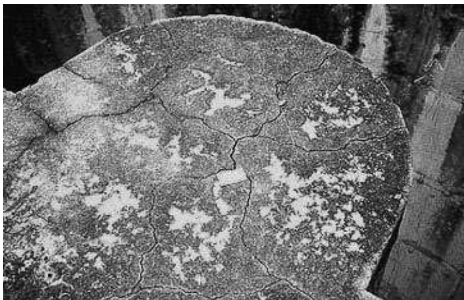
Figura 2 – Topo de pilar de vertedouro de barragem afetado por RAA. Fonte: Lima (2009).
