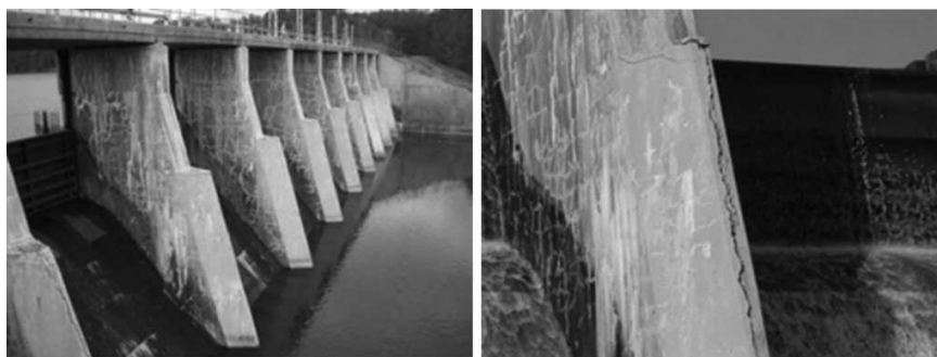
Figura 3 - Estrutura afetada pela reação álcali-silica nos Estados Unidos.
