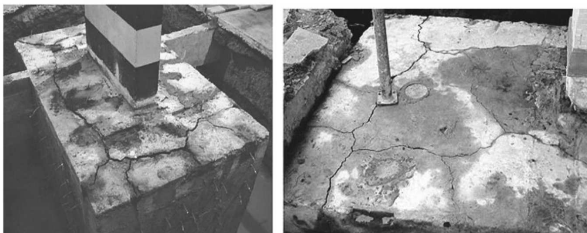
Figura 4 - Estrutura afetada pela reação álcali-silicato em Pernambuco.
