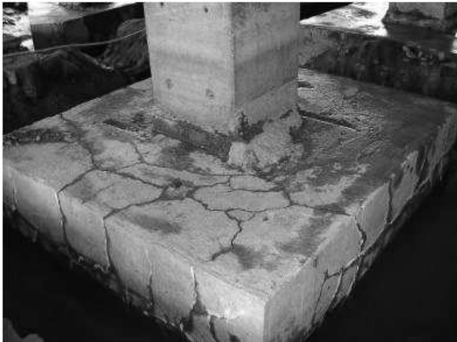
Figura 1 – Bloco de fundação com padrão de fissuração típico de RAA Fonte: Nogueira (2010).
