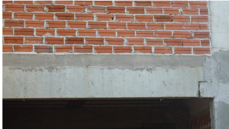
Figura 3 - Seção transversal da viga concretada totalmente com a ligação com a laje
