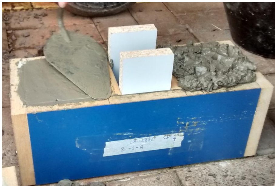
Figura 12 - Disposição da fôrma das peças compostas durante a execução da primeira etapa de concretagem Fonte: O autor
