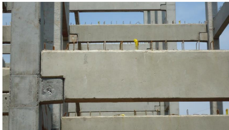
Figura 2 - Seção transversal da viga concretada parcialmente com exposição da armadura da seção transversal
