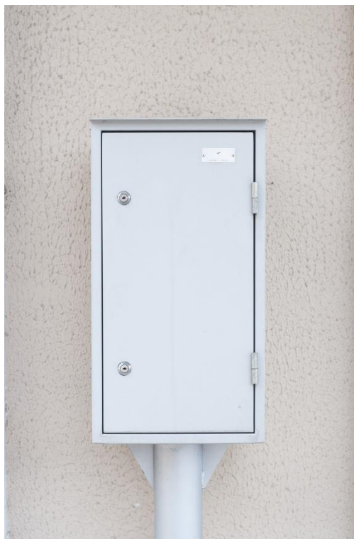
Figura 26 - Controlador semafórico instalado no cruzamento entre a Avenida Tupi e a rua Itabira.
