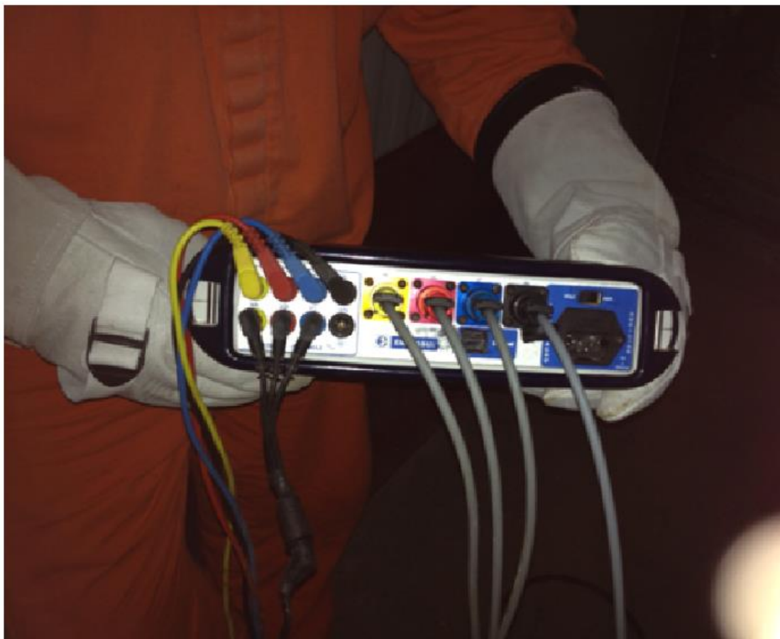
ANEXO D: Instalação no campo analisador de energia RE6000 Embrasul. Fonte: Autoria própria.
