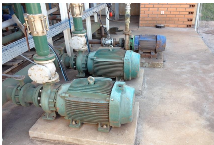
Figura 1: Máquinas de fluxo do sistema de higienização atual. Fonte: Autoria própria.
