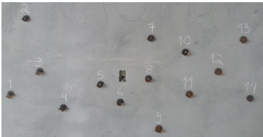
Figura 32 - Pastilhas coladas na parede Fonte: Autoria própria (2017).
