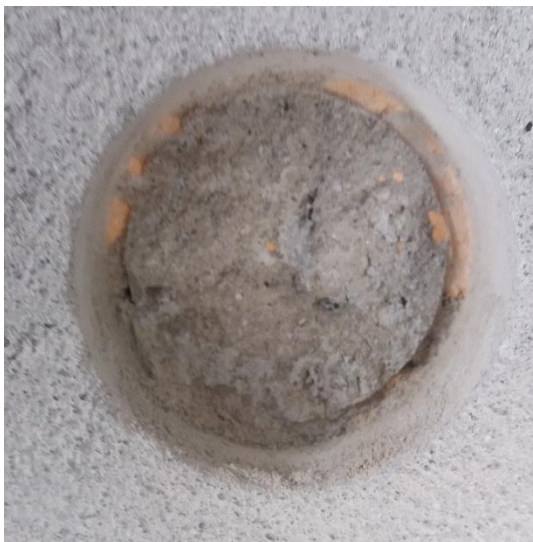
Figura 37 - Rompimento no chapisco Fonte: Autoria própria (2017).
