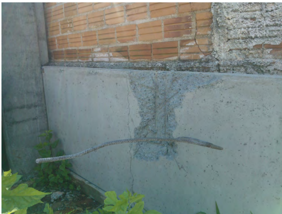
Figura 44: Ruptura da alça de içamento de uma placa pré-moldada da empresa B Fonte: Autoria Própria.
