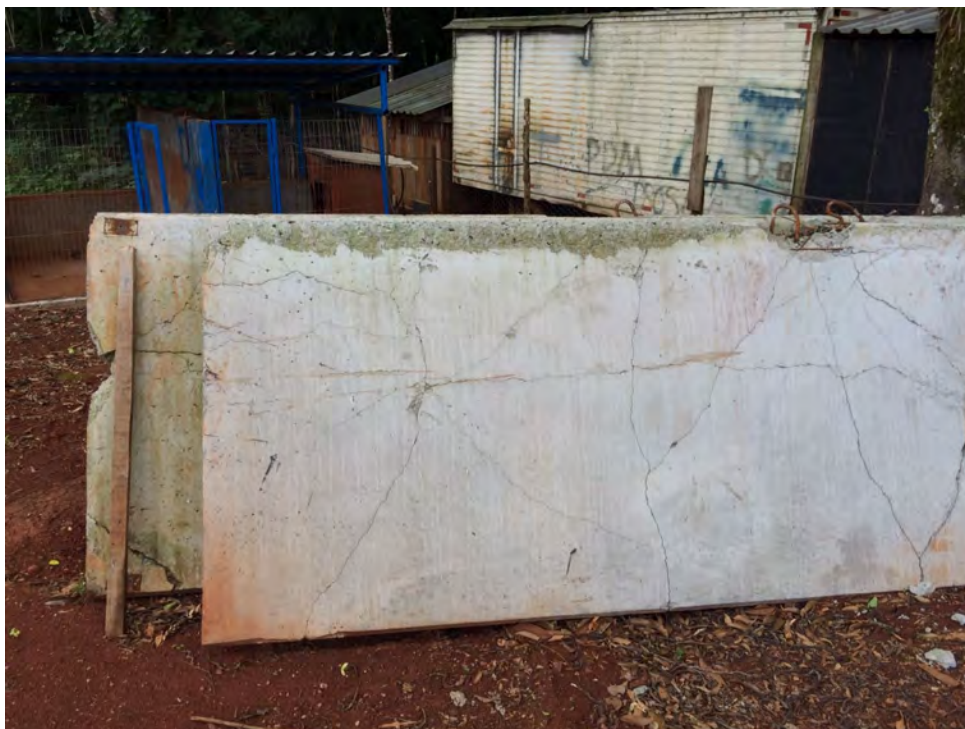
Figura 42: Trincas em placa pré-moldada de vedação Fonte: Autoria Própria.
