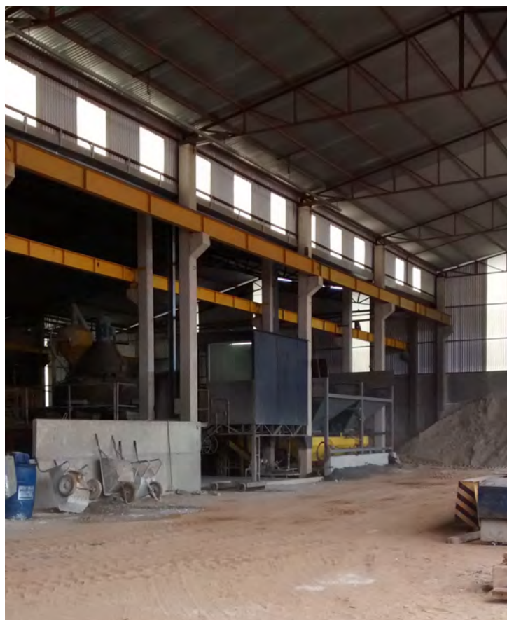
Figura 28: Local de preparação do concreto utilizado na pré-moldagem da empresa A Fonte: Autoria Própria.
