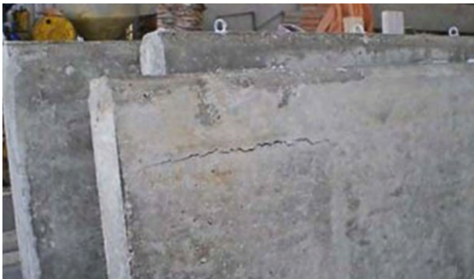
Figura 40: Fissuras provenientes do processo executivo das placas de vedação
