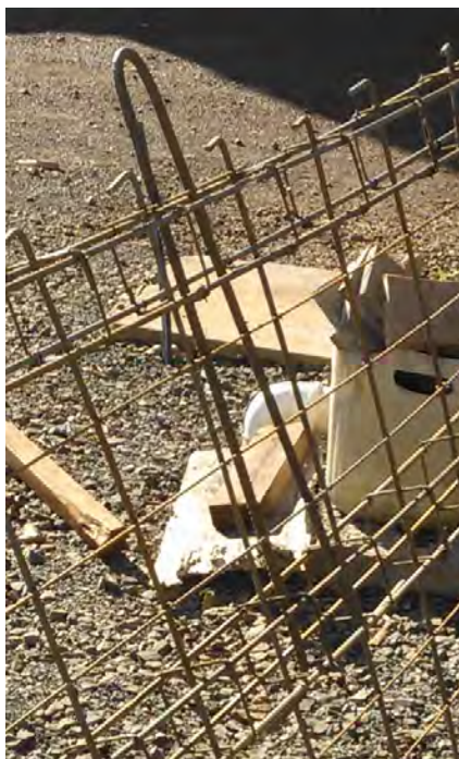
Figura 21: Detalhe de armadura e alça para painel da empresa B Fonte: Autoria Própria.
