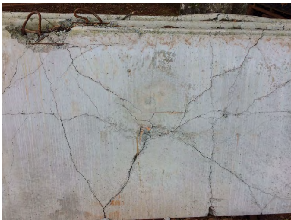
Figura 43: Placa inutilizada por patologias oriundas do mau dimensionamento dos sistemas de elevação Fonte: Autoria Própria.
