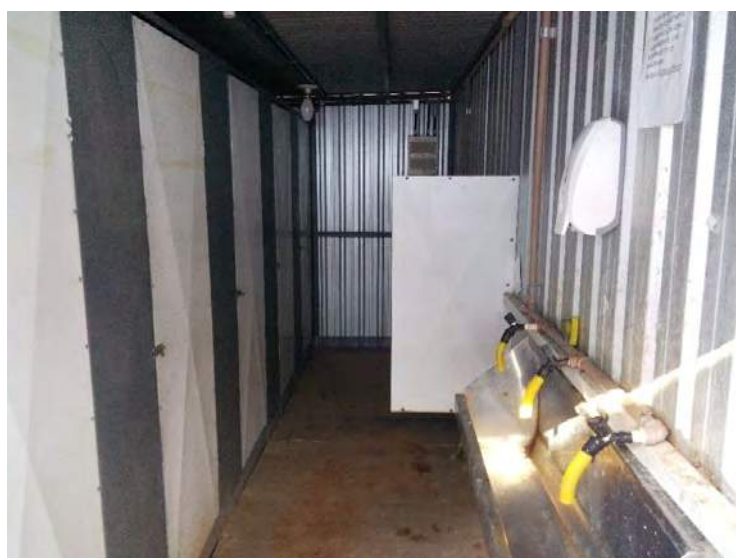
Figura 9 – Banheiro em container. Fonte: Autoria própria (2015).
