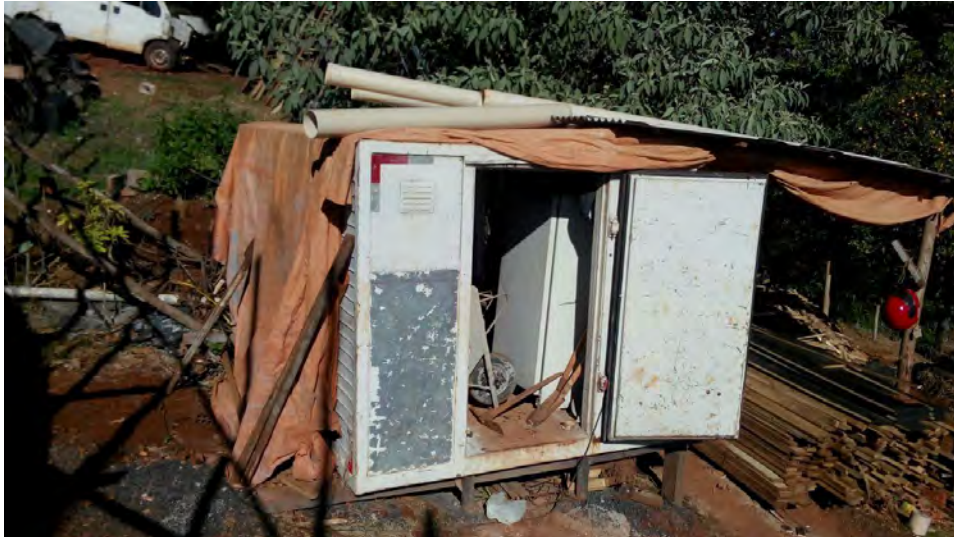
Figura 5 – Câmaras frigoríficas utilizadas no canteiro de obras. Fonte: Autoria Própria (2015).
