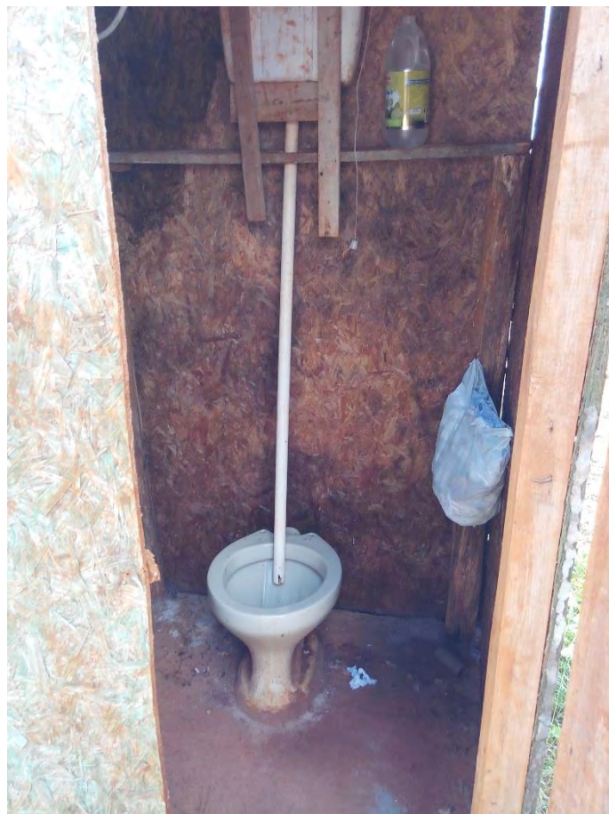
Figura 8 – Banheiro no canteiro de obras. Fonte: Autoria Própria (2015).
