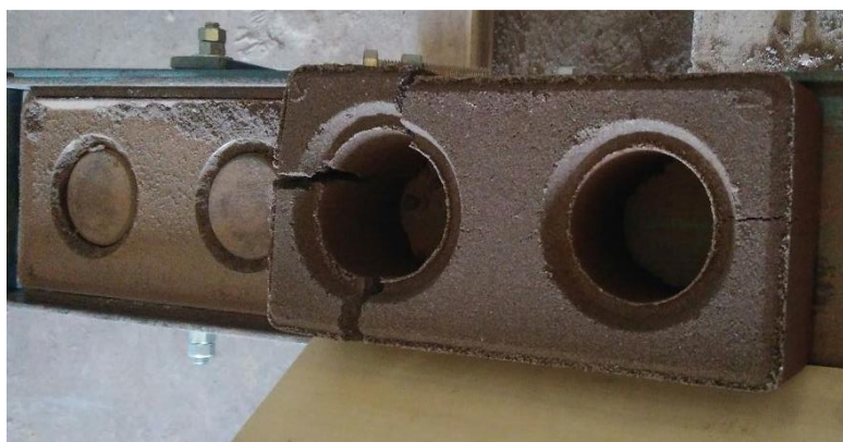
Figura 30 - Bloco moldado rompido no mesmo ponto
