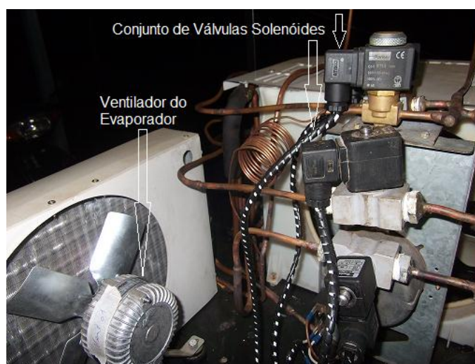
Figura 21: Arranjo das válvulas solenóides e do ventilador do evaporador.
