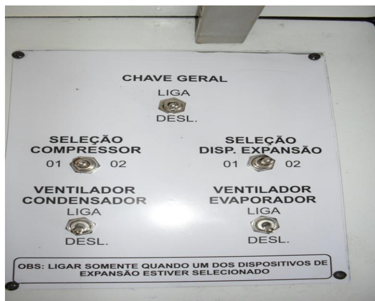
Figura 20: Painel de comando.
