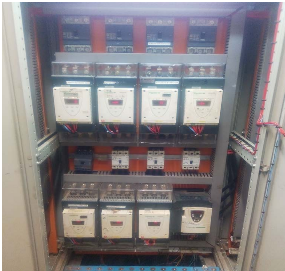
Figura 16: Painel 4 depois da readequação Fonte: própria
