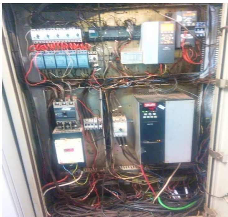
Figura 11: Painel 3 antes de ser readequado. Fonte: Própria.
