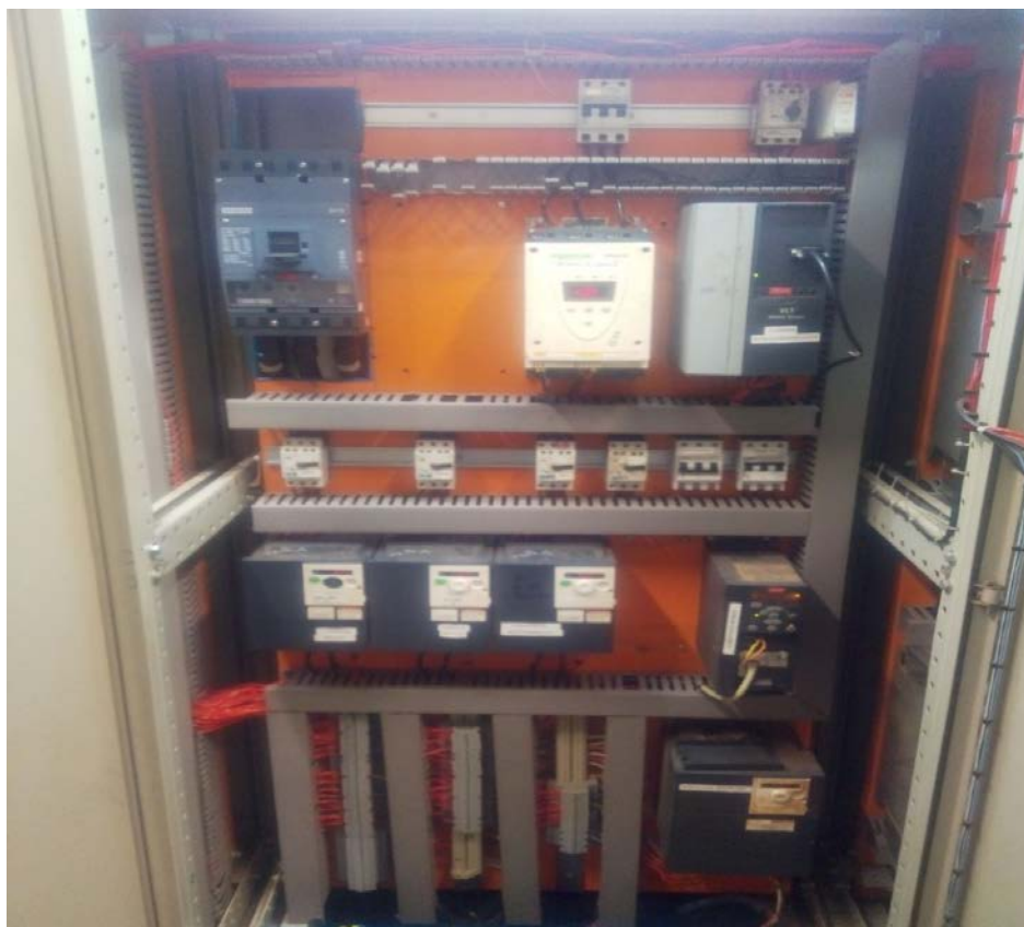
Figura 15: Painel 3 depois da readequação Fonte: própria
