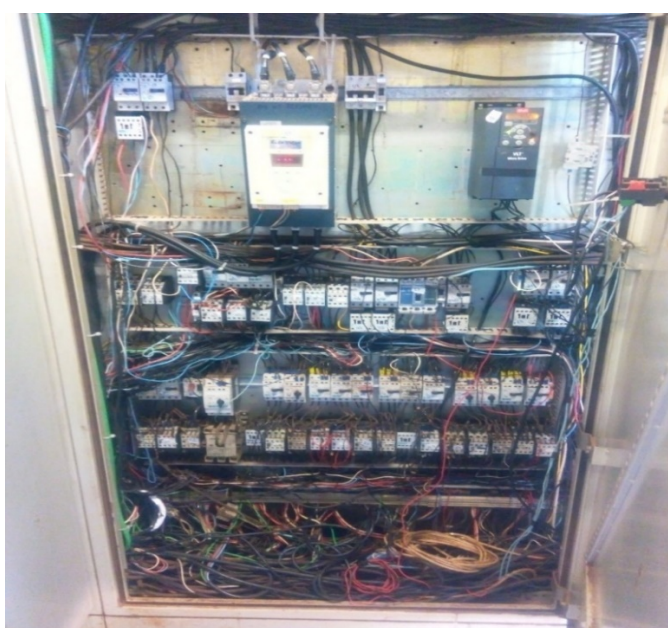
Figura 9: Painel 1 antes da readequação. Fonte: própria.
