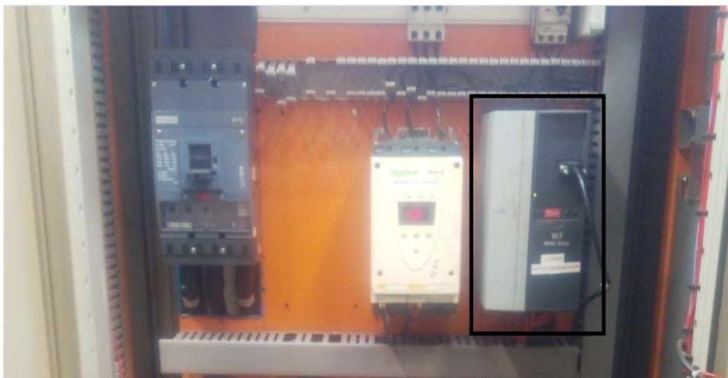
Figura 20: Inversor de frequência da turbina Fonte: própria
