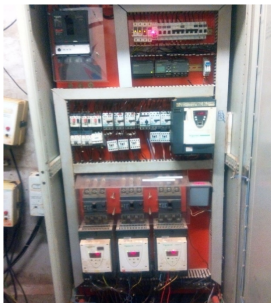
Figura 12: Painel 4 antes de ser readequado. Fonte: Própria.
