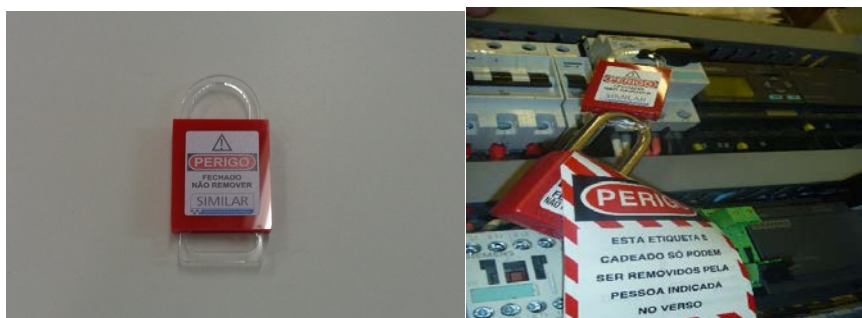
Figura 3: Cadeado de Bloqueio de Disjuntor Fonte: própria
