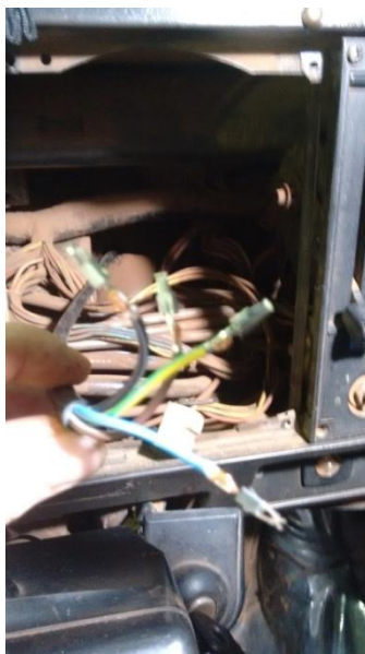
Figura 5. Terminais acoplados ao cabo da tomada A.
