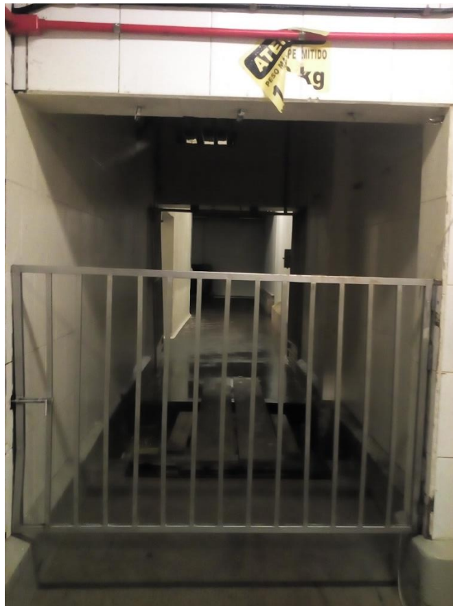
Figura 2 - Porta Inferior do Elevador.
