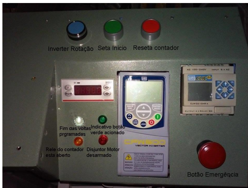
Figura 25 - Painel de comando. Fonte: Autoria própria
