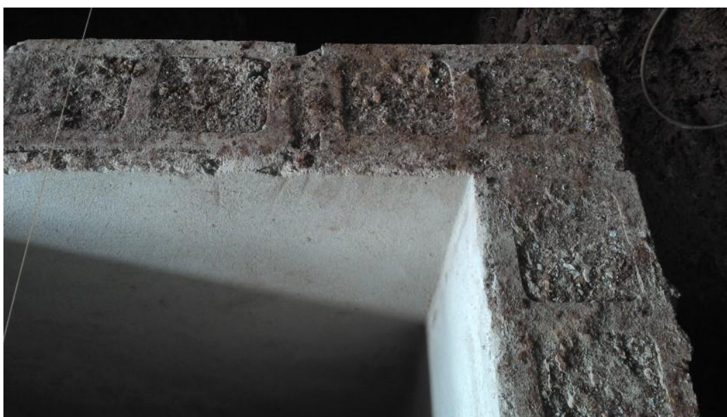
Figura 11 – Blocos de concreto grauteados e reboco com argamassa industrial. Fonte: Autoria Própria.
