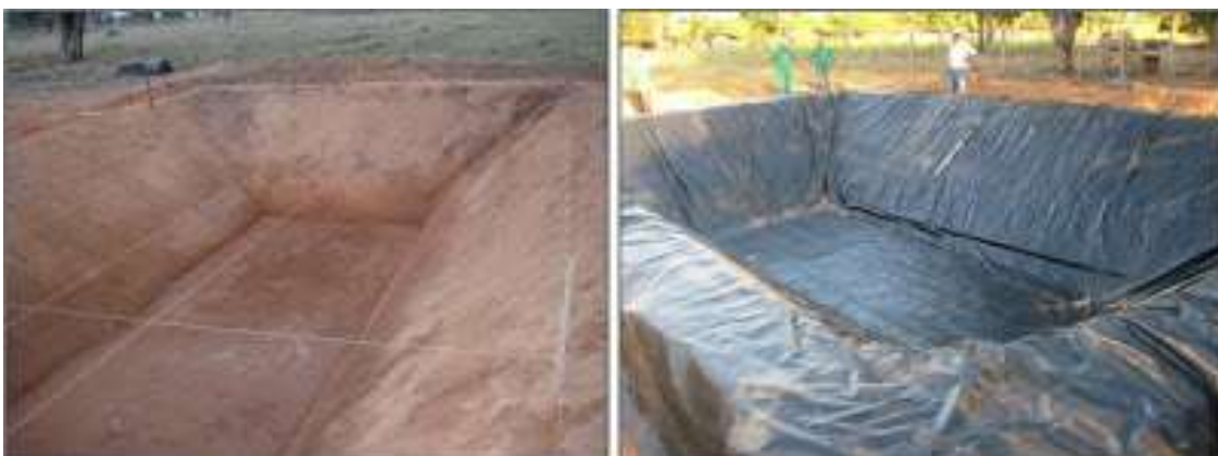
Figura 5.10: Lagoa de tratamento impermeável. (Fonte: QUEIROZ, T. M.).
