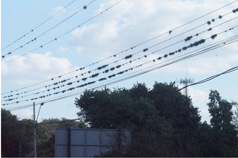
Figura 8: Incidência de T. recurvata sobre a fiação de energia elétrica na cidade de Céu Azul, PR.
