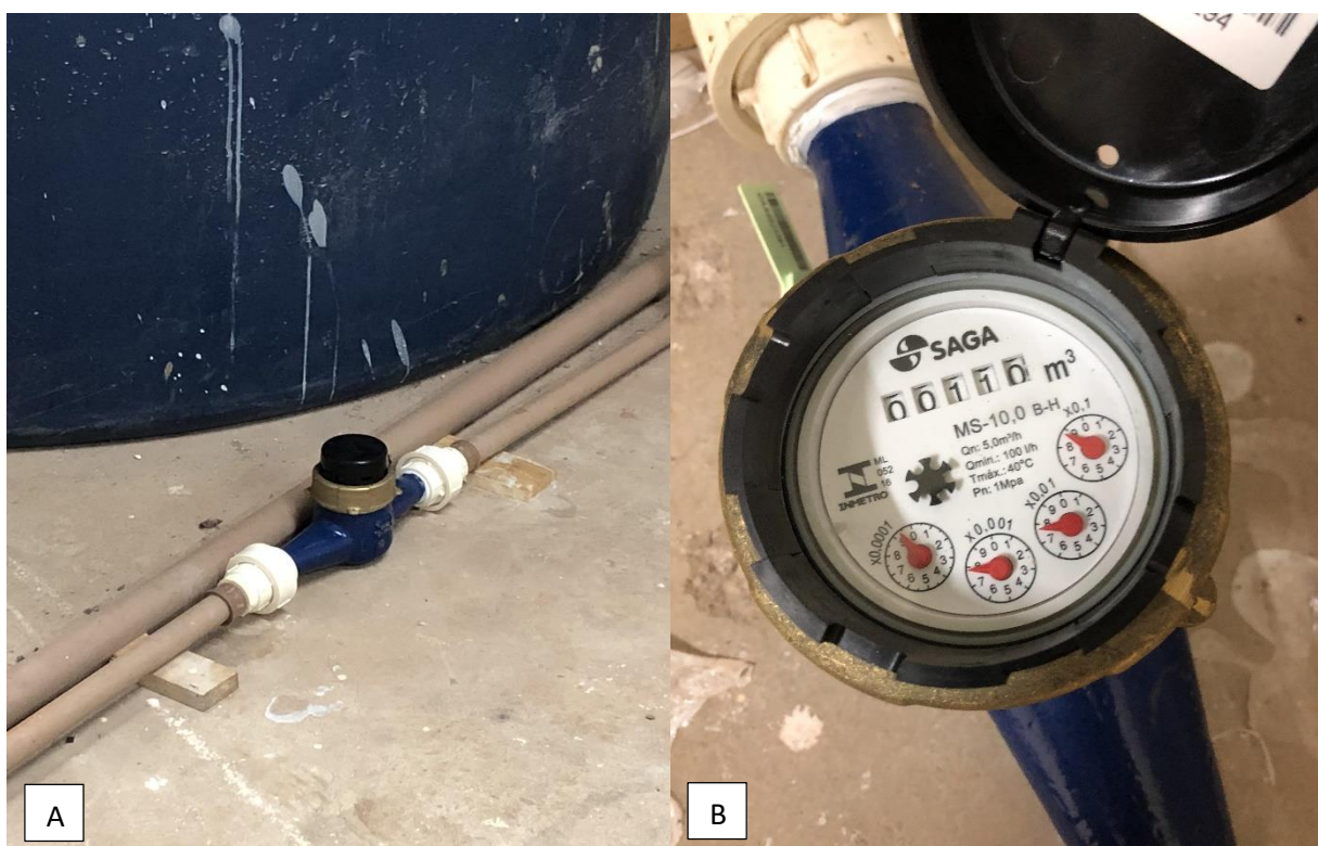
Figura 6: A- Fotografia da instalação do hidrômetro na saída do reservatório; B – Fotografia da medição com as unidades em m 3 do hidrômetro da marca Saga
