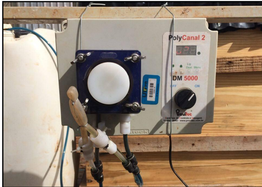
Fotografia 3: Bomba dosadora peristáltica utilizada na alimentação do sistema.
