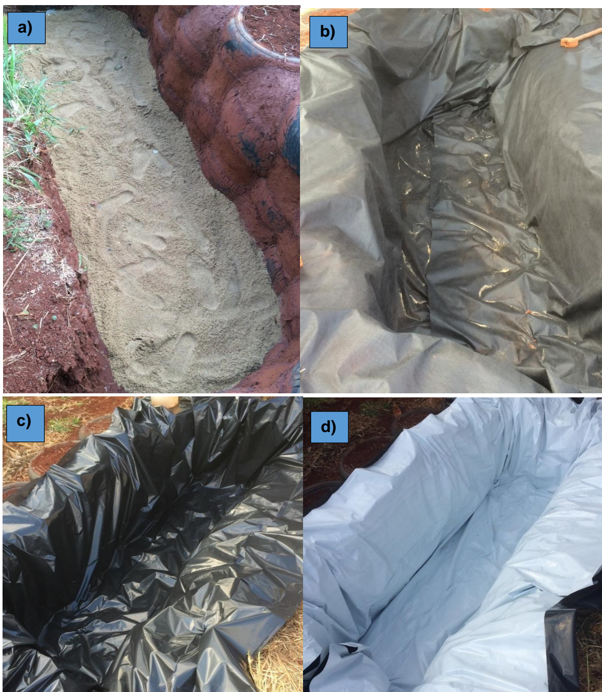
Figura 22 – Fotografia da impermeabilização do WCH: (a) preenchimento com areia; (b) revestimento de TNT; (c) revestimento de lona 200 micra e (d) revestimento de lona 200 micra dupla face
