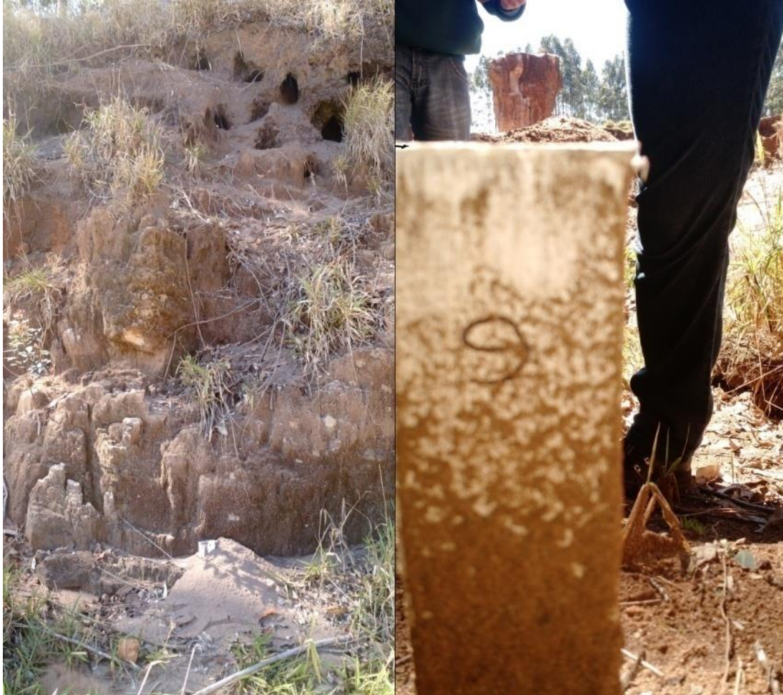
Figura 13 - Estaca 6 com o sistema de túneis no talude superior e Estaca 9 apresentando um maior acúmulo em sua parte detrás respectivamente
