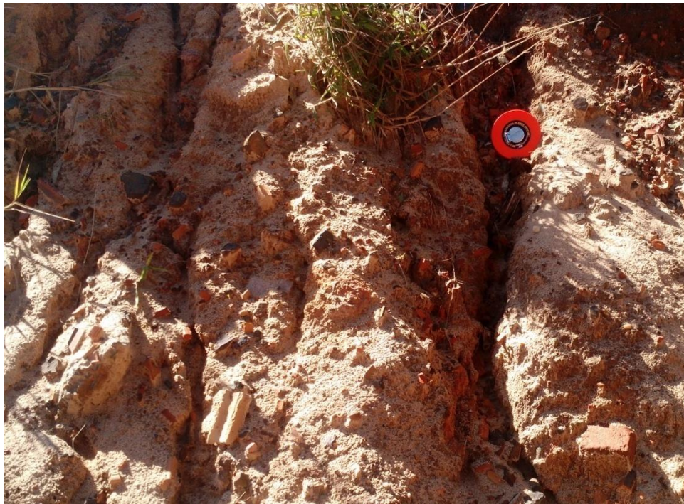
Figura 19 - Ravinamentos formados em encosta na entrada da área de extração
