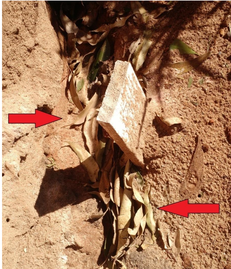
Figura 18 - Ravina se formando entre a área recém desativada e a de disposição de estéril
