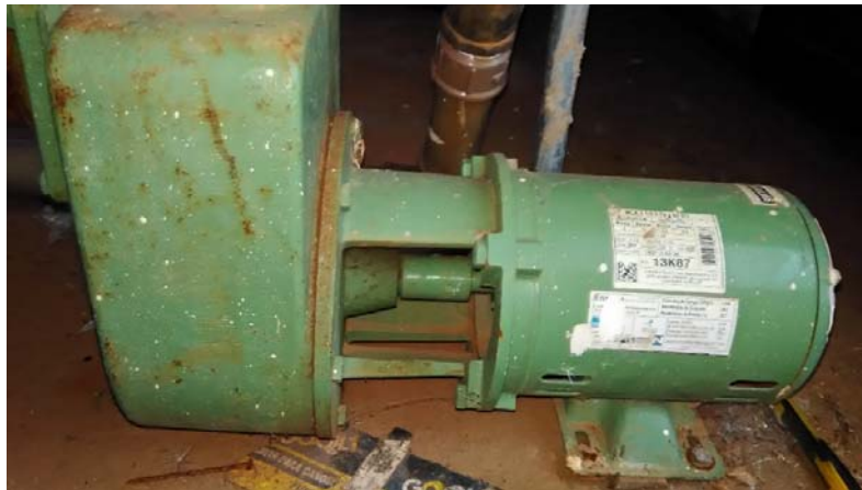
Figura 16 - Bomba hidráulica centrífuga e motor acoplado Fonte: Própria
