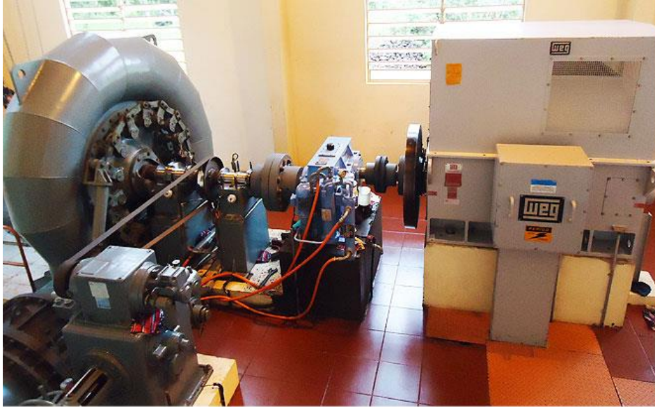
Figura 26 - Turbina Utiliza na Usina de Buricá Fonte: Certhil (2013)
