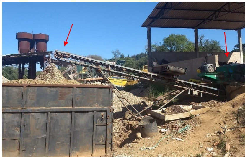
Figura 22 - Triturador dos resíduos de madeira
