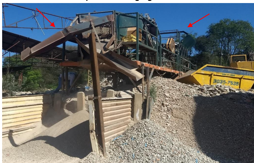
Figura 19 - Triturador e separador de agregados
