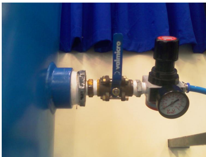
Figura 37- Válvula reguladora de pressão e válvula esfera para variação de SKT.
