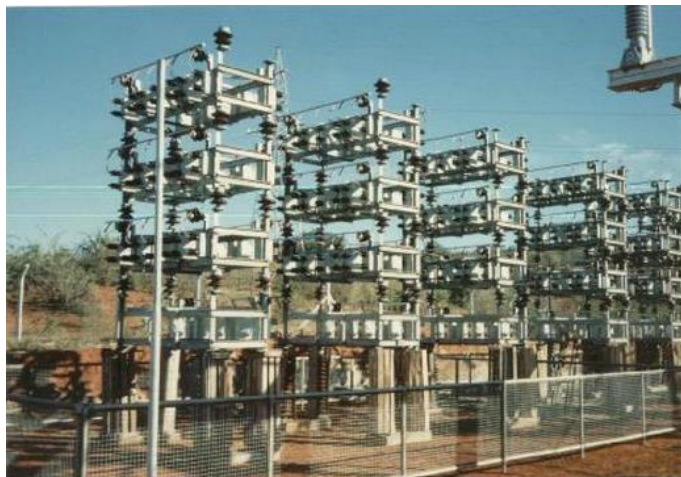
Figura 3 - Banco de capacitores instalado em uma subestação
