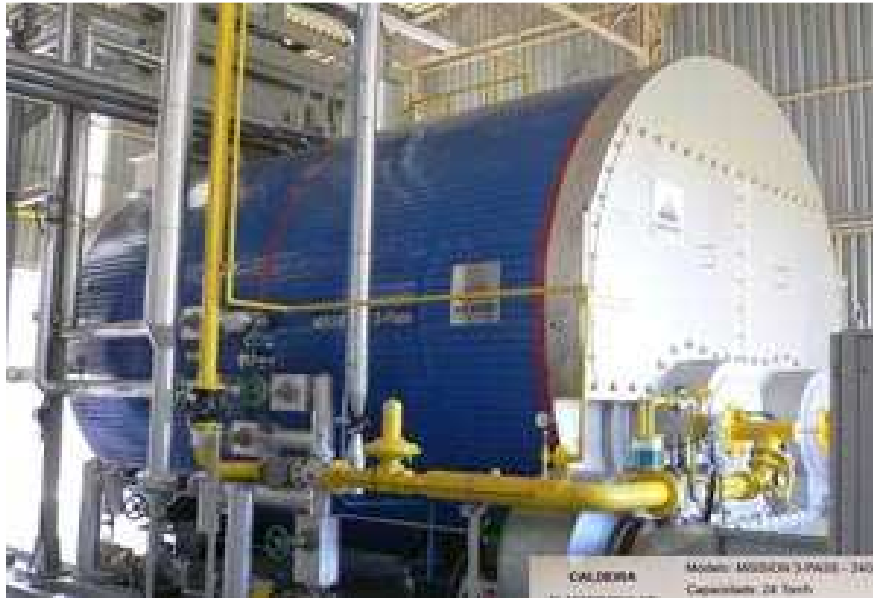
Figura 39: caldeira Alfa Laval Aalborg Fonte: Aalborg Industries, 2013.
