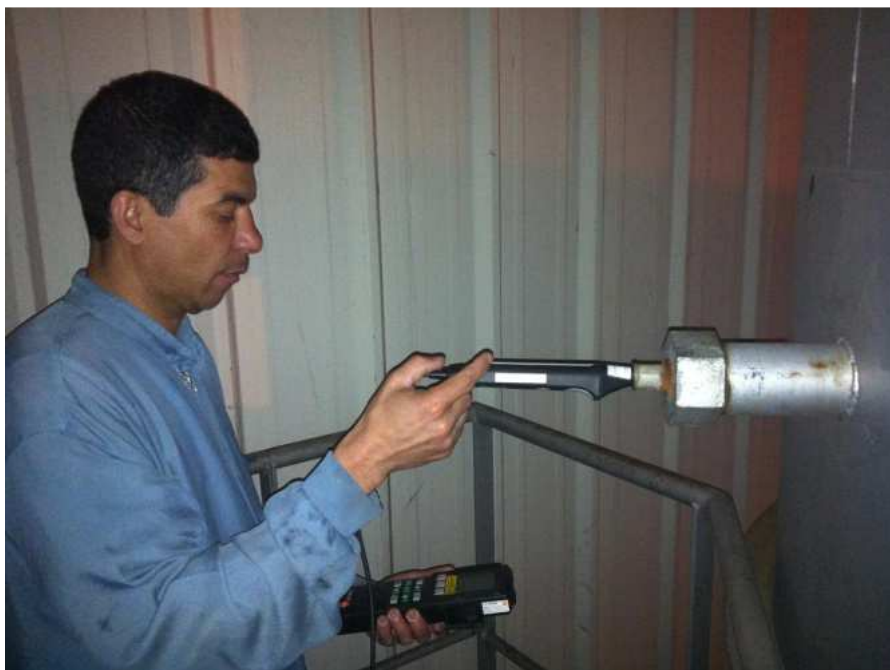
Figura 37: medição de temperatura do vapor Fonte: autoria própria
