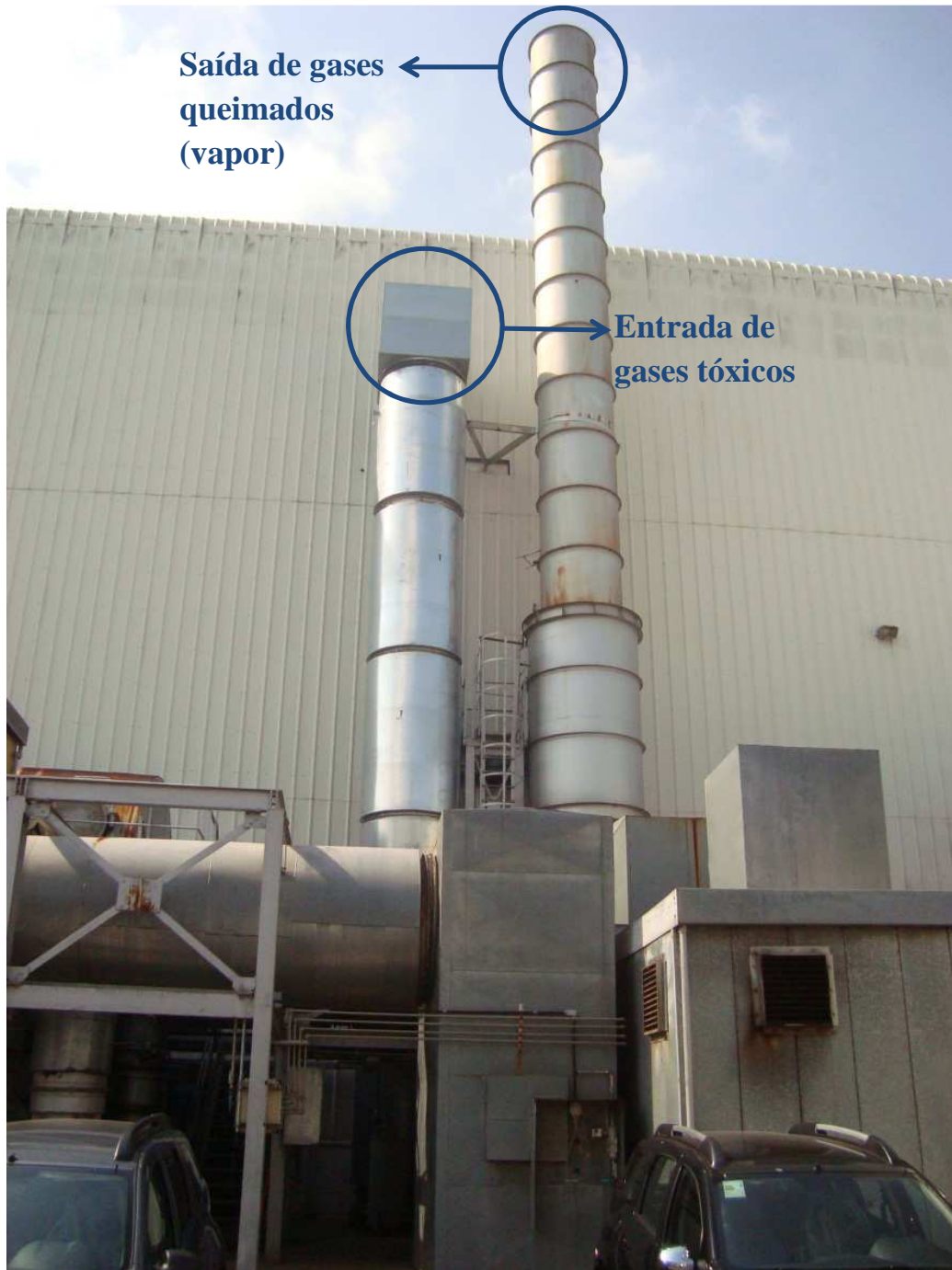
Figura 29: chaminés de entrada e saída do queimador Fonte: autoria própria
