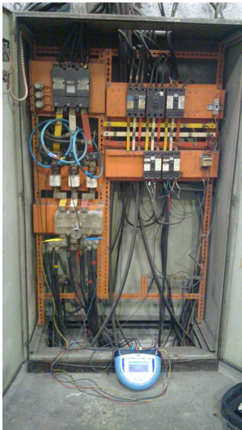
Figura 28 – Detalhe do QGBT
