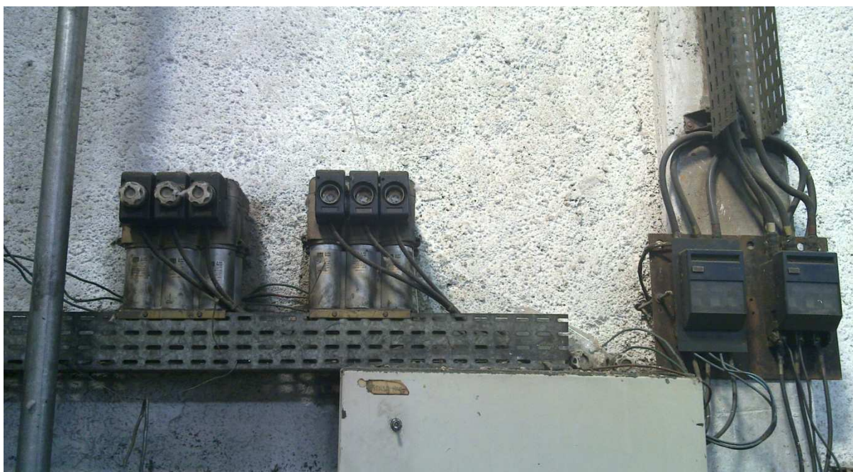
Figura 31 – Banco de Capacitores Desativado
