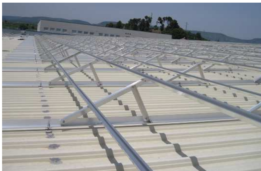
Figura 34– Estrutura de fixação dos módulos fotovoltaicos.
