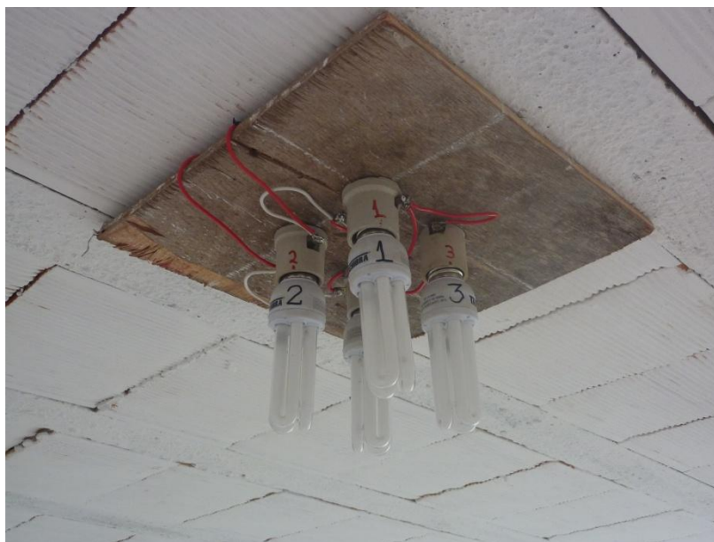
Figura 83 – Suporte com as lâmpadas fluorescentes. Fonte: Autoria própria.
