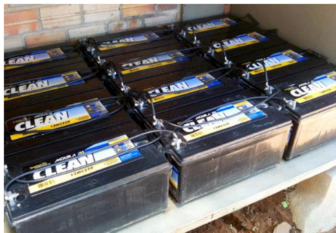
Figura 32 - Banco de Baterias 12x 220 Ah na Pousada Solar dos Ventos (Fernando de Noronha). Fonte: Guia do Hardware (2010).
