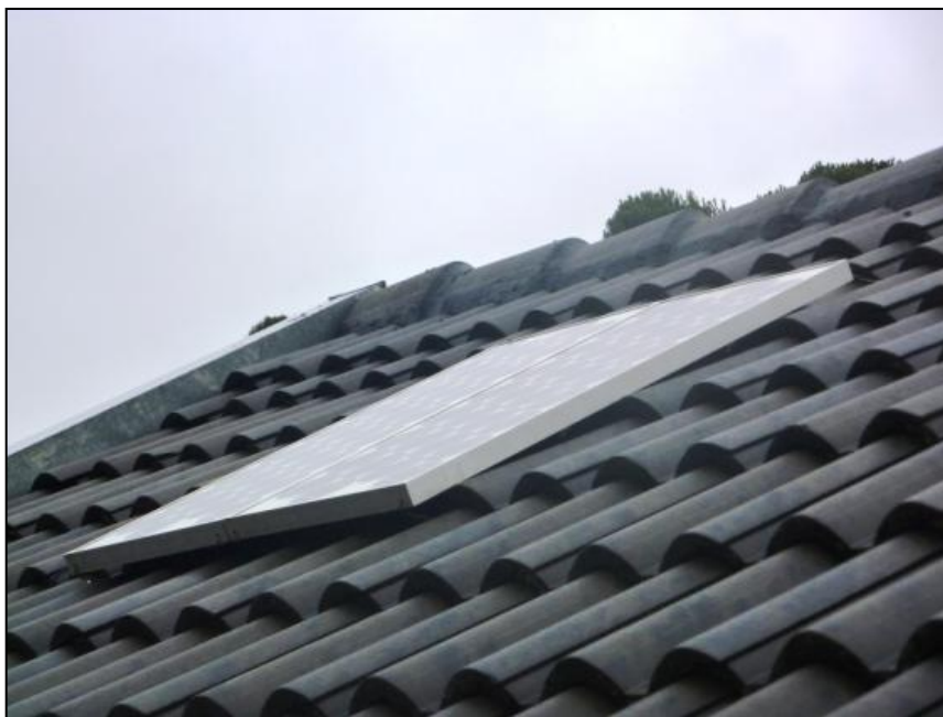
Figura 81 - Painel fotovoltaico instalado no telhado da residência. Fonte: Autoria própria.
