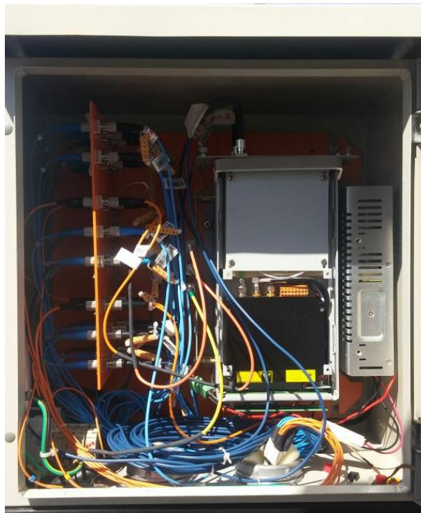
Figura 43 - DGO de pátio aberta instalado na base da fase A do TECO-MR. Fonte: Autoria própria (2016)
