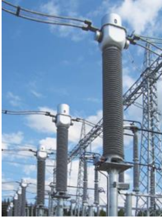
Figura 2: Transformadores de Corrente.
