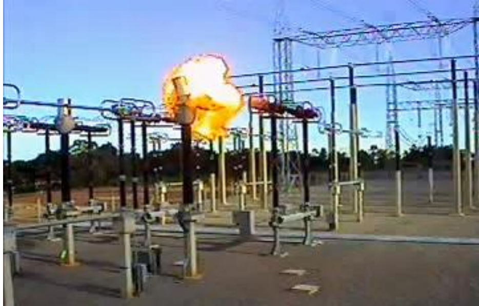
Figura 30 - Explosão de um TC convencional em uma subestação de 500 kV Fonte: YouTube (2009)
