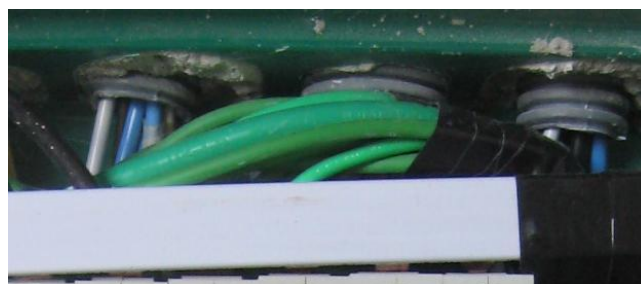
Figura 11 – Emenda entre condutores
