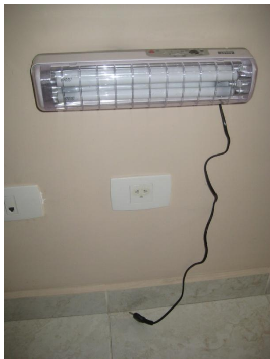
Figura 4 – Iluminação de emergência
