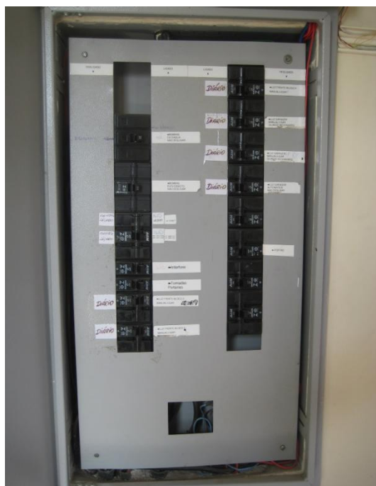
Figura 4 – Quadro de distribuição do condomínio
