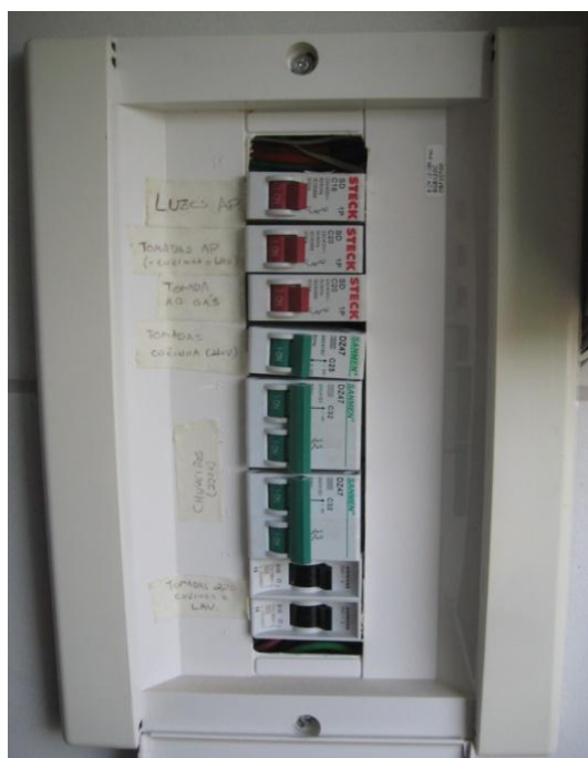
Figura 27 – Quadro de distribuição do apartamento
