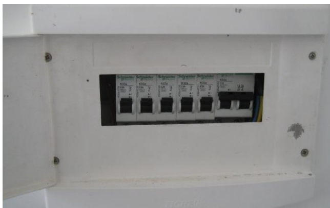
Figura 10 – Quadro de distribuição do apartamento
