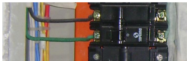
Figura 6 – Identificação de cores de condutor incorreta
