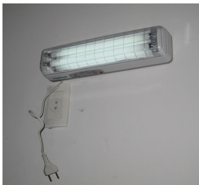
Figura 10 – Iluminação de emergência operante
