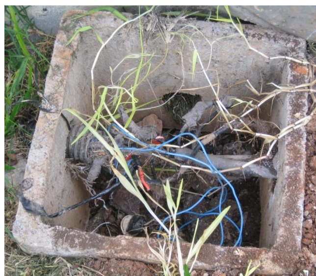
Figura 24 – Tomadas e emendas inadequadas
