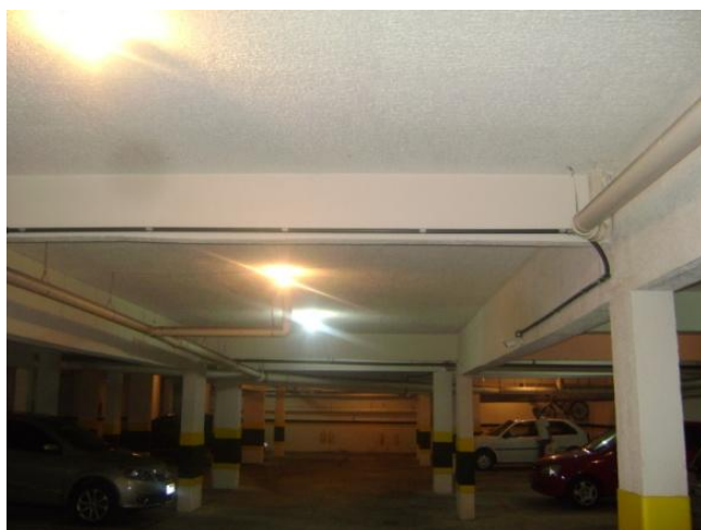
Figura 18 – Garagem sem presença de iluminação de emergência
