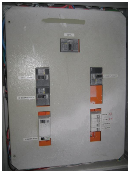
Figura 16 – Quadro de distribuição N1C
