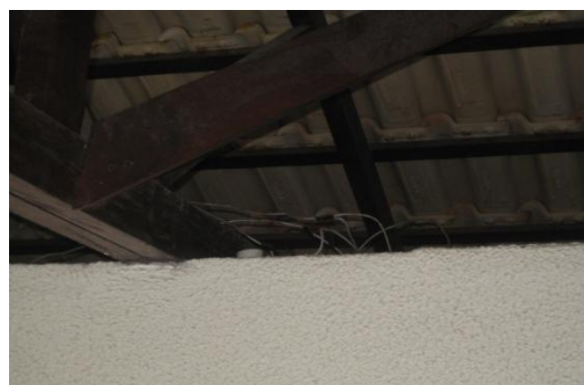
Figura 21 – Condutores sem eletroduto
