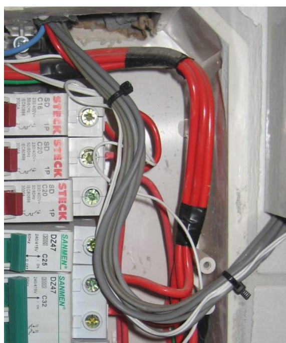
Figura 29 – Condutores do sistema de alarme
