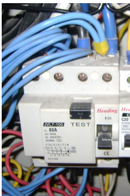
Figura 11 – Identificação de cores incorreta
