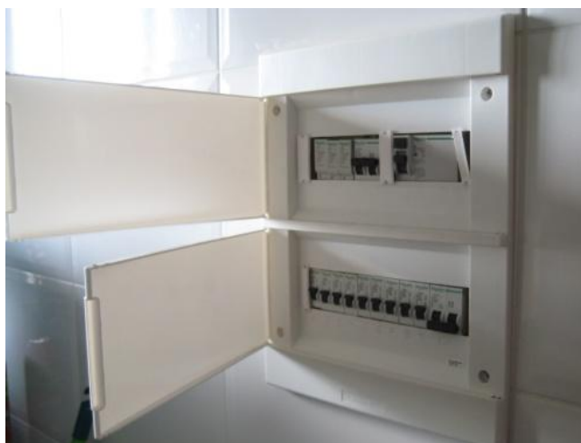
Figura 10 – quadro de distribuição do apartamento
