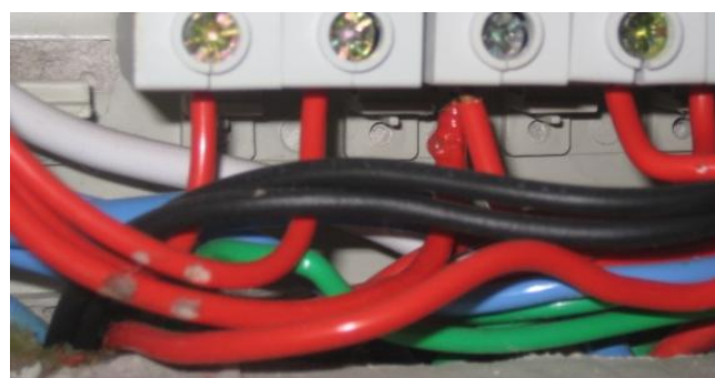
Figura 21 – Condutores com isolação danificada
