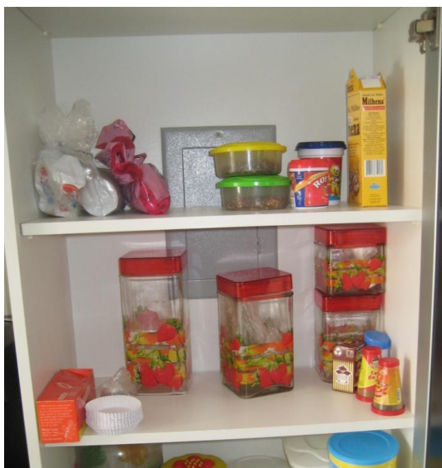
Figura 14 – Acesso ao quadro
