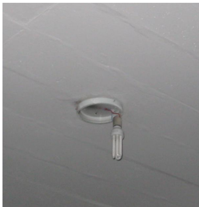
Figura 15 – Luminária com acesso as partes vivas
