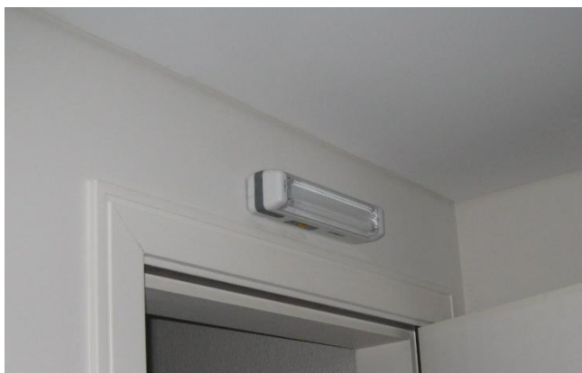
Figura 5 – Bloco de iluminação de emergência
