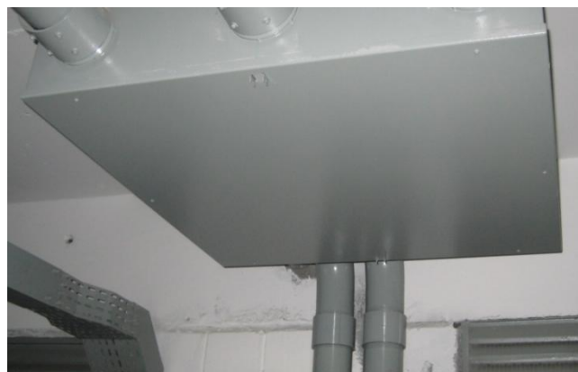
Figura 7 – Caixa de passagem
