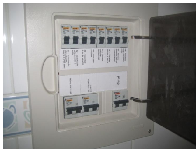
Figura 20 – Quadro de distribuição
