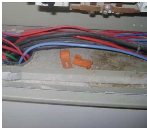
Figura 7 – Presença de dispositivos estranhos a instalação
