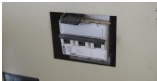
Figura 5 - Chave sobre o disjuntor geral
