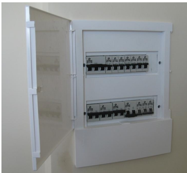
Figura 9 – Vista do quadro
