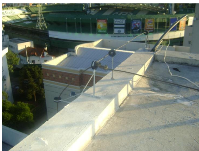
Figura 20 – Ausência da proteção de borda
