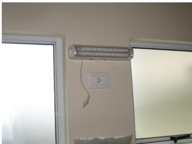
Figura 5 – Luminária de Emergência inoperante na escadaria
