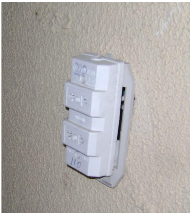
Figura 15 – Tomada sem aterramento
