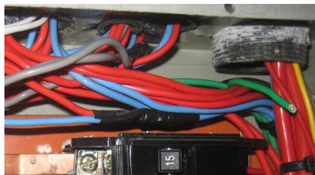
Figura 8 – Emenda inadequada e condutor inoperante
