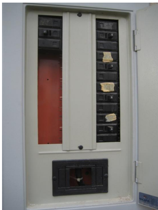
Figura 4 – Quadro de distribuição do condomínio
