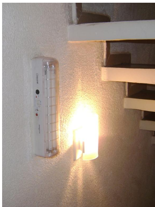
Figura 6 – Iluminação de emergência inoperante
