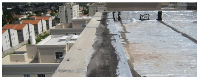
Figura 14 – Ausência da proteção de borda
