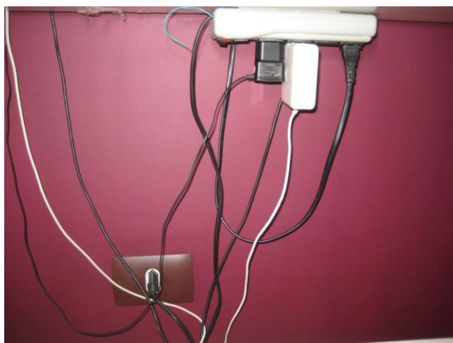
Figura 18 – Tomada na sala
