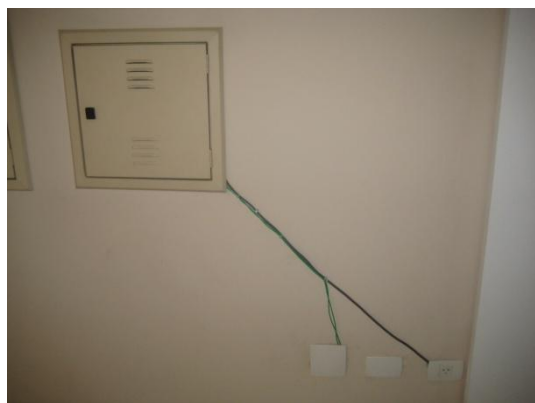
Figura 5 – Alimentação de Telecom
