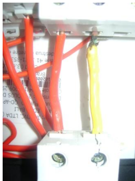
Figura 23 – Condutores com isolamento danificada
