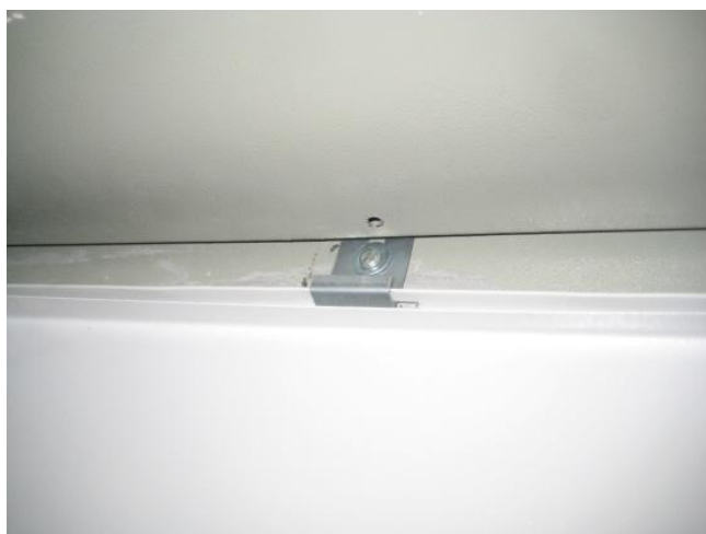
Figura 8 – Falta de parafuso de fixação no espelho do quadro
