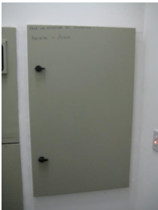
Figura 4 – Quadro do condomínio – sem identificação
