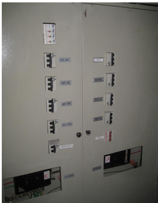
Figura 1 – Quadro geral do condomínio (subsolo)
