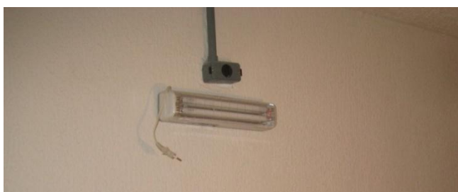
Figura 15 – Iluminação de emergência inoperante
