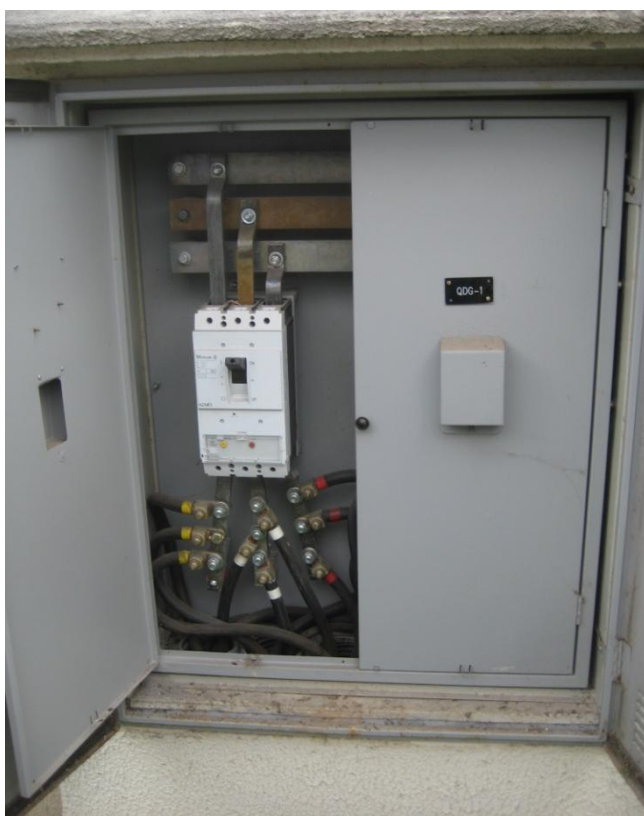
Figura 2 – Acesso ao quadro de derivação
