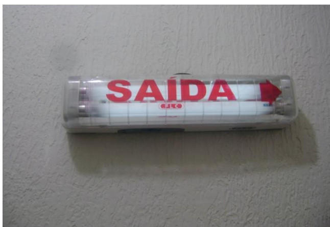
Figura 17 – Iluminação de emergência operante
