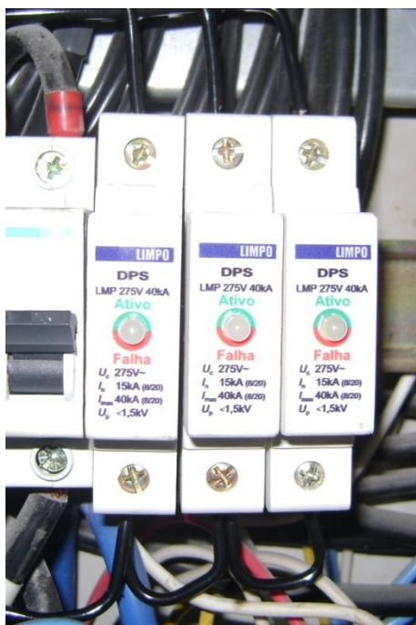
Figura 10 – Identificação de cores incorreta
