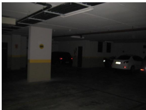
Figura 8 – Garagem sem presença de iluminação de emergência
