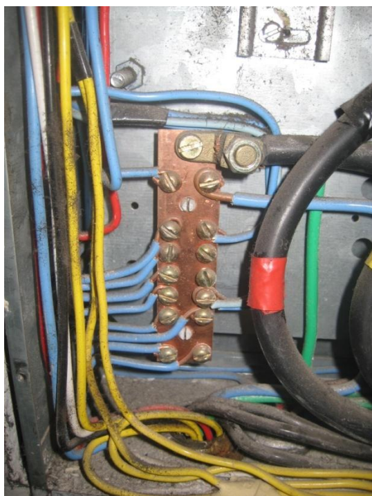
Figura 4 – Detalhe da barra de neutro
