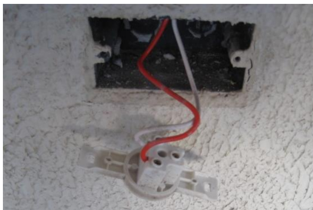
Figura 19 – Tomada sem aterramento
