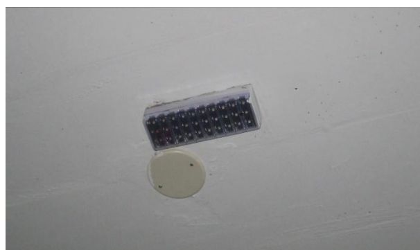
Figura 10 – Luminária de emergência inoperante na garagem
