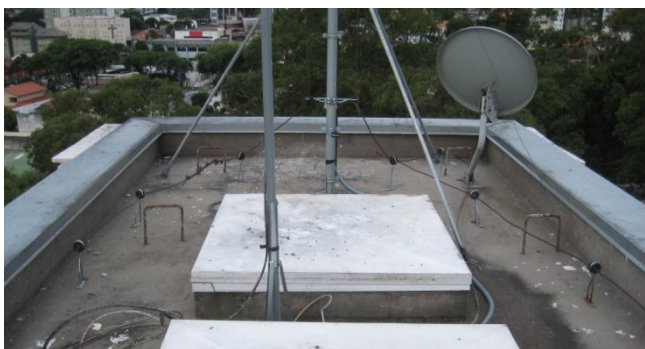
Figura 8 – Proteção de borda inexistente
