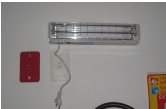
Figura 9 – Iluminação de emergência inoperante
