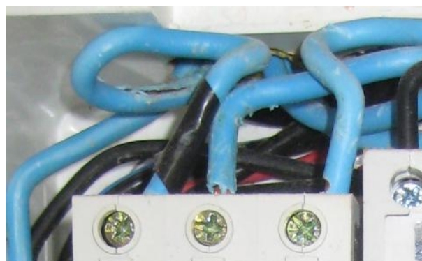
Figura 17 - Conductor com isolamento danificado
