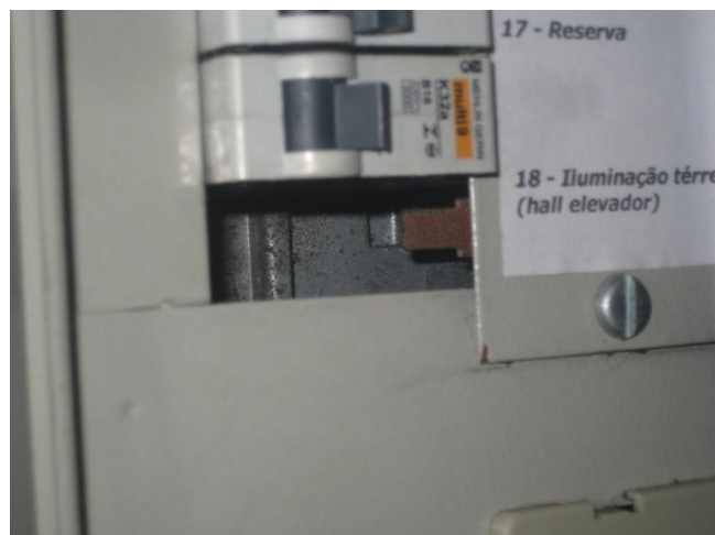
Figura 6 – Acesso ao barramento principal
