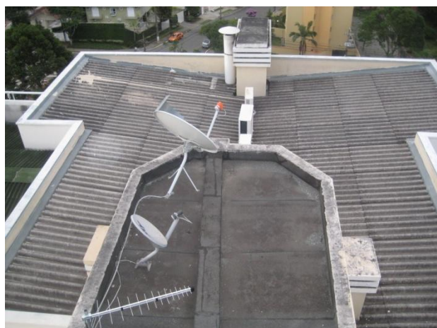
Figura 16 – Antenas fora da área de proteção do captor
