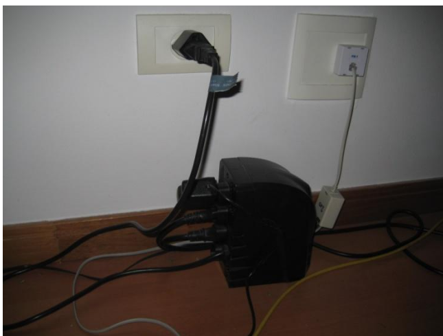
Figura 20 – Tomada na sala
