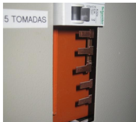
Figura 11 – Acesso ao barramento principal
