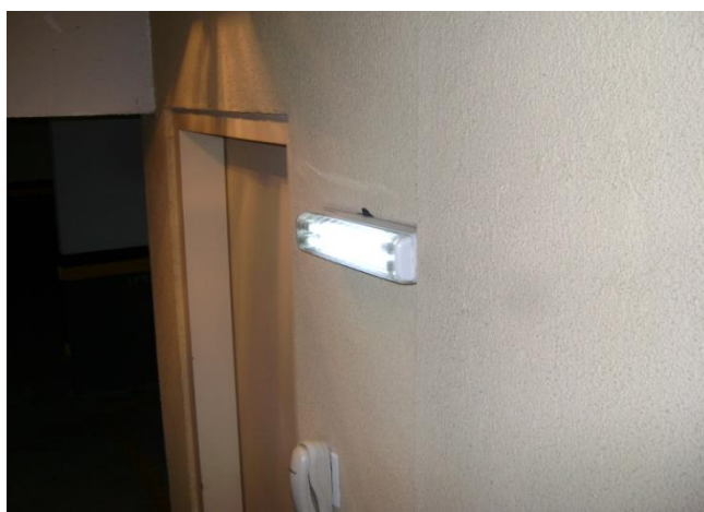
Figura 13 – Iluminação de emergência operante
