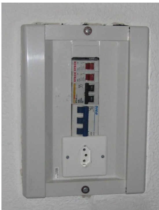
Figura 10 – Quadro de distribuição do condomínio
