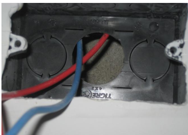
Figura 14 – Detalhe de condutor sem eletroduto
