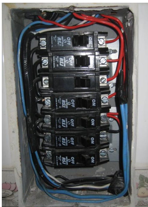
Figura 16 – Vista do quadro sem espelho
