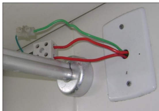
Figura 32 – Incoerência da seção do condutor de alimentação do chuveiro Fonte: Os autores.
