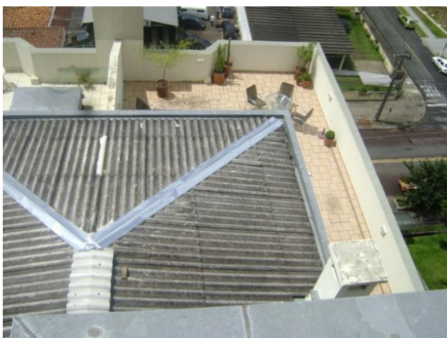
Figura 9 – Ausência de proteção de borda no edifício
