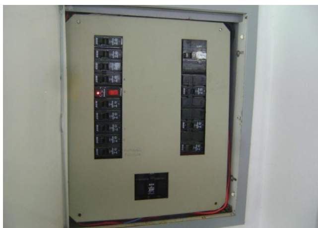
Figura 2 – Quadro de distribuição na garagem
