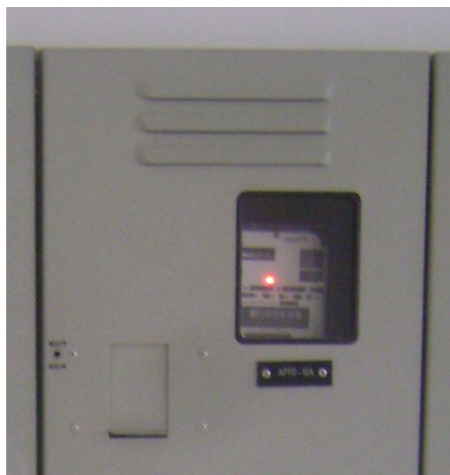
Figura 4 – Ausência do lacre COPEL
