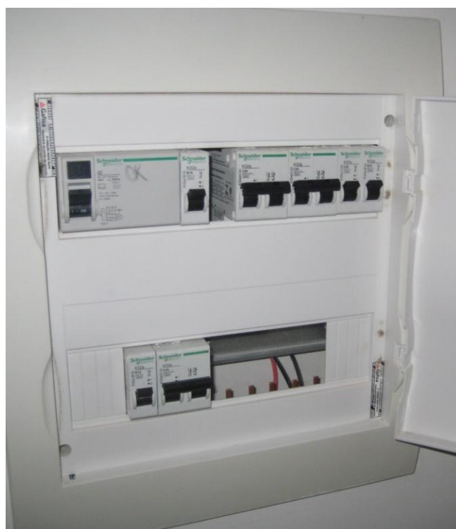
Figura 31 – Vista do quadro
