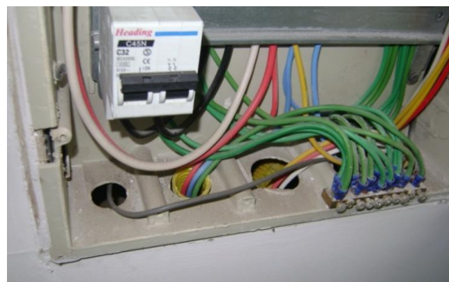
Figura 24 – Cabo telefônico no interior do quadro
