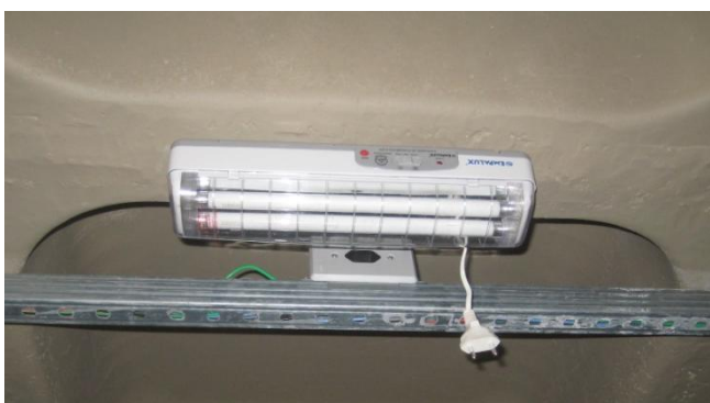
Figura 14 – Iluminação de emergência inoperante
