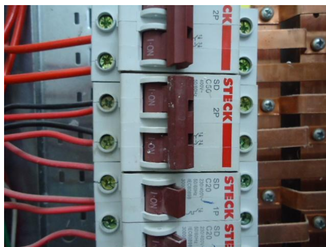
Figura 6 – Dispositivo de proteção incoerente
