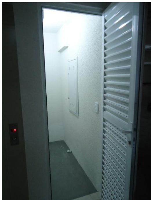
Figura 1 – Localização do quadro condomínio
