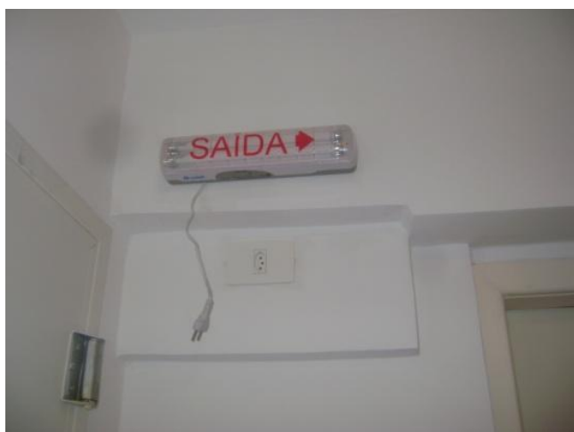
Figura 4 – Luminária de emergência inoperante no subsolo (próximo ao elevador)
