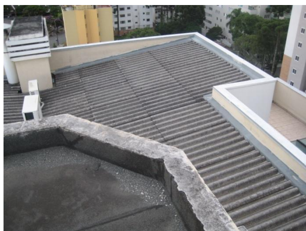
Figura 17 – Topo do prédio sem proteção de borda
