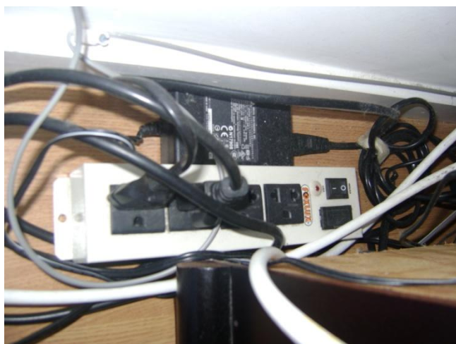
Figura 13 – Tomada na sala
