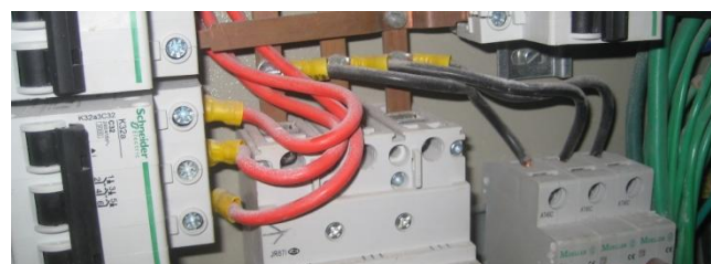
Figura 12 – Interligação de dispositivo por jumper
