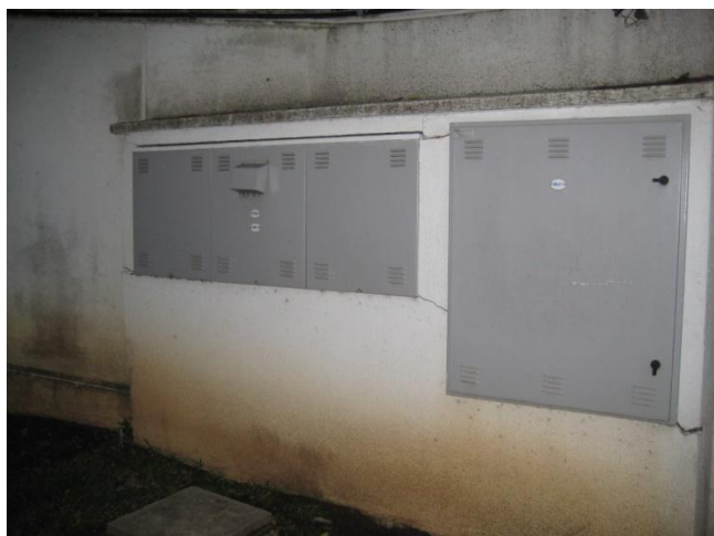
Figura 2 – Disjuntor Geral e Quadro da entrada de serviço
