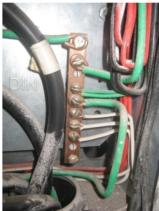
Figura 5 – Detalhe da barra de aterramento
