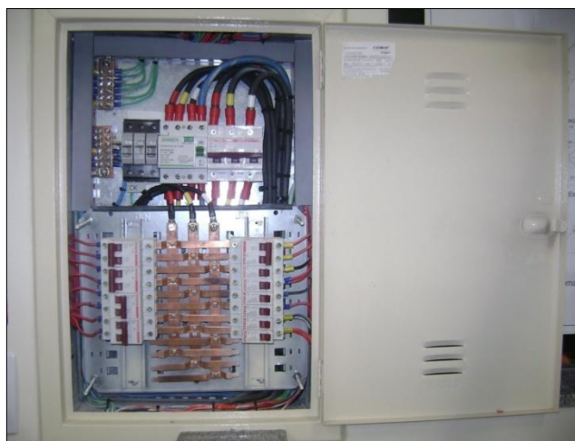
Figura 7 - Exemplo de quadro geral de distribuição Fonte: O mundo da eletricidade, 2011.
