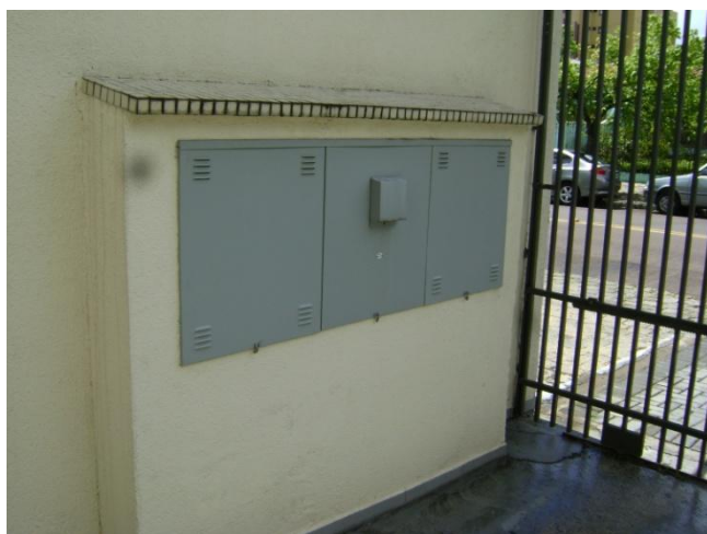
Figura 7 – Entrada de energia
