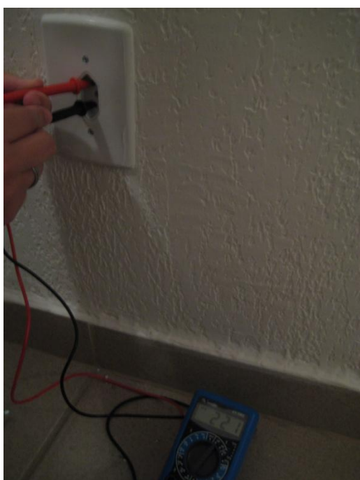
Figura 9 – Tomada com tensão de 220 V
