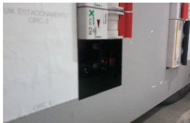
Figura 8 – Acesso a partes vivas
