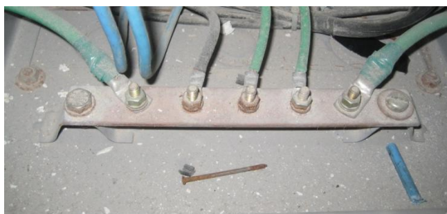
Figura 3 – Restos de materiais no interior do quadro
