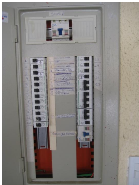
Figura 5 – Quadro geral do condomínio (subsolo)
