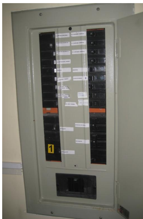
Figura 2 – Quadro de distribuição do condomínio
