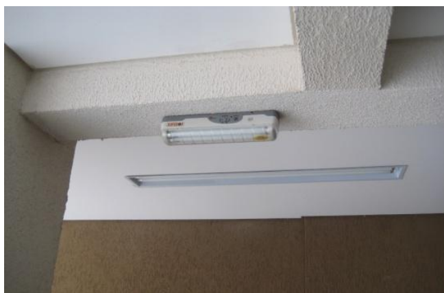
Figura 18 – Luminária de emergência inoperante na garagem do térreo
