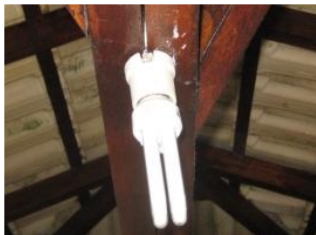
Figura 20 – Acesso a partes vivas
