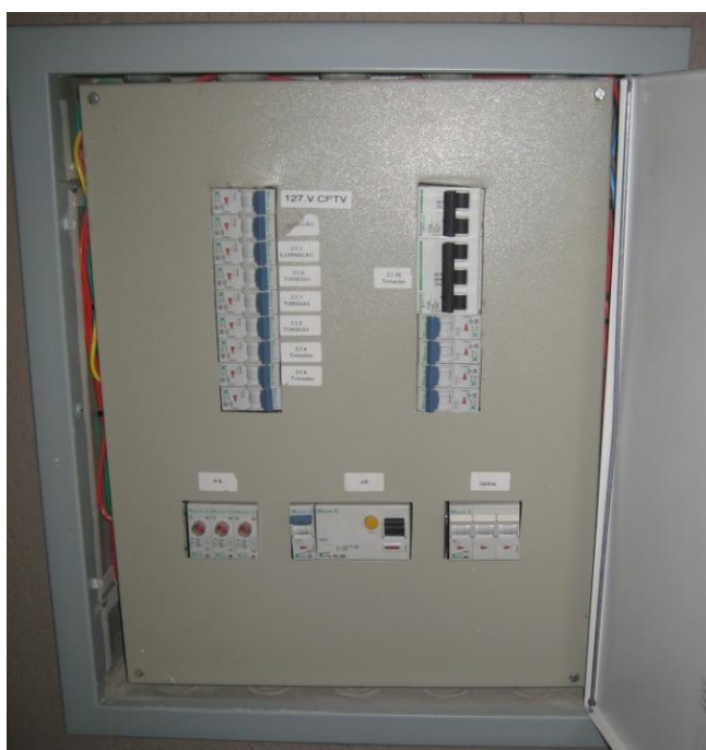
Figura 5 – Quadro de distribuição do condomínio (QD-01)
