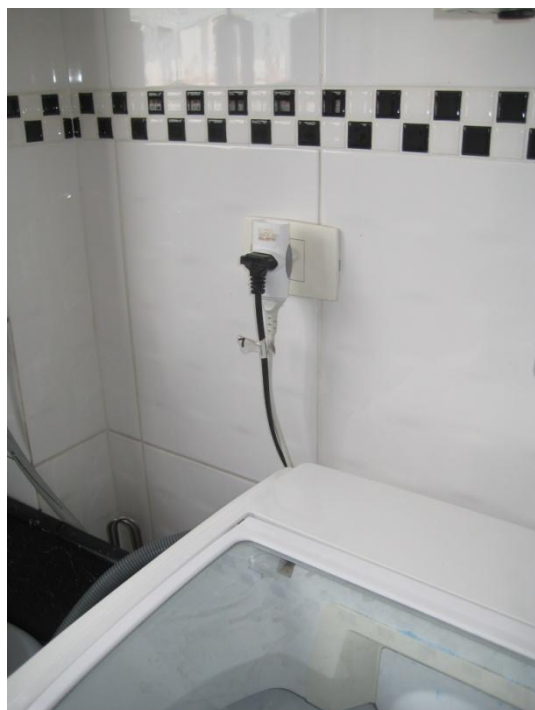
Figura 12 – Tomada em lavanderia
