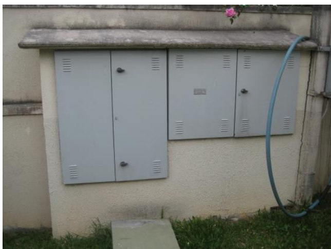
Figura 1 – Vista geral dos quadros da entrada de serviço
