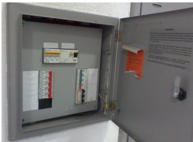
Figura 6 – Quadro de distribuição do subsolo
