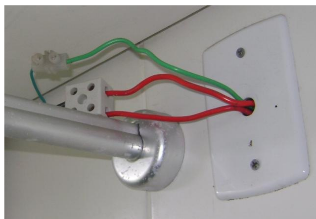
Figura 16 – Condutores do chuveiro elétrico
