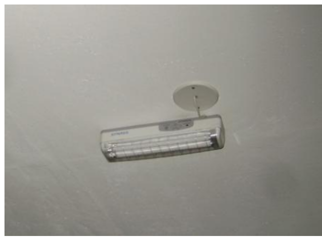
Figura 14 – Iluminação de emergência inoperante
