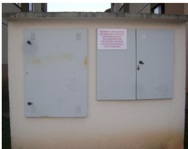
Figura 9 - Quadros da entrada de serviço (QDG-1)
