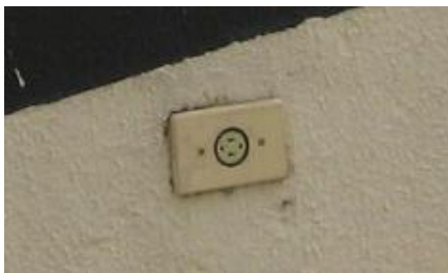
Figura 10 – Tomada da garagem
