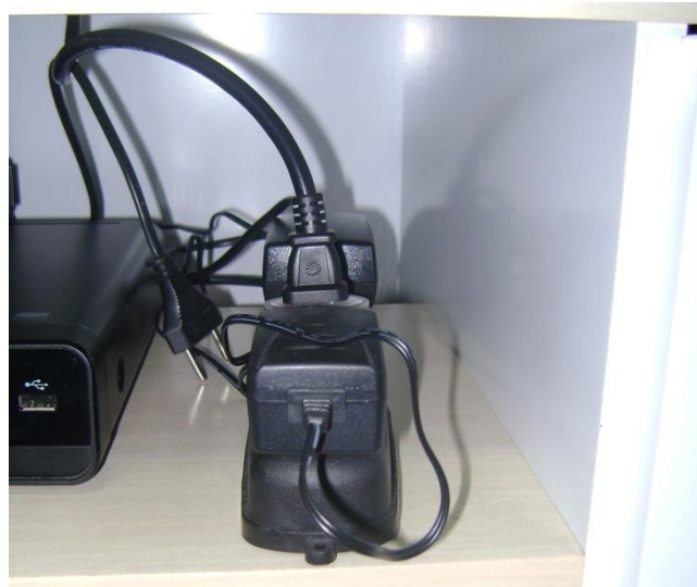
Figura 23 – Tomada na sala
