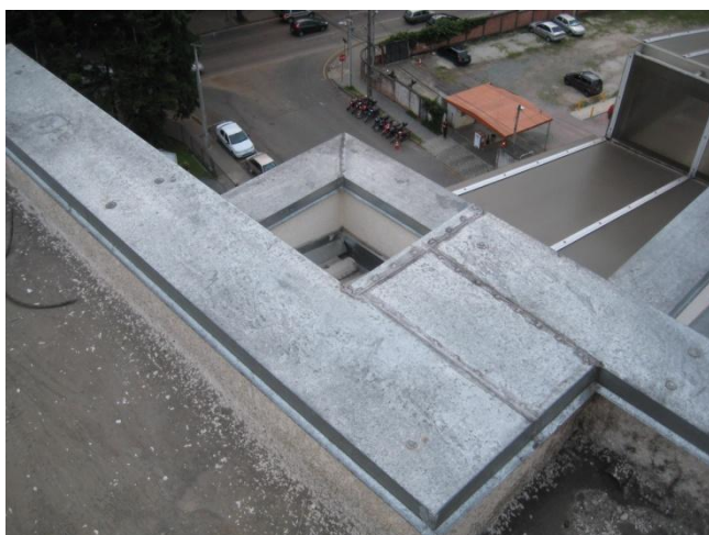
Figura 9 – Proteção de borda inexistente
