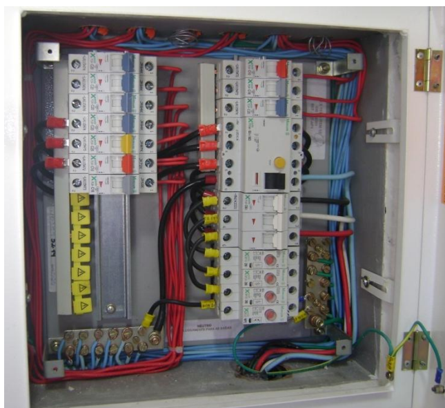
Figura 11 – Vista do quadro sem espelho
