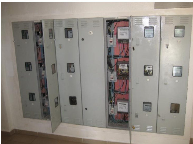
Figura 2 – Acesso aos medidores
