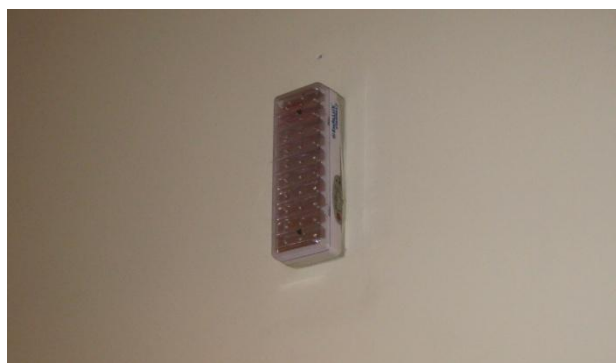
Figura 9 – Luminária de emergência inoperante na escadaria
