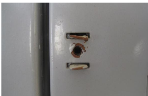
Figura 2 – Quadro de medição sem lacre da concessionária
