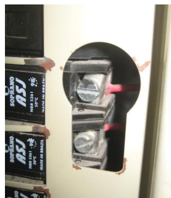
Figura 6 – Acesso a partes vivas
