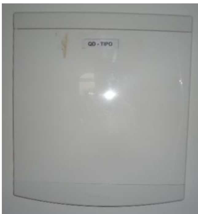
Figura 11 – Vista do quadro
