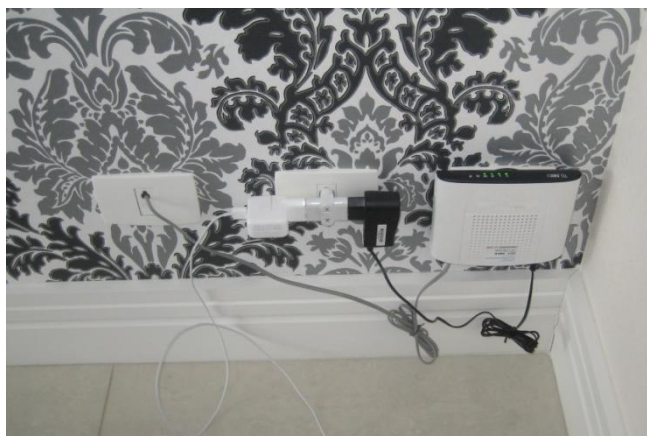
Figura 26 – Tomada na sala
