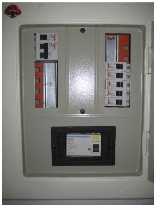
Figura 10 – Vista do quadro
