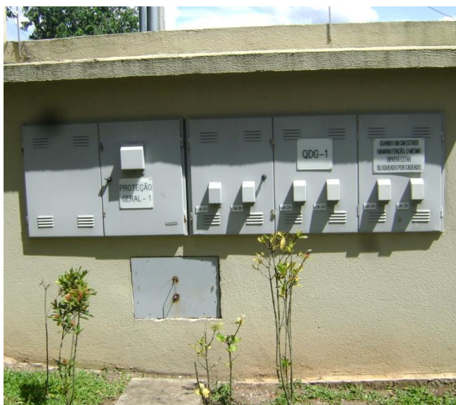
Figura 8 - Quadros da entrada de serviço (QDG-1)
