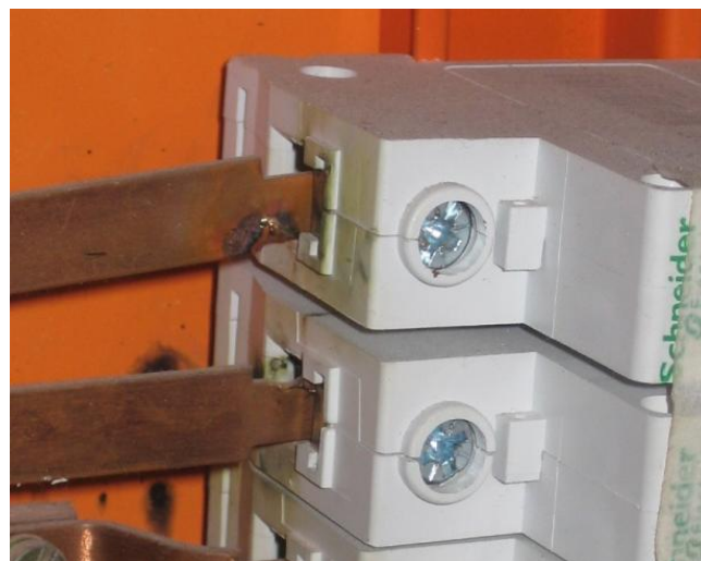
Figura 24 – Presença de barramento danificado
