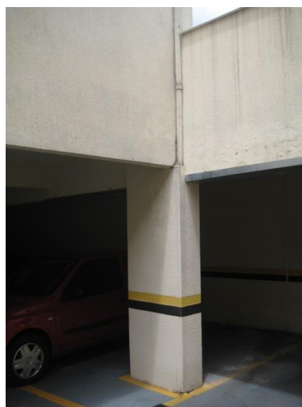
Figura 14 – Ausência de caixas de inspeção
