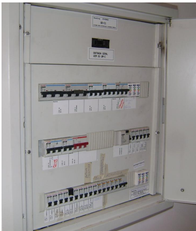
Figura 6 – Vista do quadro de distribuição do condomínio
