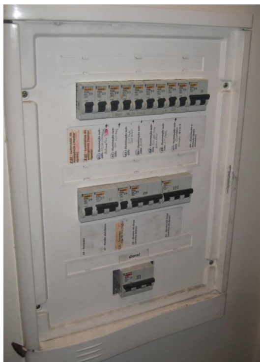
Figura 7 – Vista geral do quadro
