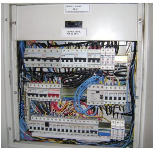
Figura 7 – Quadro de distribuição do condomínio sem espelho
