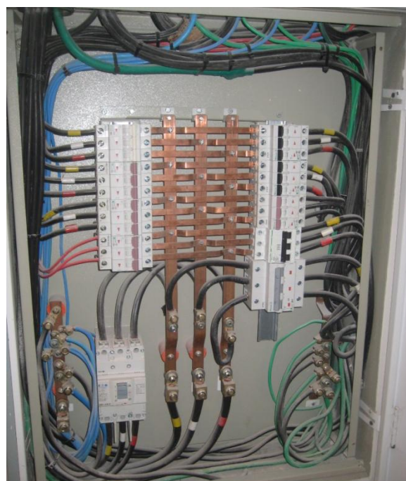
Figura 2 – Quadro de distribuição do condomínio sem espelho
