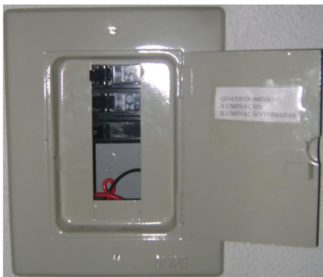
Figura 4 – Quadro de distribuição do condomínio
