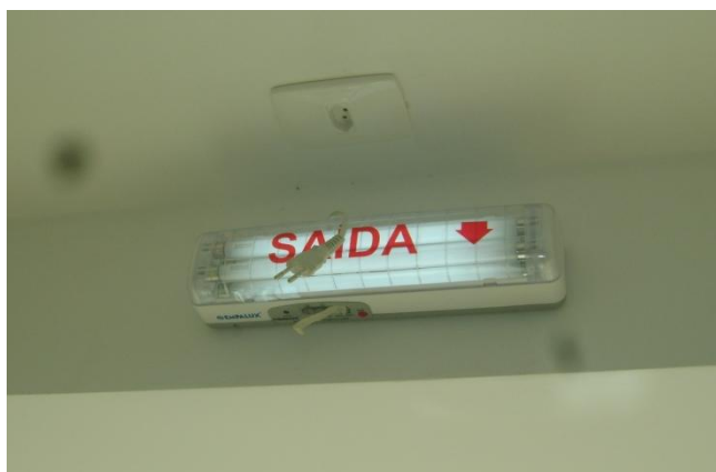
Figura 8 – Iluminação de emergência operante
