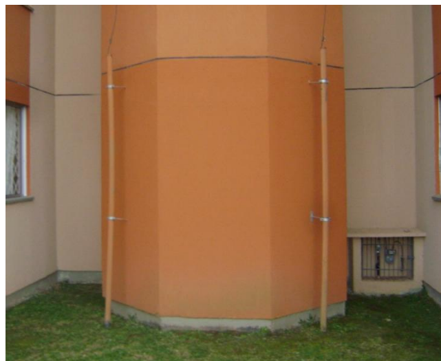
Figura 15 – Ausência de caixas de inspeção
