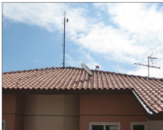
Figura 25 – SPDA com somente um cabo de descida e sem proteção de borda Fonte: Os autores.
