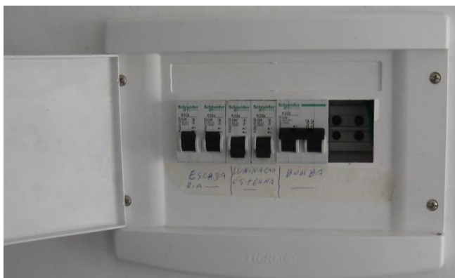
Figura 3 – Vista geral do quadro de distribuição
