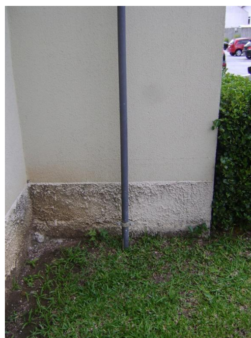
Figura 10 – Ausência de caixas de inspeção
