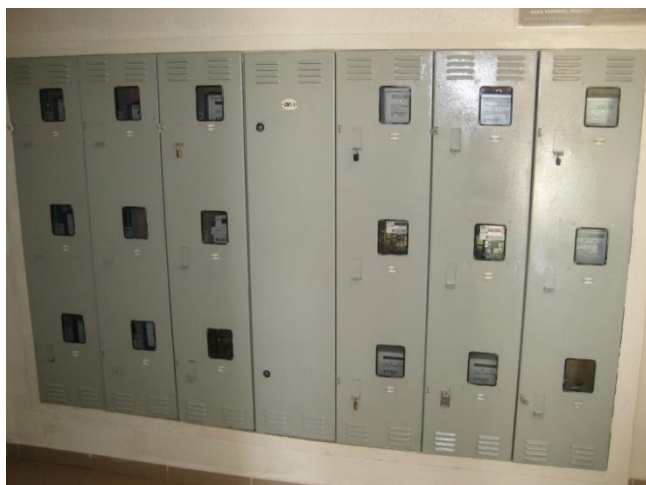
Figura 1 – Vista dos medidores
