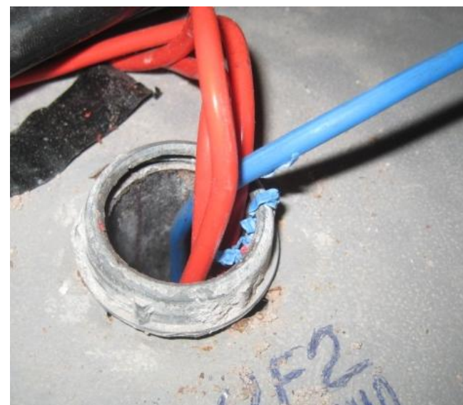
Figura 8 – Detalhe de condutor com isolamento danificado no QD-C
