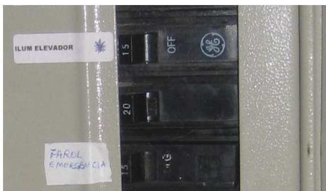
Figura 6 – Dispositivo de proteção sem identificação
