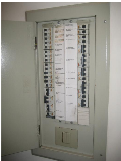
Figura 2 – Quadro de distribuição do condomínio
