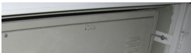
Figura 2 – Ausência do lacre COPEL
