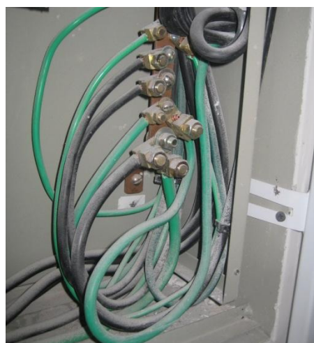
Figura 3 – Identificação de cores de condutor incorreta
