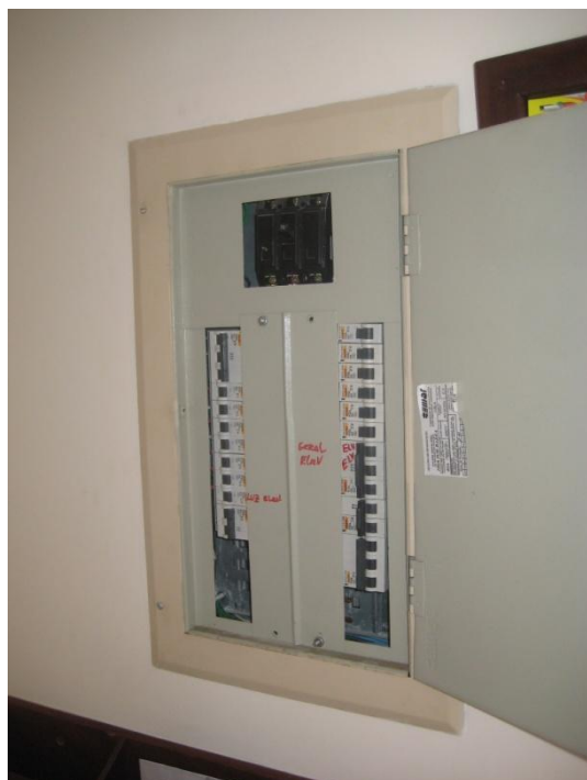
Figura 2 - Quadro da entrada de serviço
