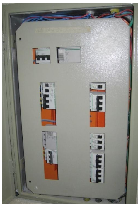
Figura 25 – Quadro de distribuição da casa de máquinas
