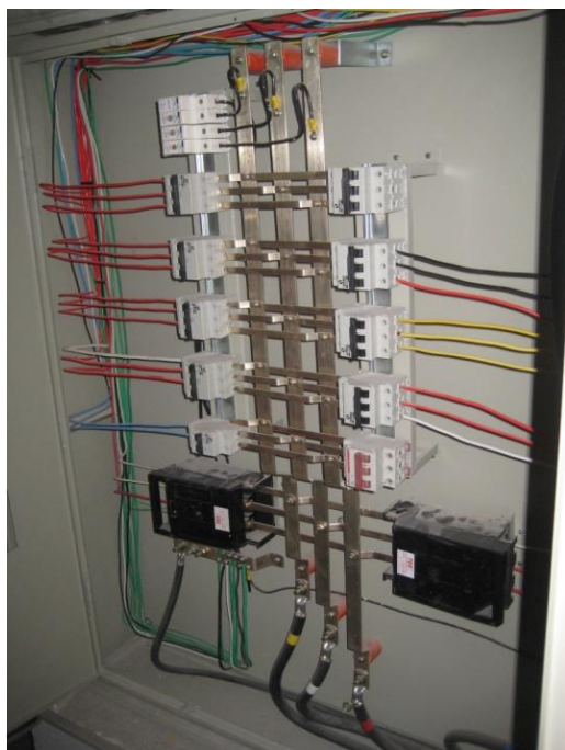
Figura 2 – Quadro geral do condomínio sem espelho
