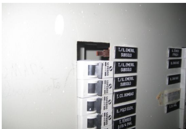
Figura 6 – Acesso ao barramento principal
