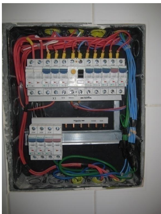
Figura 8 – Vista do quadro sem espelho
