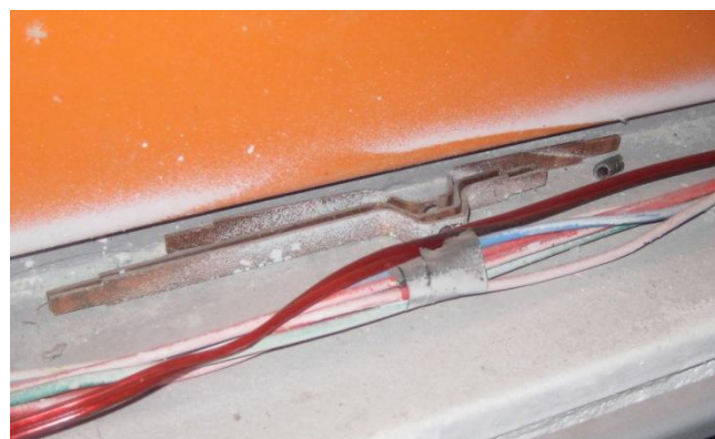
Figura 21 – Presença de barramento de interligação
