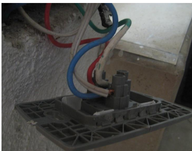
Figura 7 – Condutor branco utilizado como neutro
