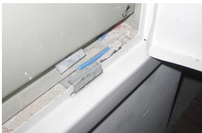
Figura 10 – Presença de restos de condutores
