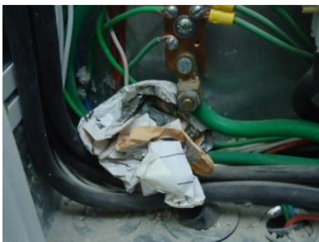
Figura 5 – Presença de materiais combustíveis
