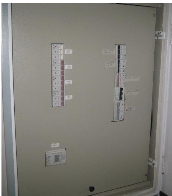
Figura 1 – Quadro de distribuição do condomínio
