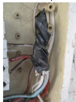
Figura 15 – Emenda entre condutor neutro
