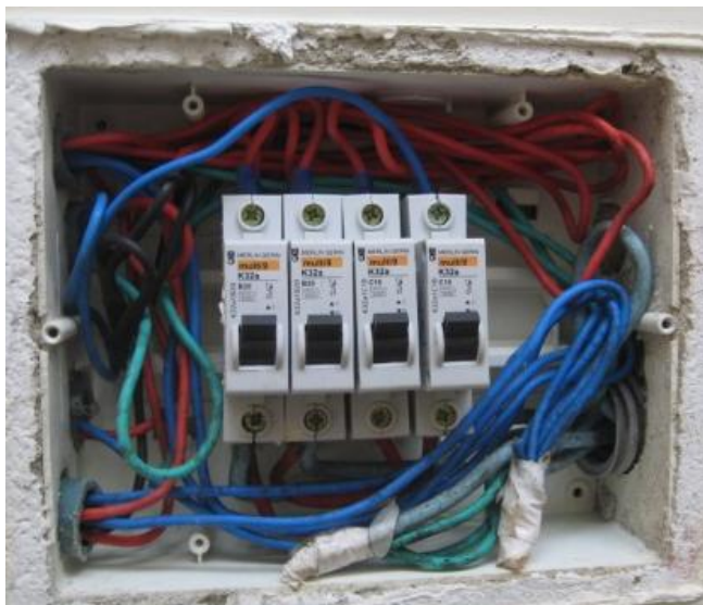
Figura 3 – Quadro de distribuição do condomínio (último andar)
