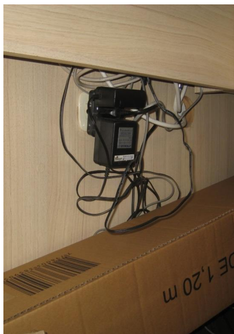
Figura 11 – Tomada em quarto
