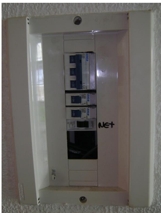
Figura 4 – Quadro de distribuição do condomínio
