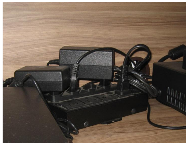
Figura 24 – Tomada na sala
