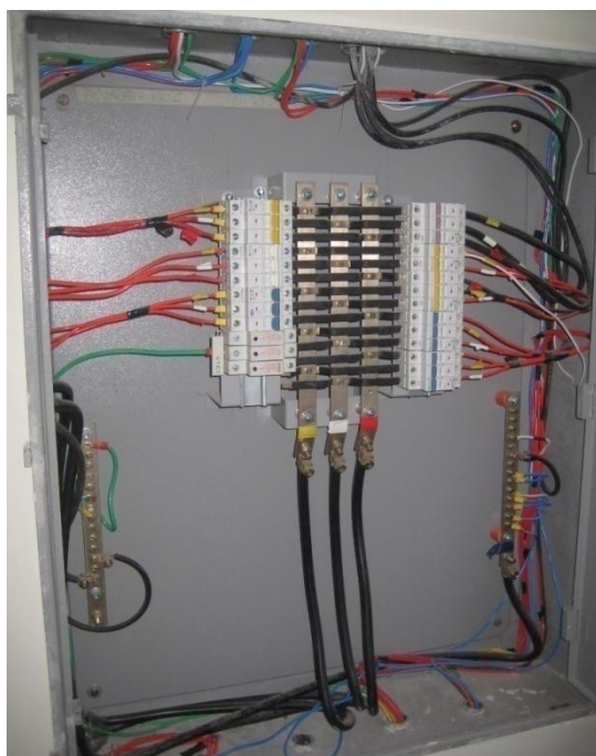
Figura 2 – Vista geral do quadro QD-C sem espelho
