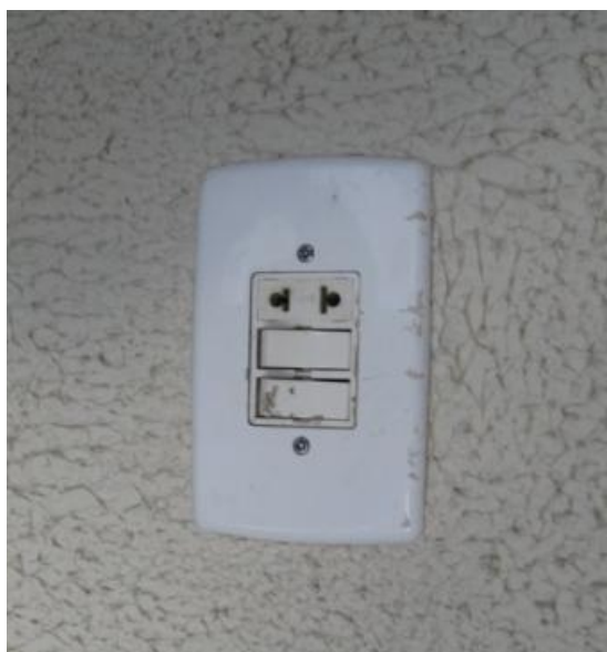
Figura 17 – Tomada sem aterramento
