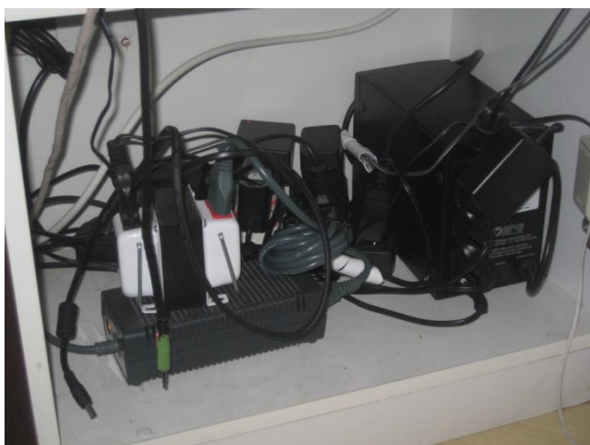
Figura 21 – Uso de régua de tomadas e transformador
