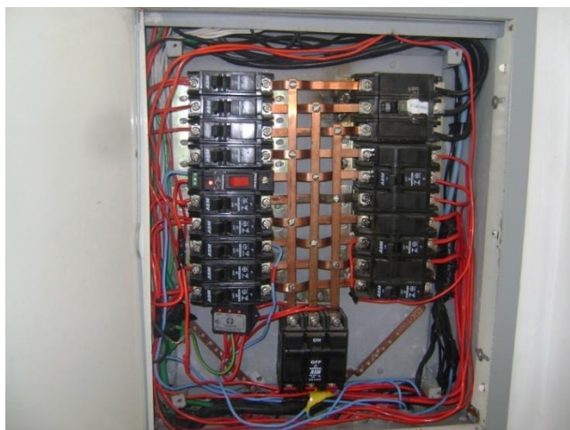
Figura 3 – Interior do quadro de distribuição na garagem
