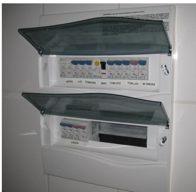
Figura 7 – Vista do quadro
