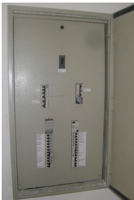
Figura 5 – Quadro de distribuição do condomínio
