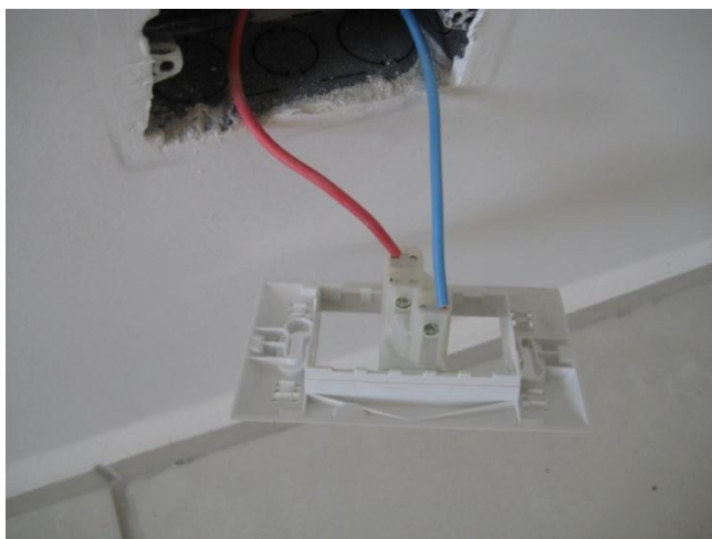
Figura 13 – Tomada sem aterramento
