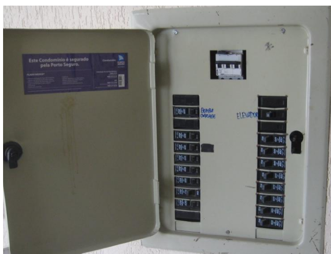
Figura 3 – Quadro de distribuição do condomínio
