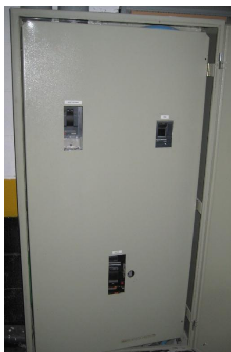
Figura 10 – Quadro Geral BT serviço
