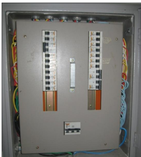
Figura 27 – Ausência de dispositivo de proteção DR e identificação dos circuitos Fonte: Os autores.
