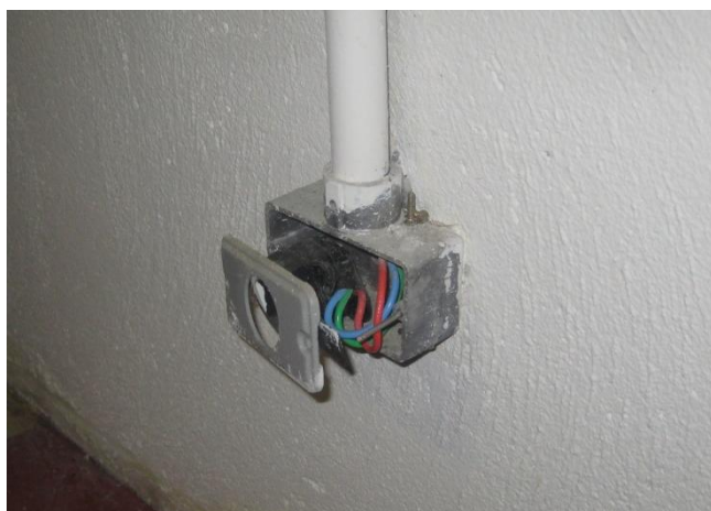
Figura 17 – Tomada da garagem
