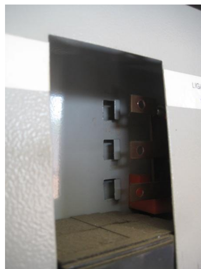
Figura 6 – Acesso a partes vivas
