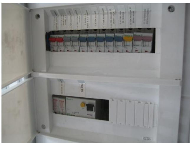
Figura 22 – Vista geral do quadro QT-AP1
