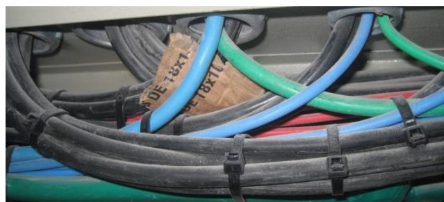
Figura 4 – Presença de material combustível
