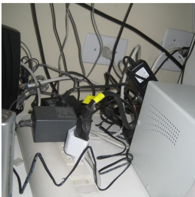
Figura 33 – Tomada na sala
