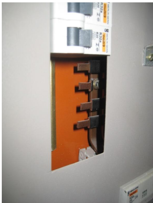
Figura 10 – Acesso a partes vivas
