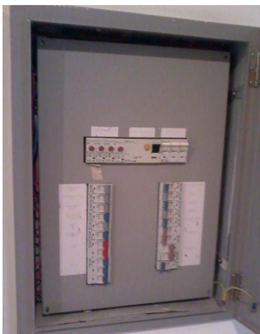
Figura 1 – Quadro de distribuição do condomínio
