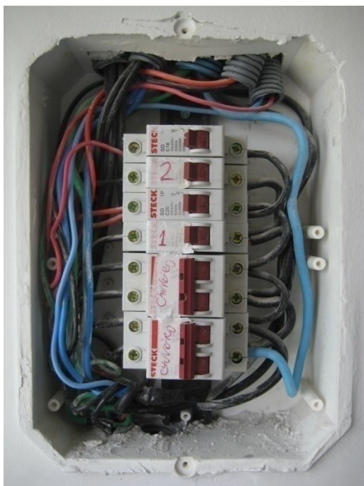
Figura 16 – Vista do quadro sem espelho
