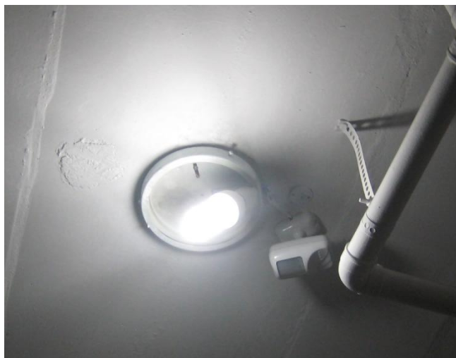
Figura 14 – Luminária com acesso as partes vivas
