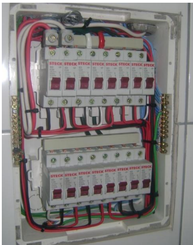
Figura 9 – Quadro de distribuição do apartamento sem espelho
