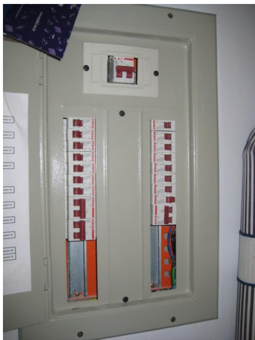
Figura 10 – Vista do quadro
