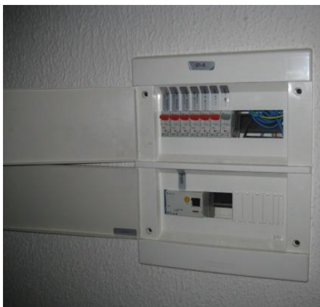
Figura 15 – Vista geral do quadro QT-S
