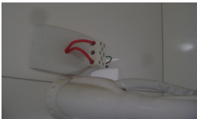
Figura 25 – Ausência do aterramento no chuveiro
