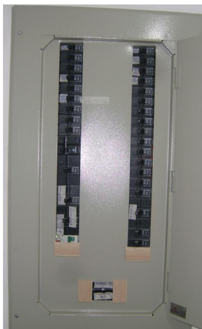
Figura 1 – Quadro de distribuição do condomínio
