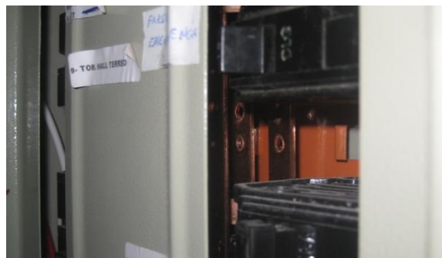
Figura 4 – Acesso ao barramento principal
