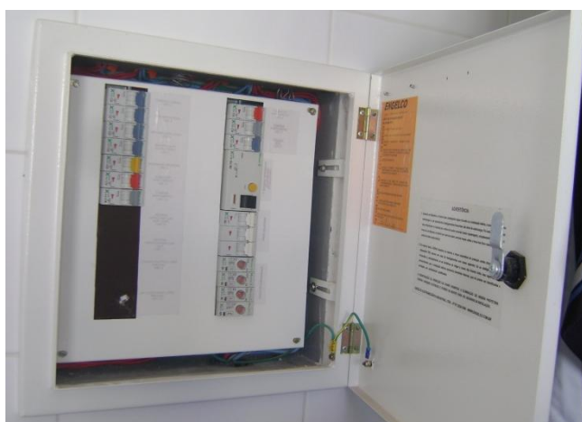
Figura 10 – Vista do quadro
