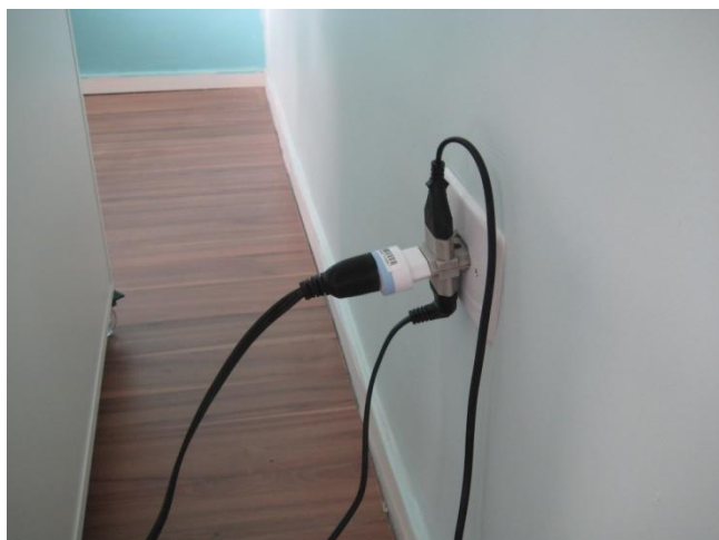
Figura 17 – Tomada em quarto
