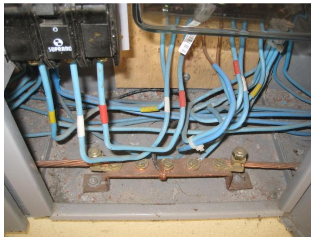
Figura 4 – Limpeza do quadro
