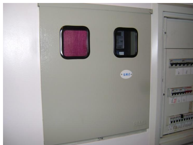
Figura 4 – Medidor do condomínio
