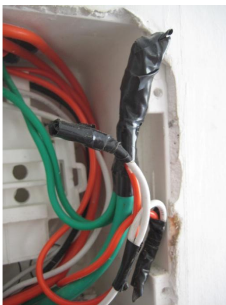
Figura 5 – Condutores terra emendados e condutores fase soltos
