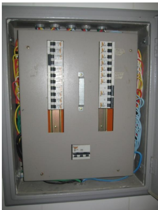
Figura 11 – Vista do quadro
