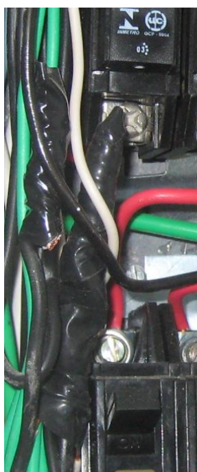
Figura 13 – Emenda entre condutores
