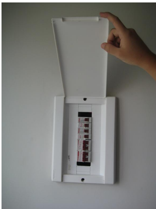
Figura 15 – Vista do quadro
