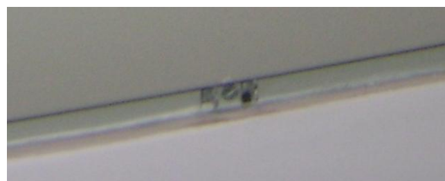
Figura 5 – Ausência de lacre
