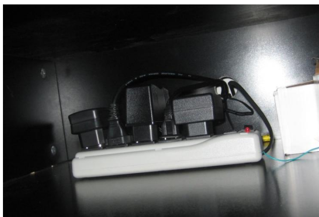
Figura 33 – Tomada na sala
