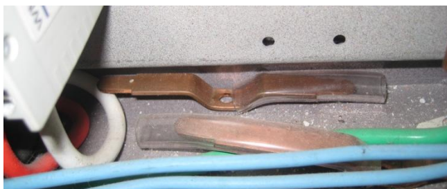
Figura 5 – Conexão de barramento inutilizada
