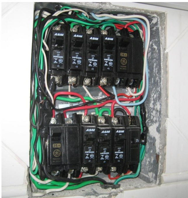
Figura 11 – Vista do quadro sem espelho
