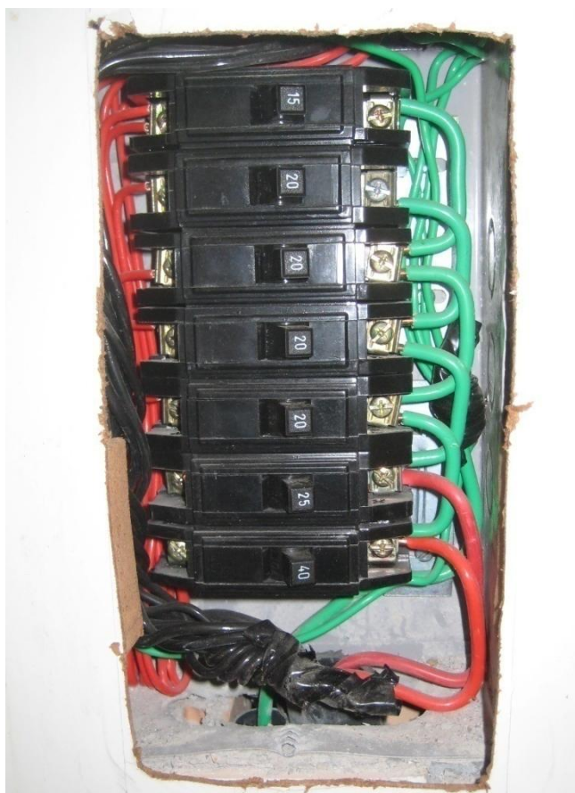
Figura 16 – Quadro de distribuição sem espelho
