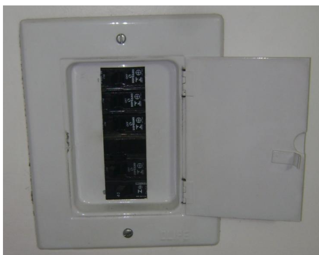
Figura 16 – Vista do quadro
