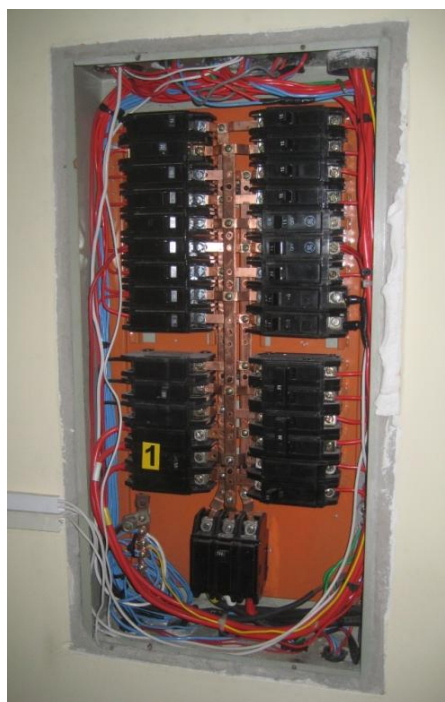
Figura 3 – Quadro de distribuição do condomínio sem espelho
