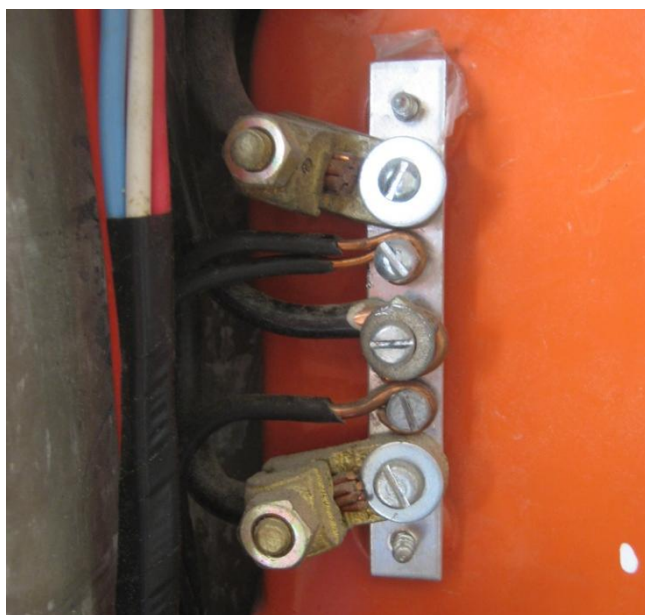
Figura 7 – Barra de conexão não identificada
