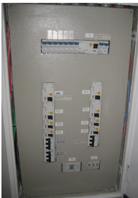
Figura 9 – Quadro de distribuição do condomínio (QD-02)
