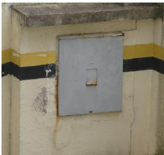
Figura 5 - Quadro da entrada de serviço
