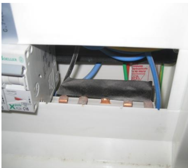
Figura 16 – Detalhe do quadro QT-S (acesso a partes vivas)
