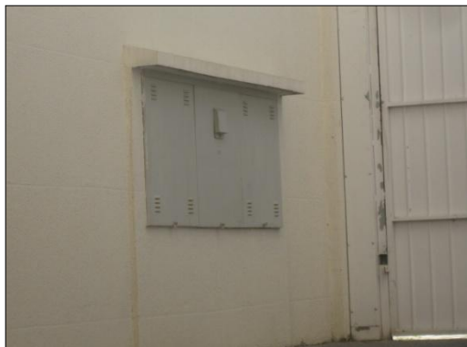
Figura 13 - Ausência de DPS Fonte: Os autores.
