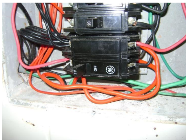
Figura 12 – Vista do quadro sem espelho
