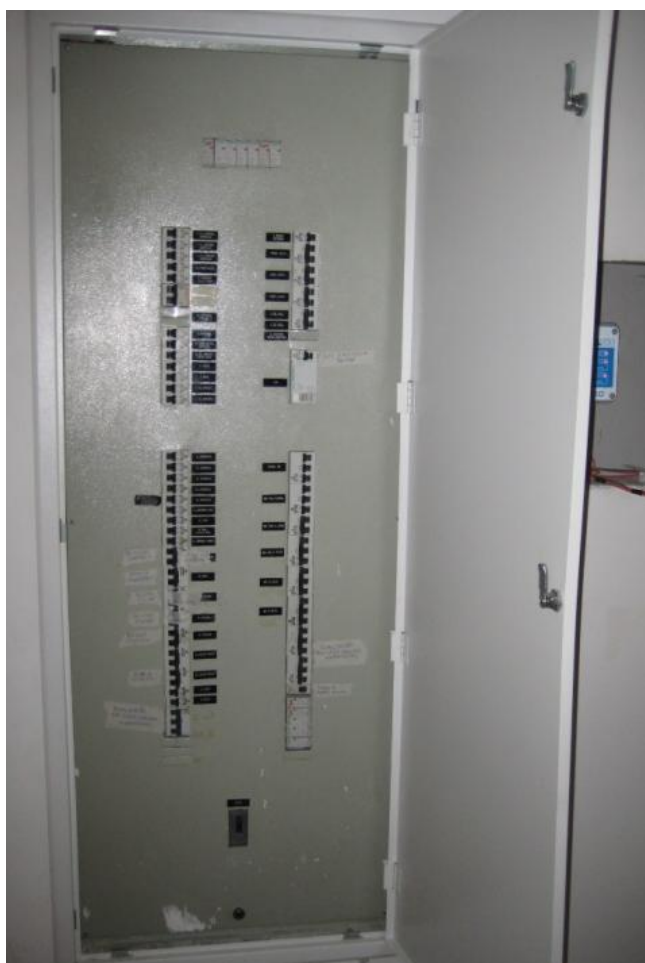
Figura 5 – Vista geral de um dos quadros de distribuição do condomínio
