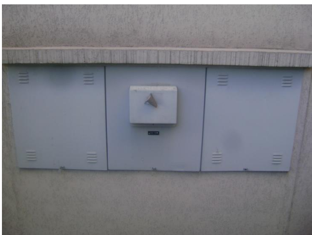
Figura 1 – Caixa geral de entrada
