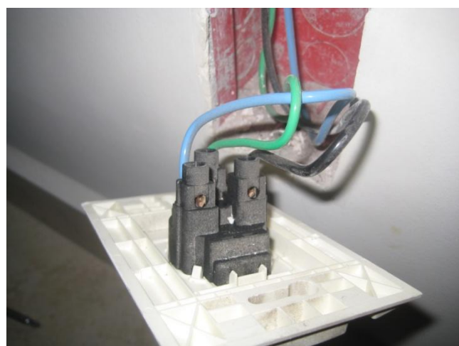
Figura 12 – Tomada com aterramento através de condutor 1,5 mm 2
