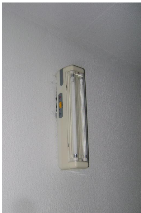
Figura 9 – Iluminação de emergência inoperante
