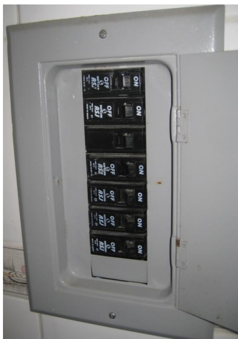
Figura 15 – Vista do quadro
