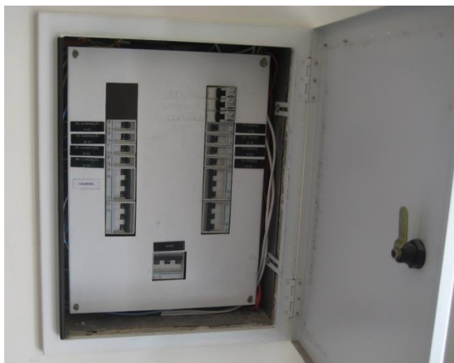
Figura 1 – Quadro de distribuição do condomínio
