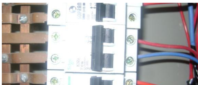
Figura 10 – Identificação de cores de condutor incorreta
