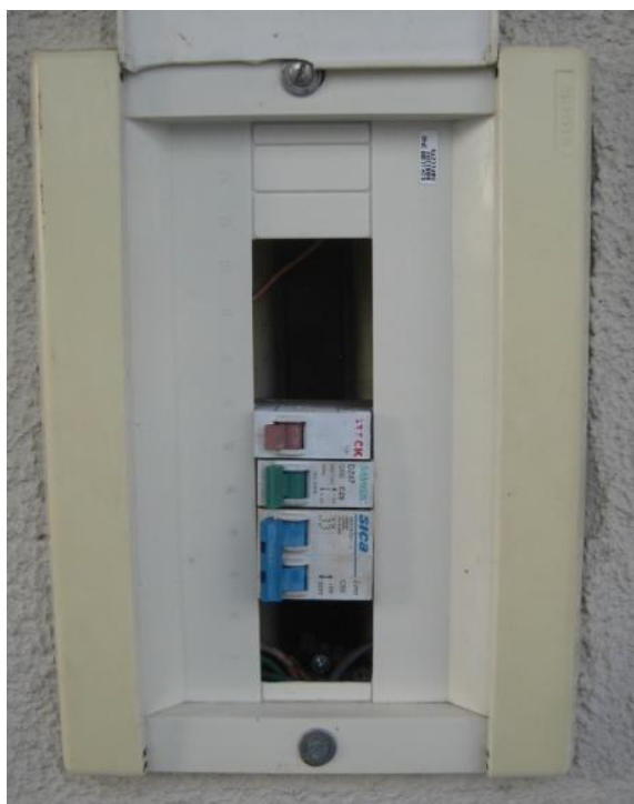
Figura 13 – Quadro de distribuição do salão de festas
