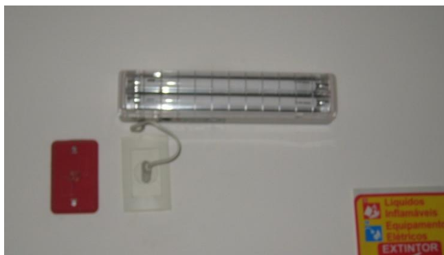
Figura 8 – Iluminação de emergência
