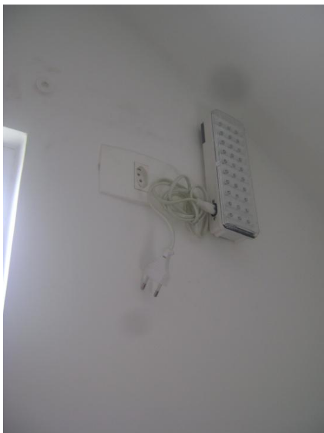
Figura 3 – Luminária de emergência inoperante na escadaria do térreo para o primeiro andar
