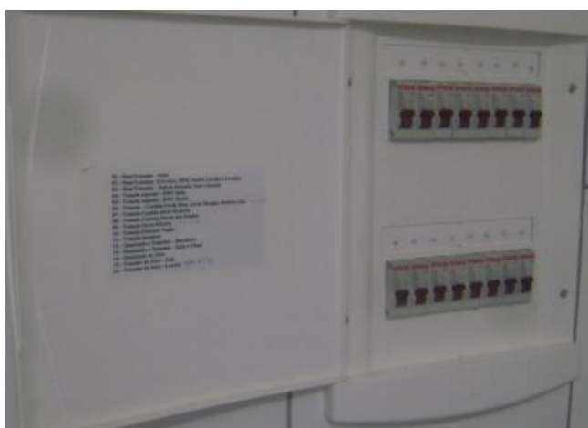
Figura 8 – Vista geral do quadro de distribuição do apartamento
