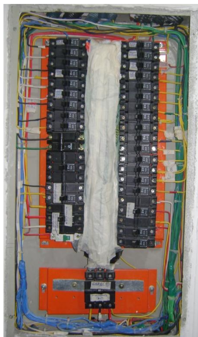
Figura 2 – Quadro de distribuição do condomínio sem espelho
