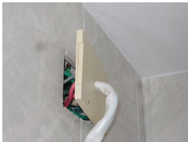
Figura 16 – Condutores do chuveiro elétrico
