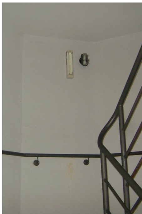
Figura 10 – Iluminação de emergência inoperante
