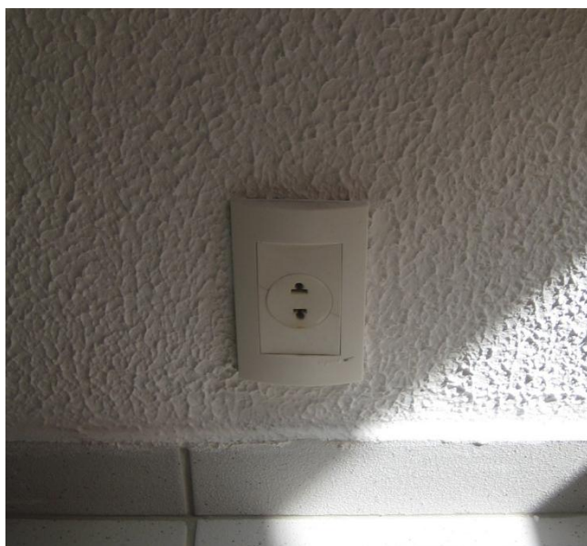
Figura 10 – Tomada sem aterramento
