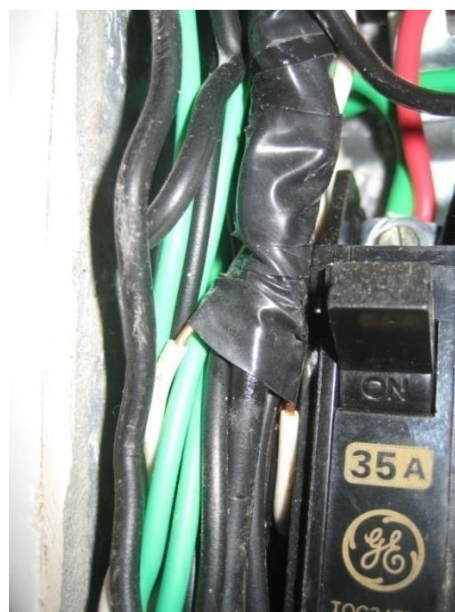
Figura 14 – Identificação por cores incorreta
