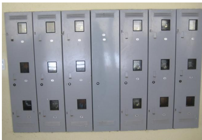
Figura 1 – Quadro de medição
