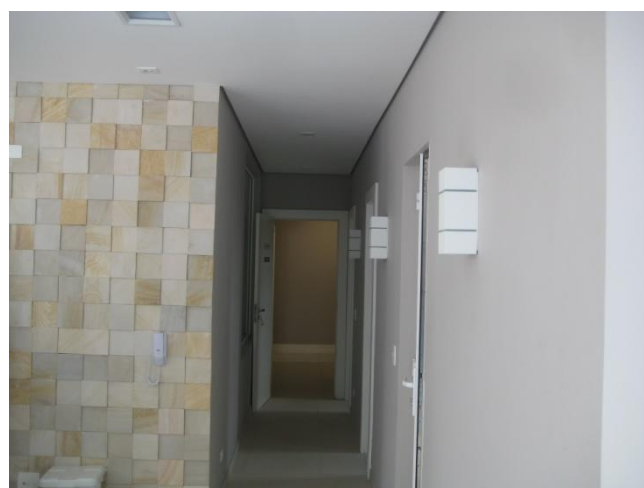
Figura 16 – Iluminação de emergência insuficiente
