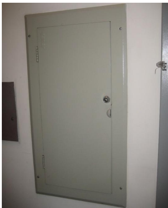
Figura 1 – Quadro de distribuição fechado
