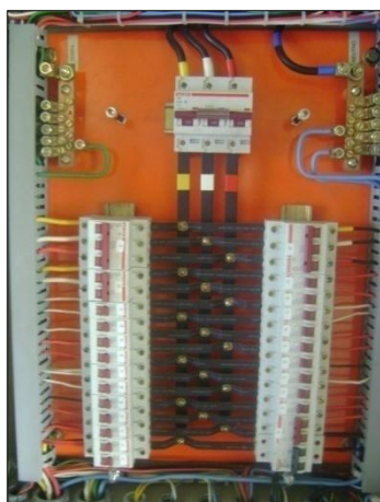
Figura 16 - Ausência de dispositivo DR Fonte: Os autores.
