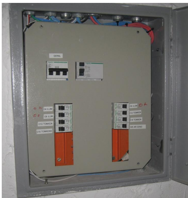
Figura 8 – Quadro de distribuição N2C
