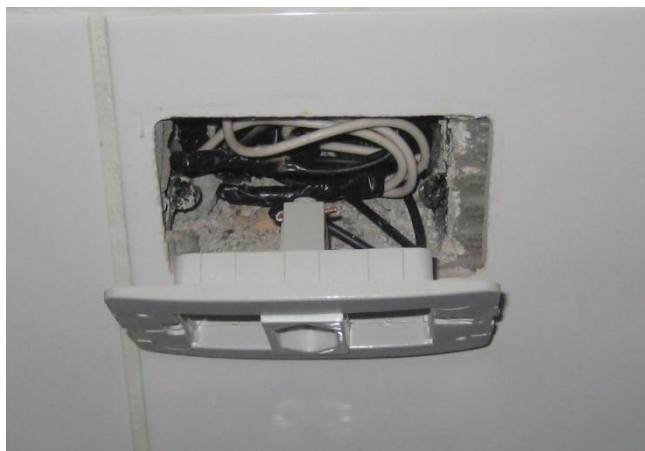
Figura 16 – Tomada na cozinha aberta
