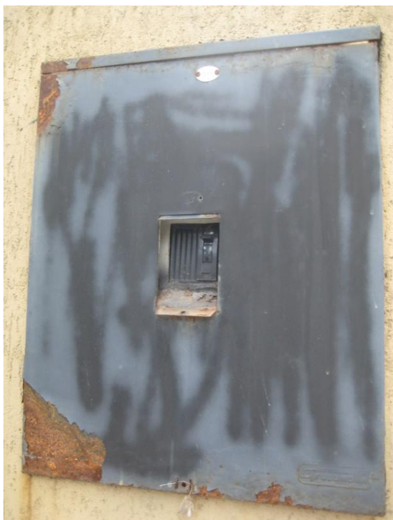
Figura 1 - Quadro da entrada de serviço
