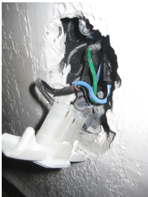
Figura 8 – Ausência de condutor terra em tomada
