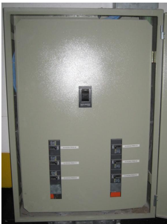
Figura 5 – Quadro Geral BT escadas
