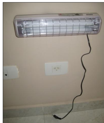
Figura 20 – Iluminação de emergência inoperante Fonte: Os autores.
