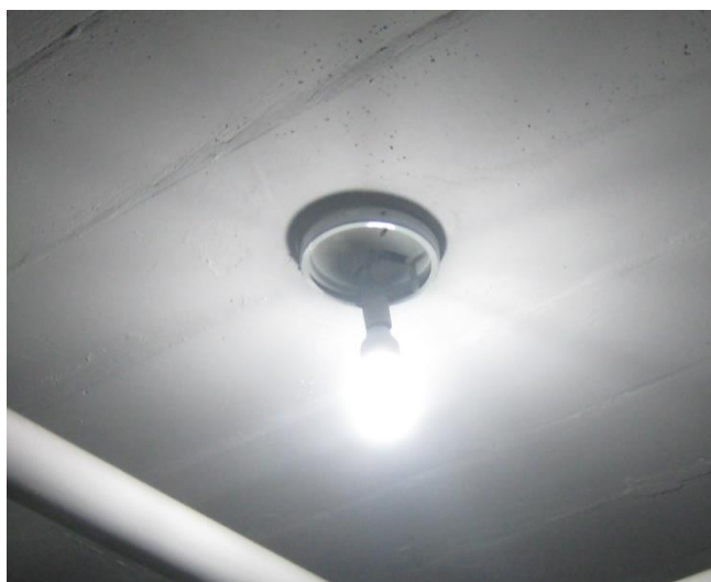
Figura 13 – Luminária com acesso as partes vivas
