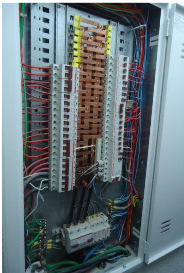
Figura 4 – Quadro do condomínio sem espelho
