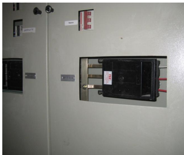
Figura 3 – Acesso às partes vivas no quadro
