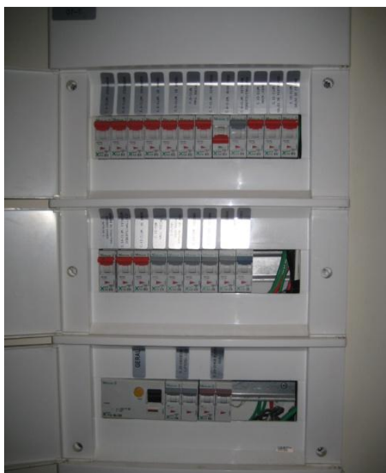
Figura 9 – Vista geral do quadro QT-T
