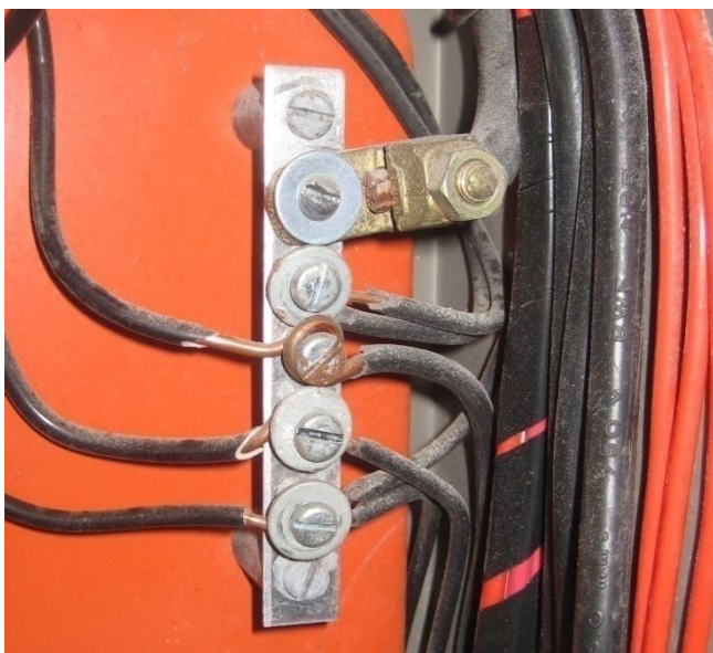
Figura 8 – Barra de conexão não identificada
