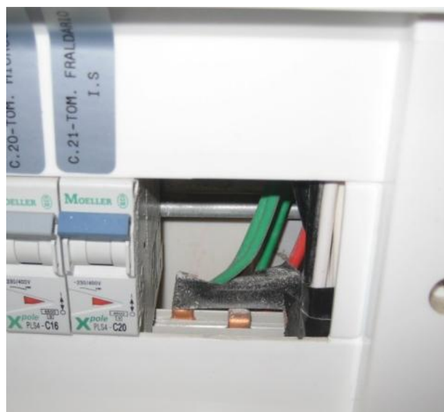
Figura 11 – Acesso a partes vivas
