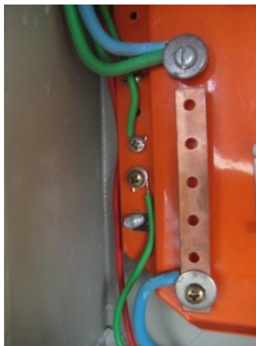
Figura 11 – Barra de aterramento ligada de forma inadequada
