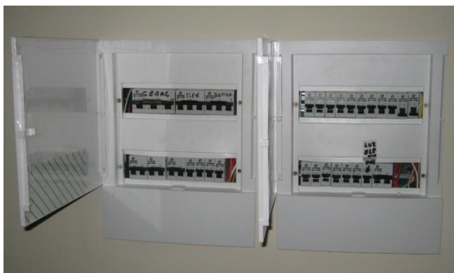
Figura 1 – Quadros de distribuição do condomínio
