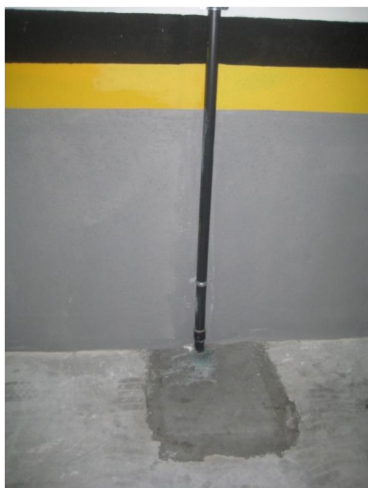
Figura 15 – Caixa de inspeção
