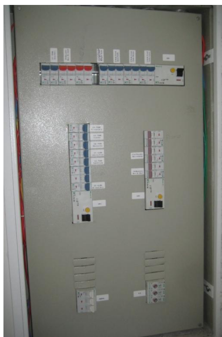
Figura 21 – Vista do quadro
