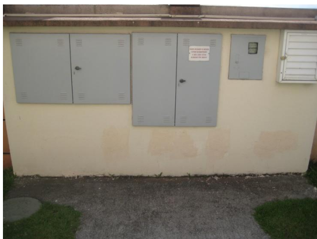
Figura 4 - Quadro da entrada de serviço
