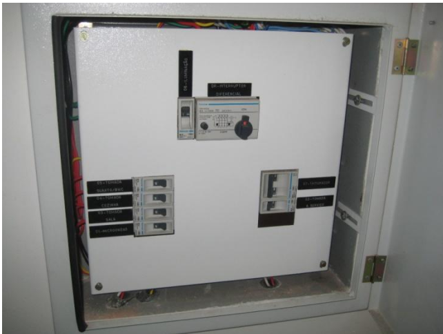
Figura 15 – Vista do quadro
