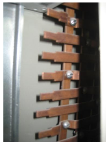
Figura 3 – Acesso a partes vivas – barramento
