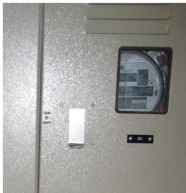
Figura 4 – Ausência do lacre COPEL
