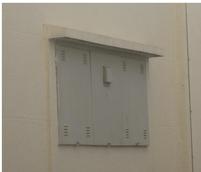
Figura 3 - Quadro da entrada de serviço
