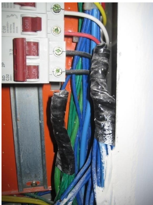
Figura 13 – Emenda entre condutores
