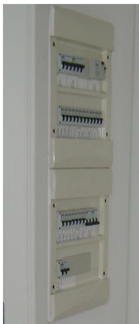
Figura 21 – Quadro de distribuição do apartamento
