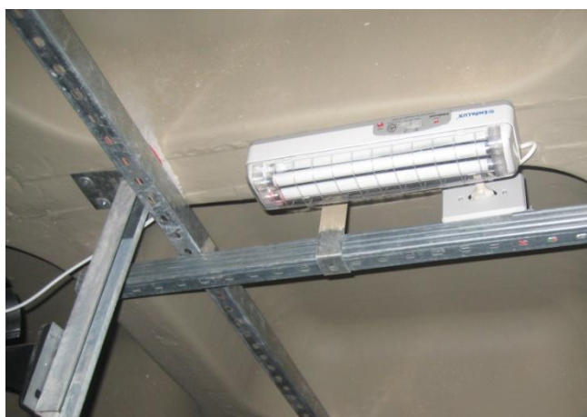
Figura 13 – Iluminação de emergência
