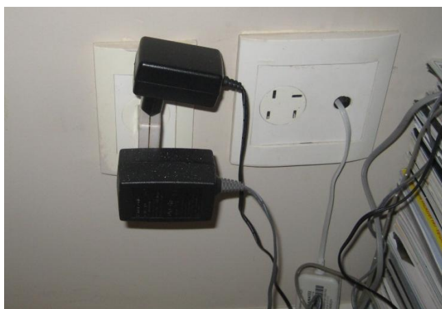
Figura 19 – Tomada na sala
