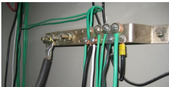
Figura 5 – Barra de aterramento
