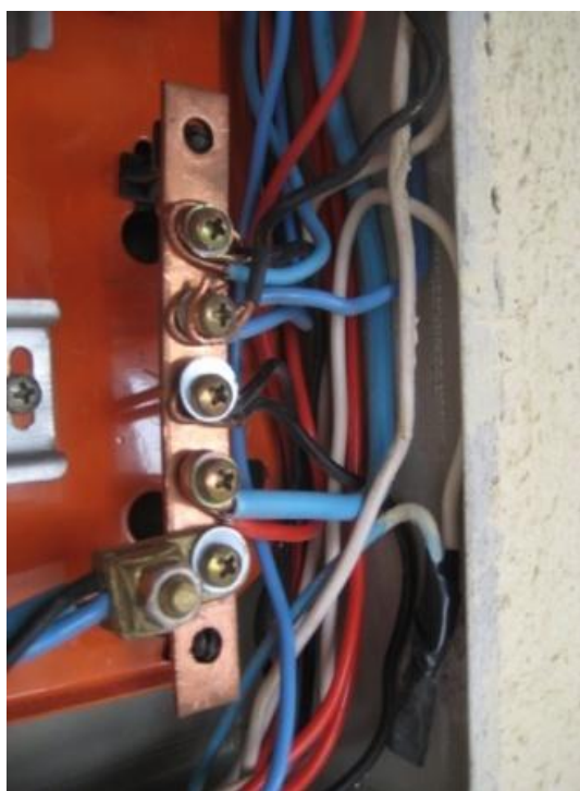
Figura 10 – Barra de neutro ligada de forma inadequada
