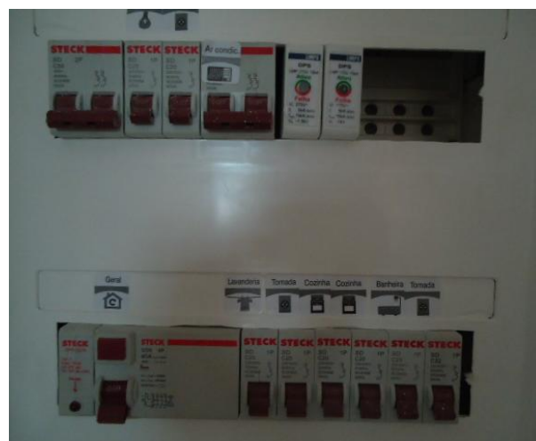
Figura 13 – Vista interna do quadro
