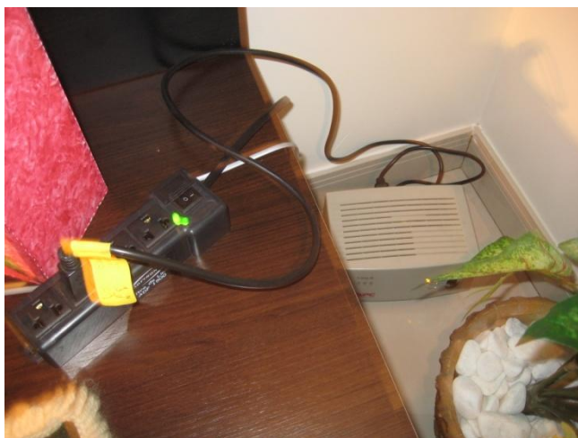
Figura 15 – Tomada na sala
