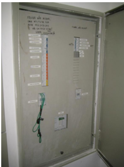
Figura 5 – Acesso a condutores
