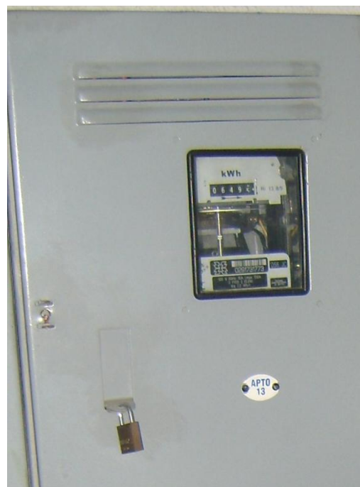
Figura 3 – Ausência do lacre COPEL
