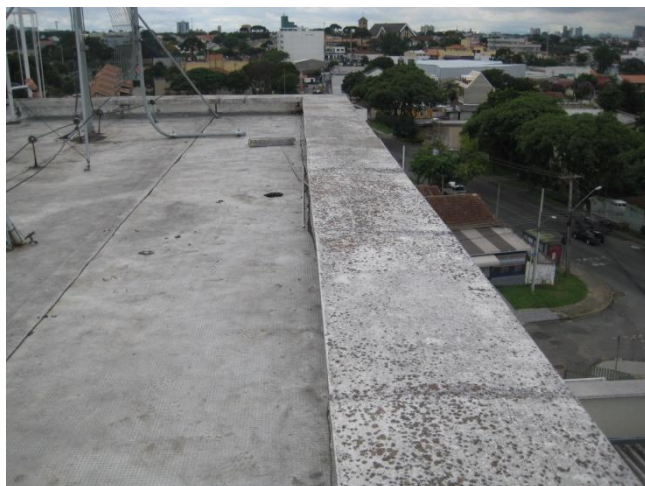
Figura 9 – Falta de proteção de borda para o SPDA
