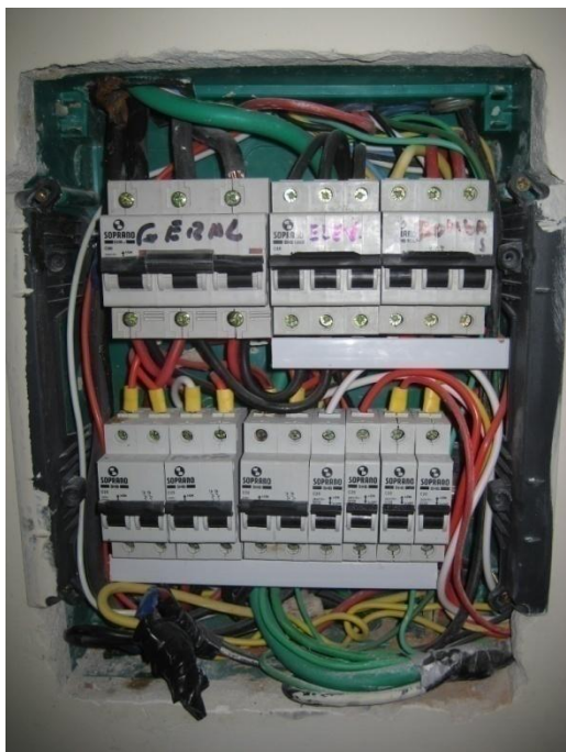
Figura 2 – Quadro de distribuição do condomínio sem espelho
