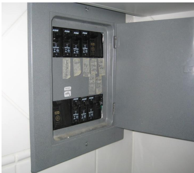
Figura 10 – Vista do quadro
