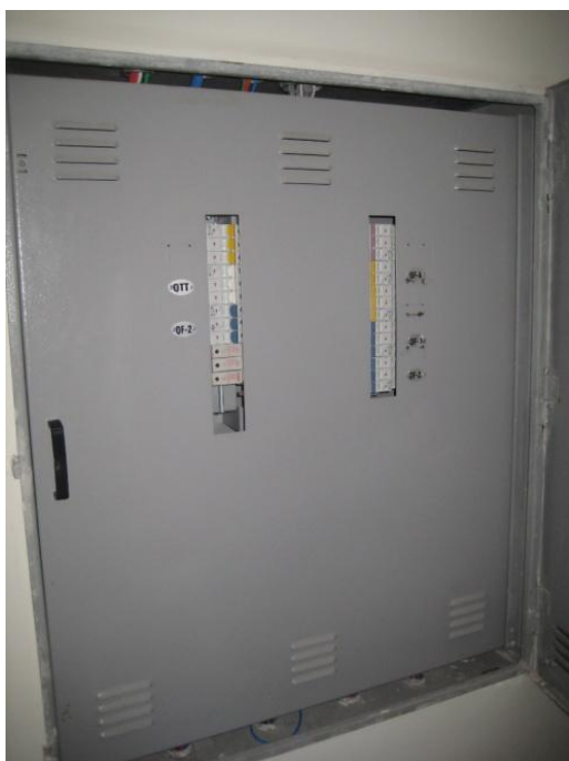
Figura 1 – Vista geral do quadro QD-C
