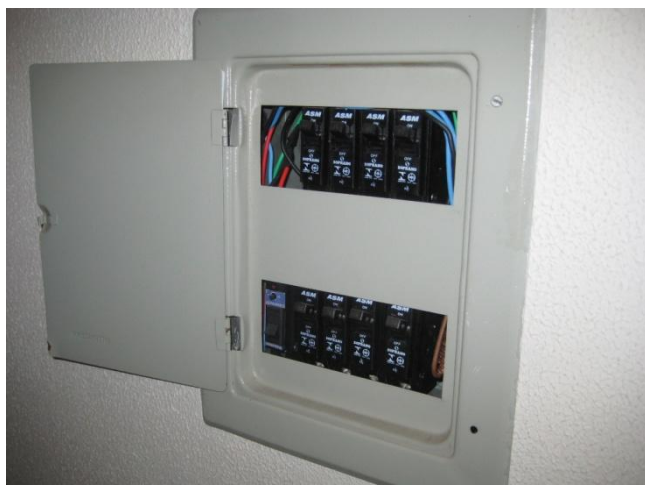
Figura 3 – Quadro de distribuição do condomínio
