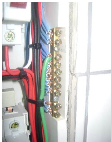
Figura 10 – Barra de neutro do quadro de distribuição do apartamento
