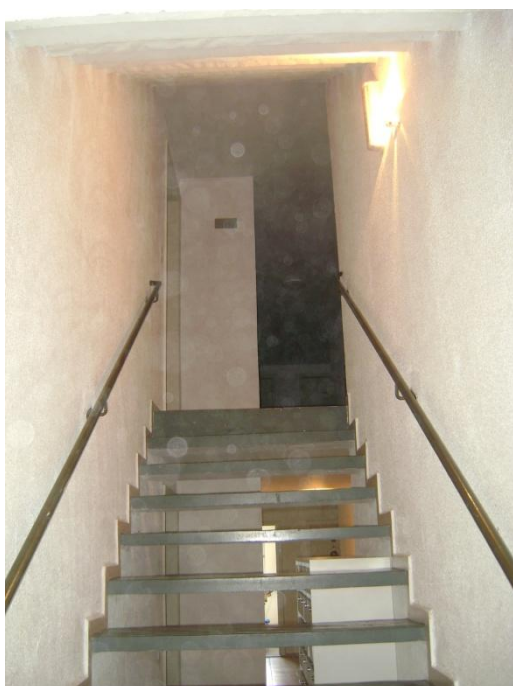
Figura 5 – Iluminação de emergência
