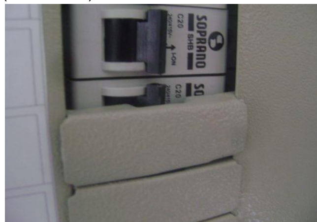
Figura 14 – Plaqueta impedindo atuação do disjuntor
