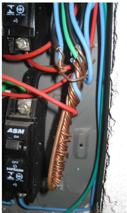
Figura 6 – Emenda entre condutores
