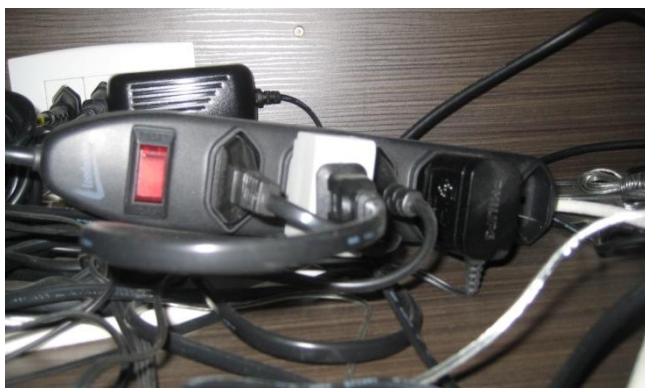
Figura 17 – Tomada na sala
