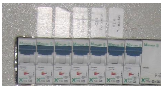
Figura 11 – Dispositivos de proteção sem identificação
