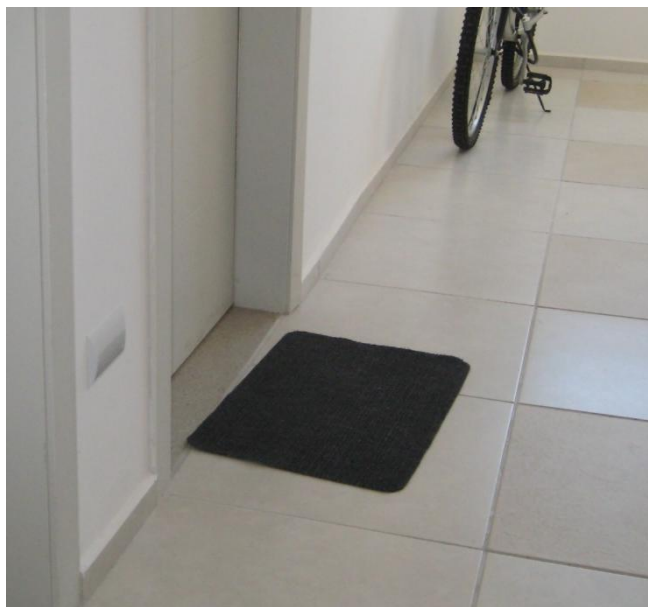
Figura 8 – Falta de tomada no corredor
