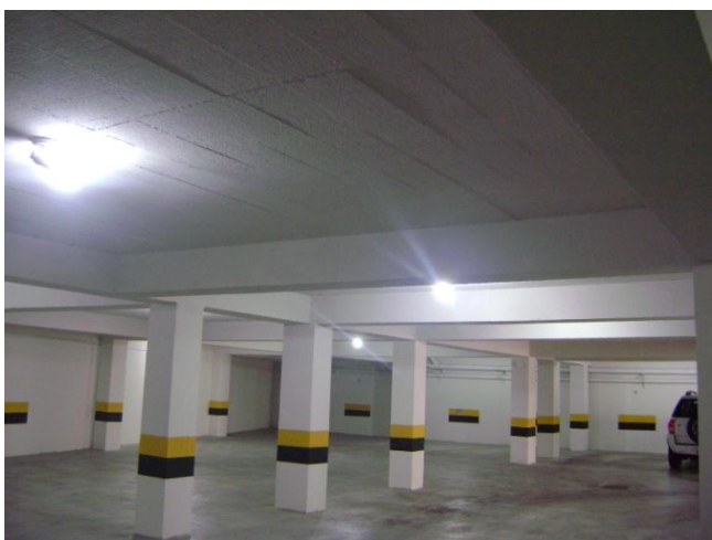
Figura 9 – Iluminação de emergência insuficiente
