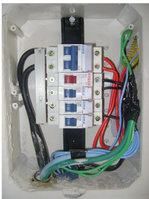
Figura 12 – Vista do quadro sem espelho
