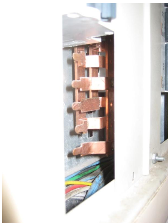
Figura 3 – Acesso a partes vivas
