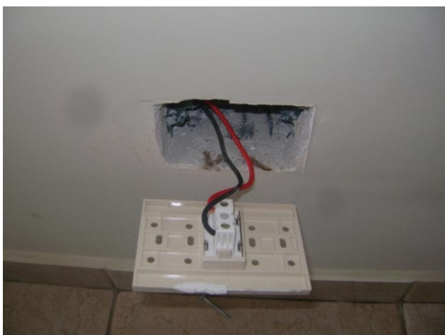
Figura 8 – Tomada sem condutor de proteção
