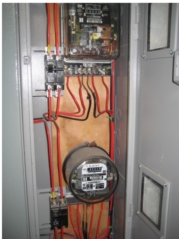
Figura 3 – Quadro de medição sem lacre da concessionária
