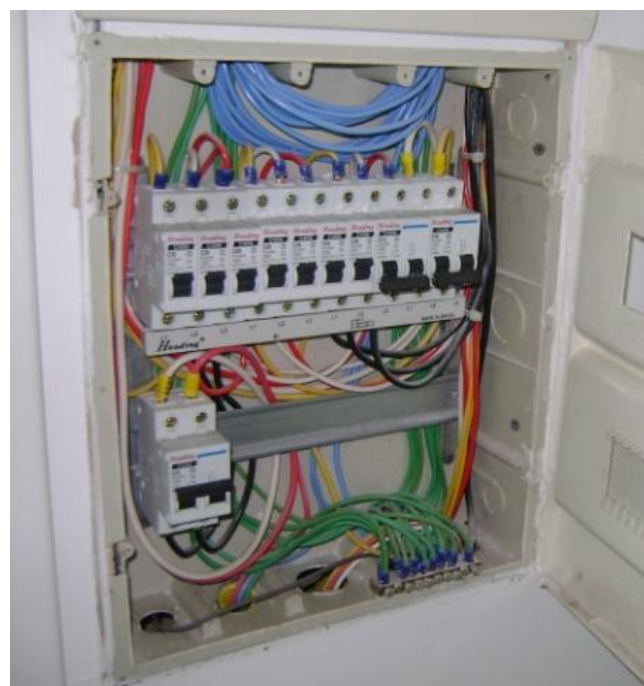
Figura 23 – Quadro de distribuição do apartamento sem espelho
