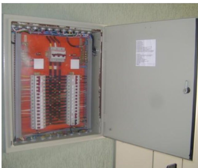
Figura 1 – Vista geral do quadro de distribuição do condomínio
