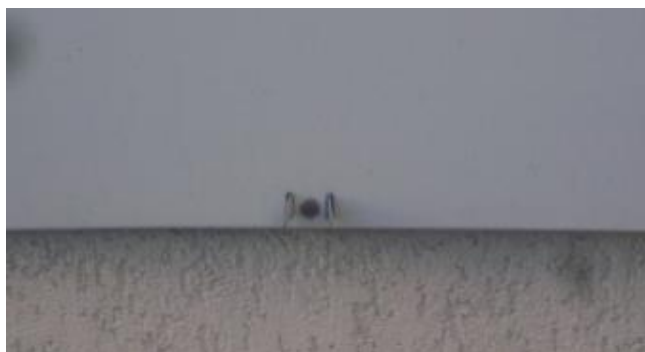
Figura 2 – Ausência do lacre COPEL
