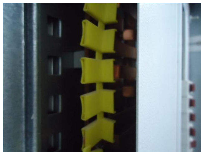
Figura 3 – Acesso a partes vivas – barramento
