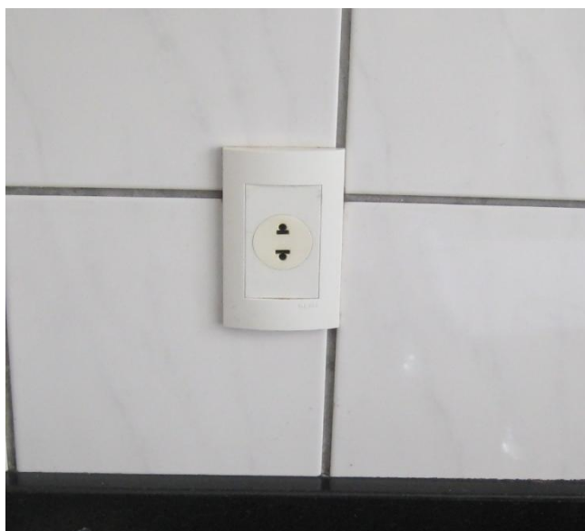
Figura 18 – Tomada sem aterramento
