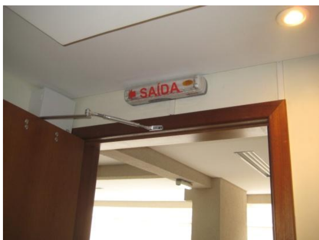
Figura 19 – Luminária de emergência inoperante no térreo (porta de saída para garagem)
