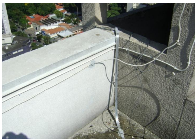
Figura 17 - Proteção de borda insuficiente
