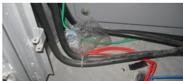
Figura 3 – Presença de material combustível no interior do quadro
