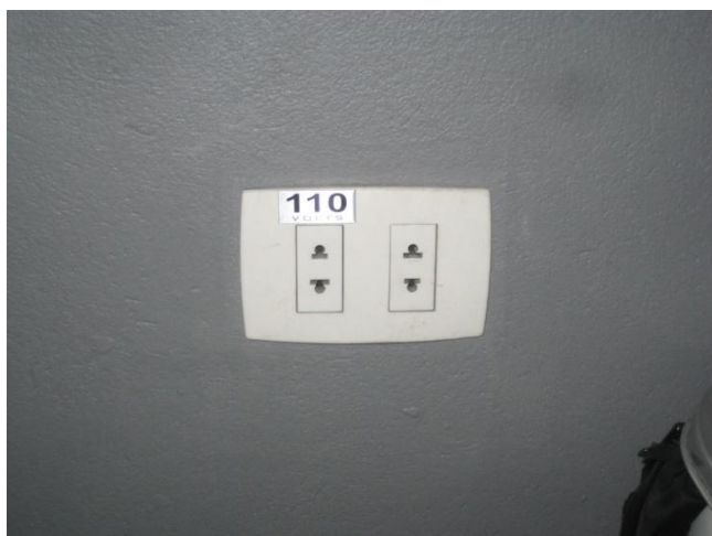
Figura 9 – Tomada da garagem
