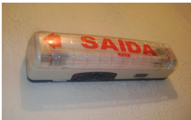
Figura 16 – Iluminação de emergência
