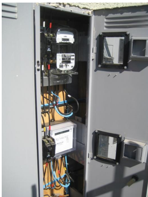
Figura 2 – Quadro de medição sem lacre da concessionária
