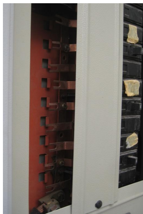
Figura 6 – Acesso ao barramento principal
