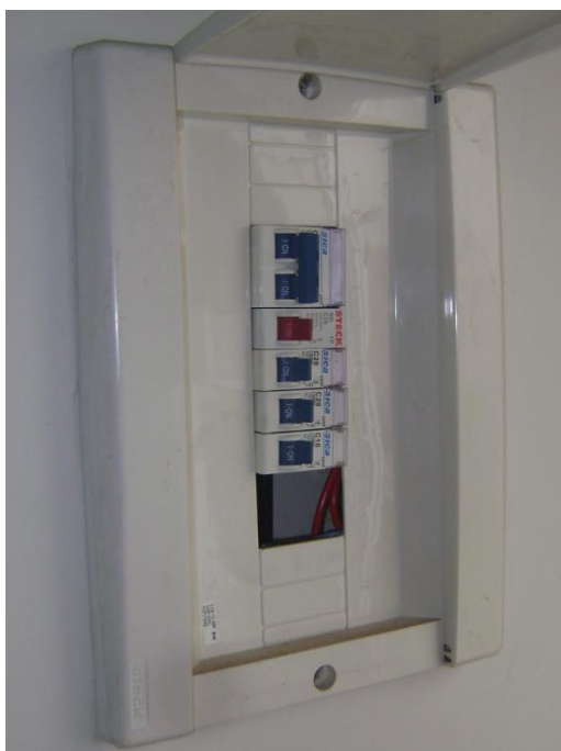
Figura 11 – Vista do quadro
