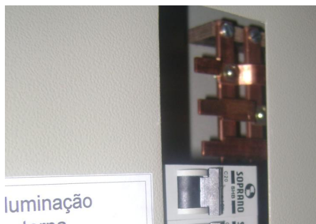
Figura 15 – Acesso a partes vivas
