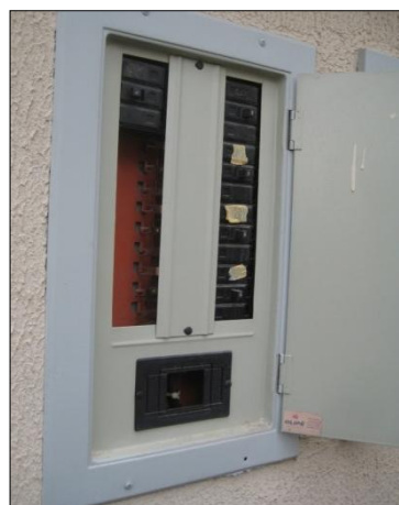
Figura 17 – Quadro com acesso as partes vivas, sem identificação dos circuitos e sem disjuntor geral Fonte: Os autores.
