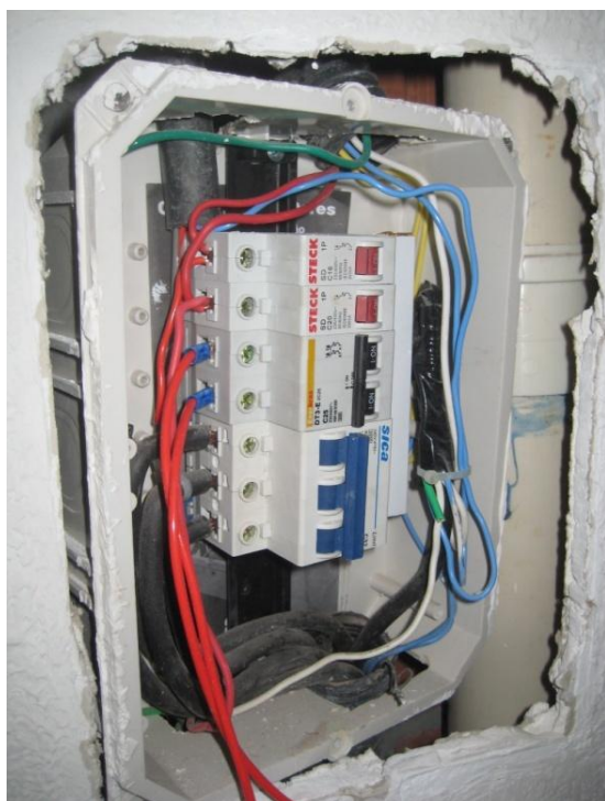
Figura 11 – Quadro de distribuição sem espelho
