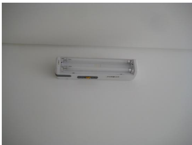
Figura 12 – Luminária de emergência inoperante no corredor
