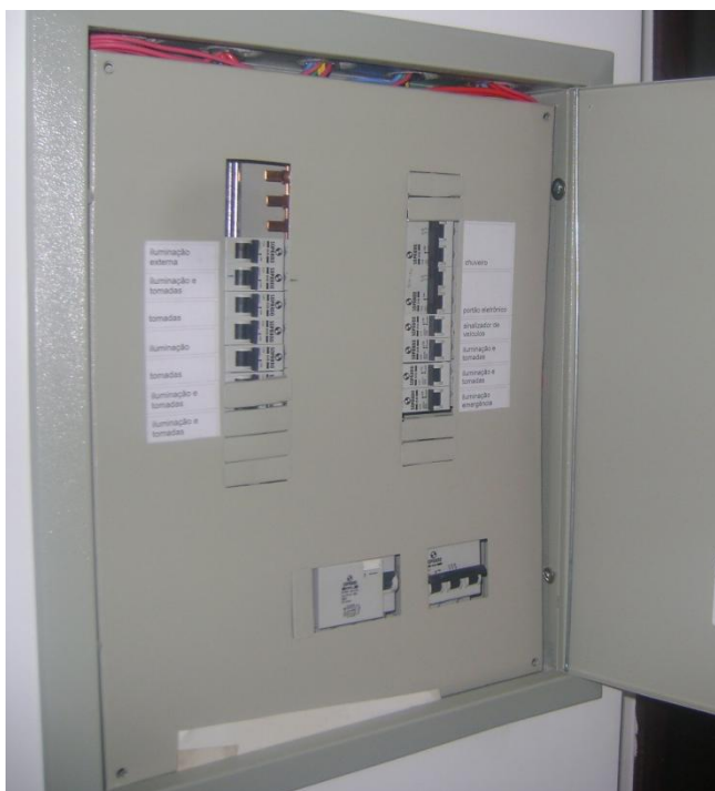
Figura 12 – Quadro de distribuição do salão de festas
