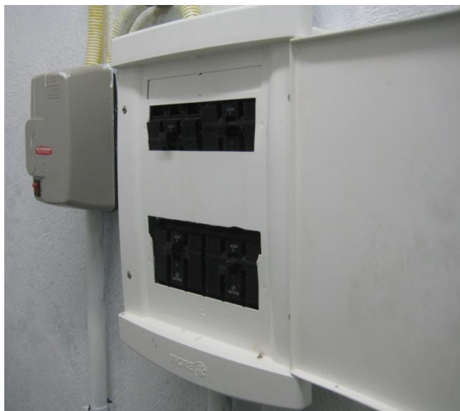
Figura 5 – Quadro de bombas
