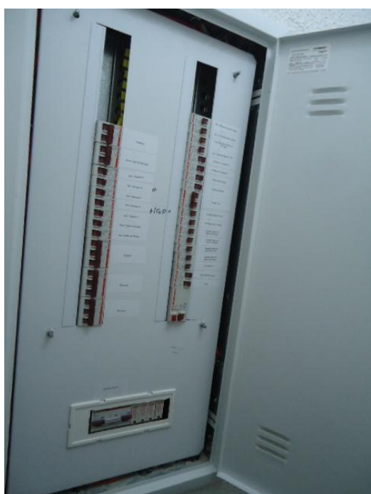
Figura 2 – Visão do quadro do condomínio
