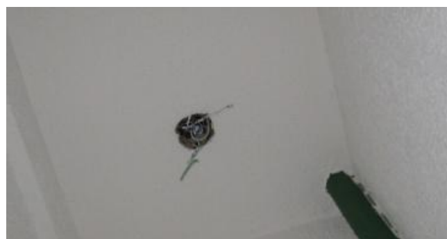
Figura 20 – Ponto de iluminação, sem luminária
