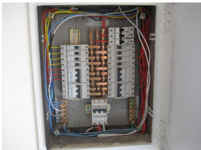
Figura 2 – Quadro de distribuição do condomínio sem espelho
