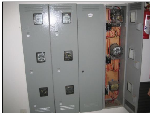
Figura 14 - Quadro de medição sem lacres Fonte: Os autores.
