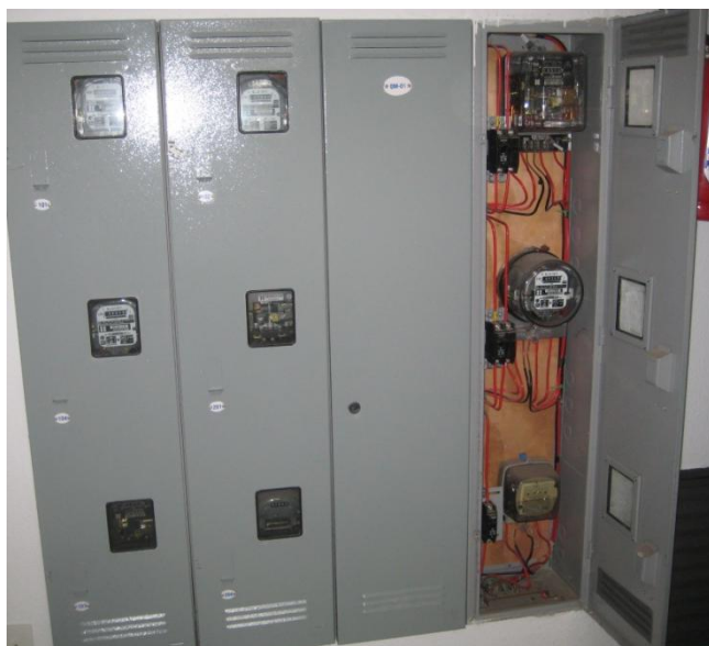
Figura 2 – Vista geral do quadro de medição
