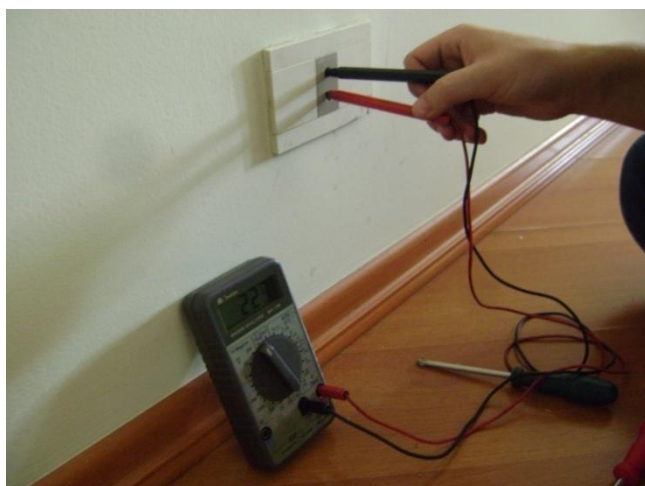
Figura 14 – Tomada na sala sem aterramento
