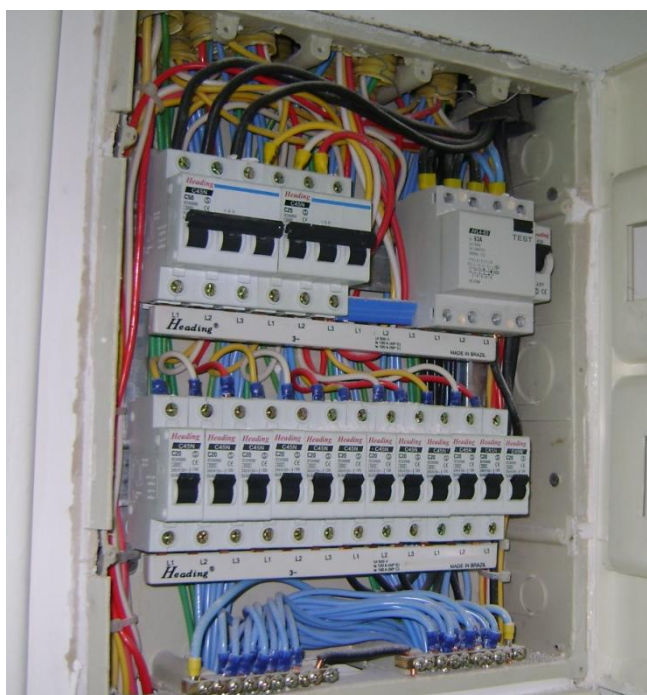
Figura 22 – Quadro de distribuição do apartamento sem espelho
