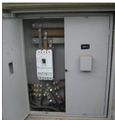
Figura 15 - Entrada de energia sem lacre Fonte: Os autores.
