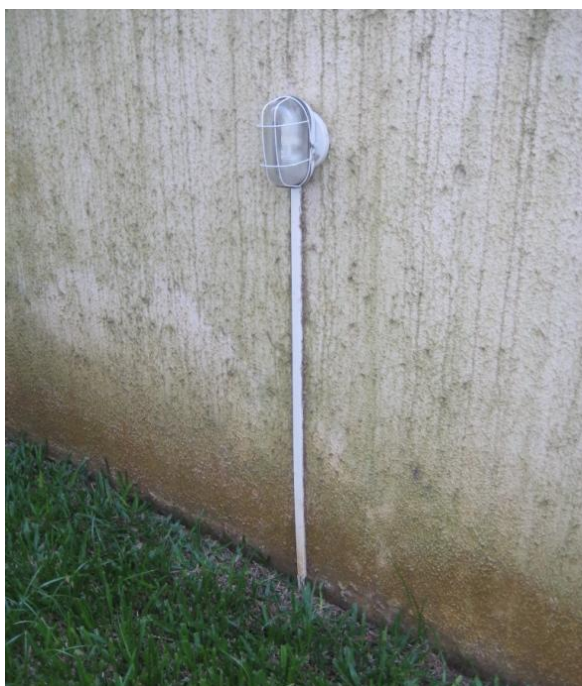
Figura 22 – Luminária de área comum
