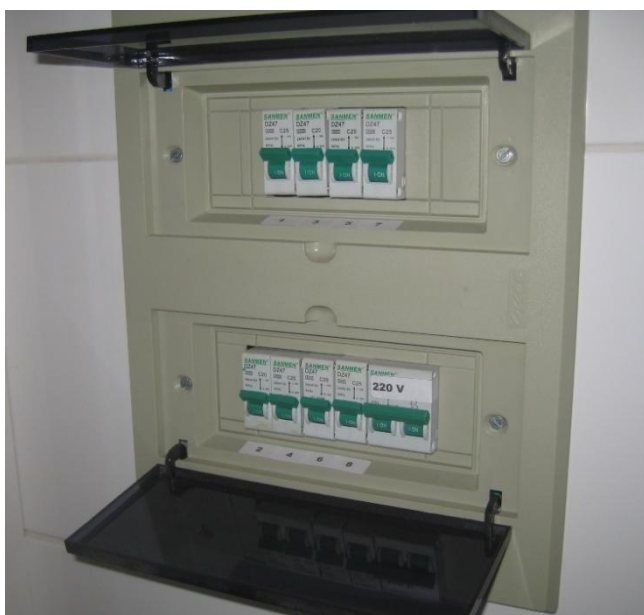
Figura 16 – Vista do quadro
