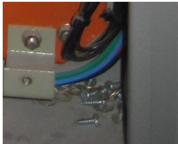
Figura 15 – Presença de dispositivos estranhos a instalação
