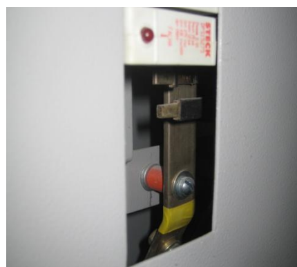
Figura 4 – Quadro QD-C (acesso a partes vivas)
