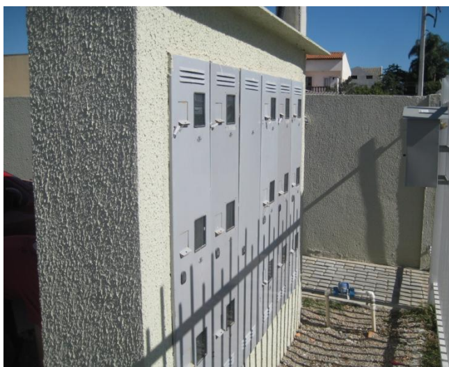
Figura 1 – Vista geral do quadro de medição
