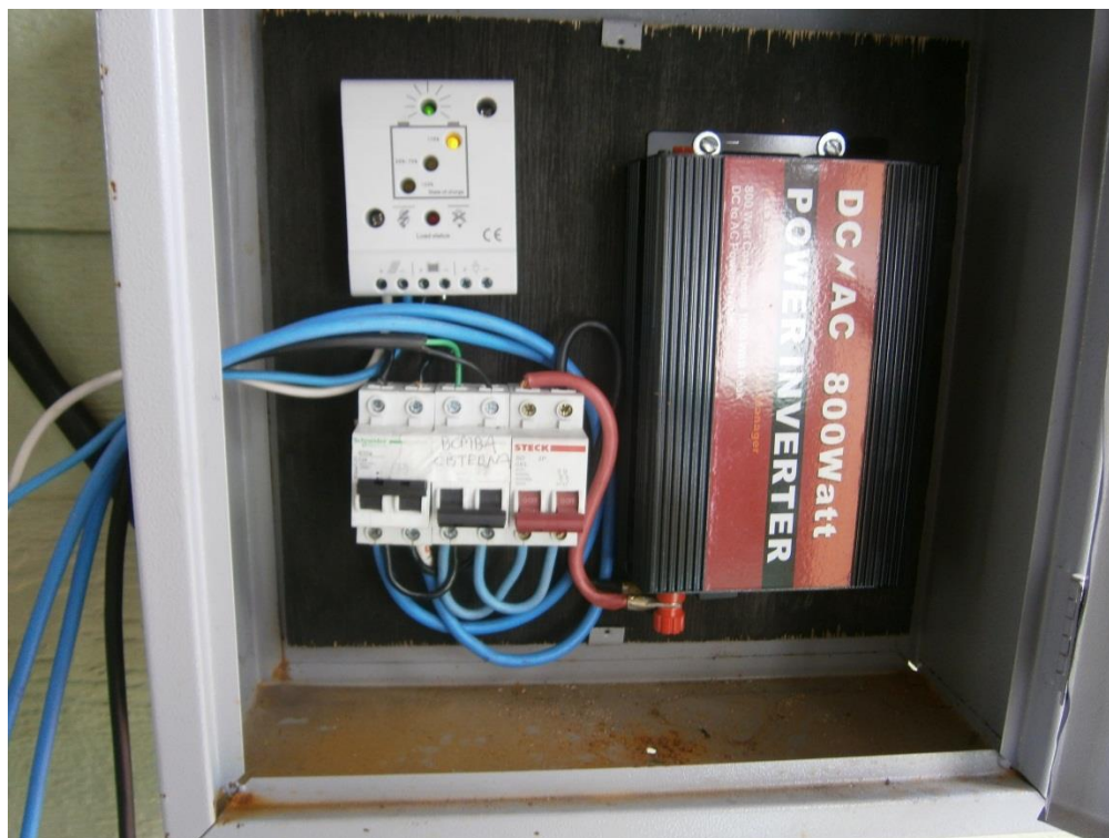
Figura 94 - Disjuntor que aciona a moto bomba
