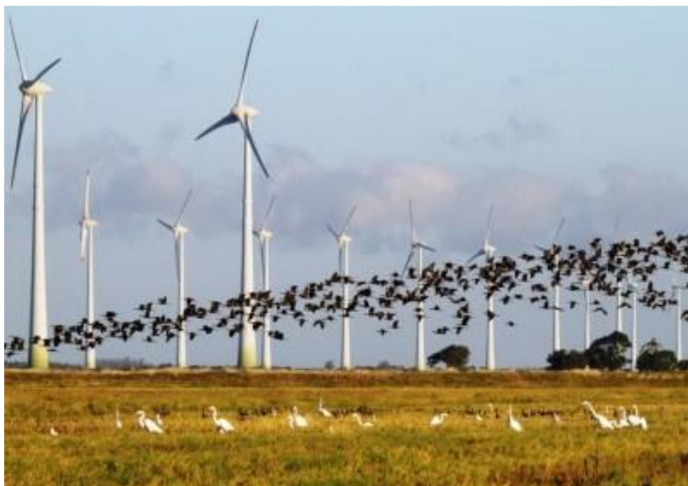
Figura 66 - Usina Eólica Sangradouro – Osório/RS
