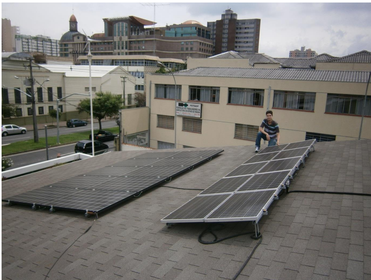
Figura 83 - Sistema fotovoltaico isolado do EV
