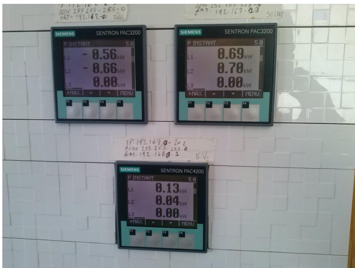
Figura 104 - Medidores de energia do EV
