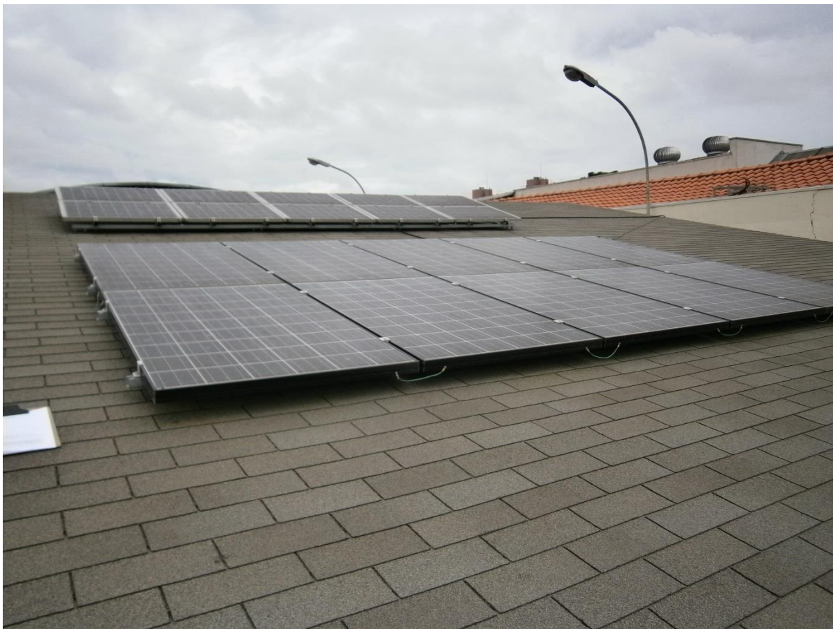
Figura 102 - Módulos fotovoltaicos do EV
