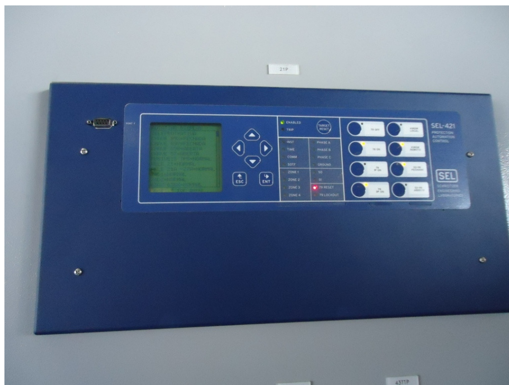
Figura 19 - Relé SEL-421 em operação na subestação Uberaba
