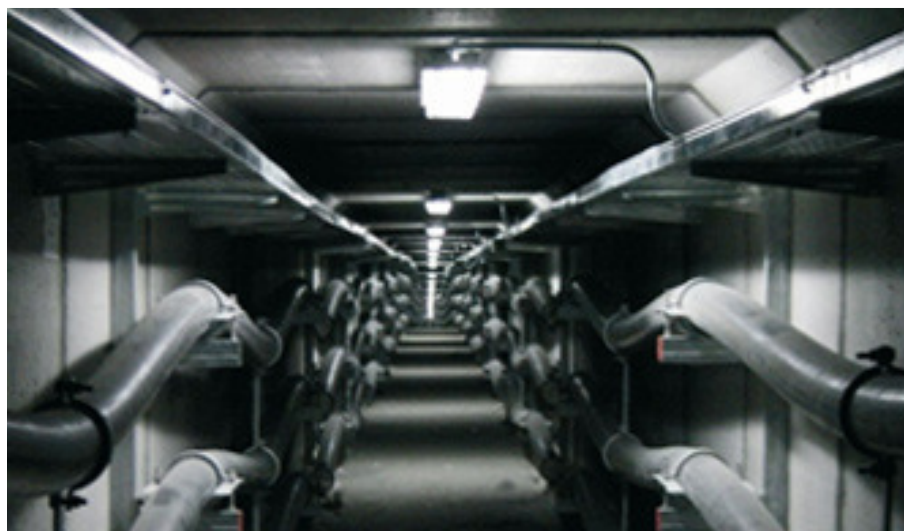
Figura 3 – Instalações elétricas de eletrodutos e eletrocalhas aparentes
