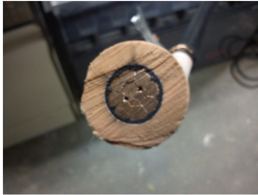
Figura 56 - Extremidade do cabo isolada
